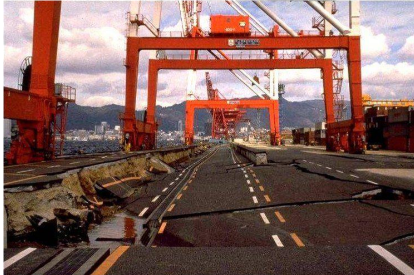
Εικόνα 3.12: Καταστροφή λιμένα στο Kobe
