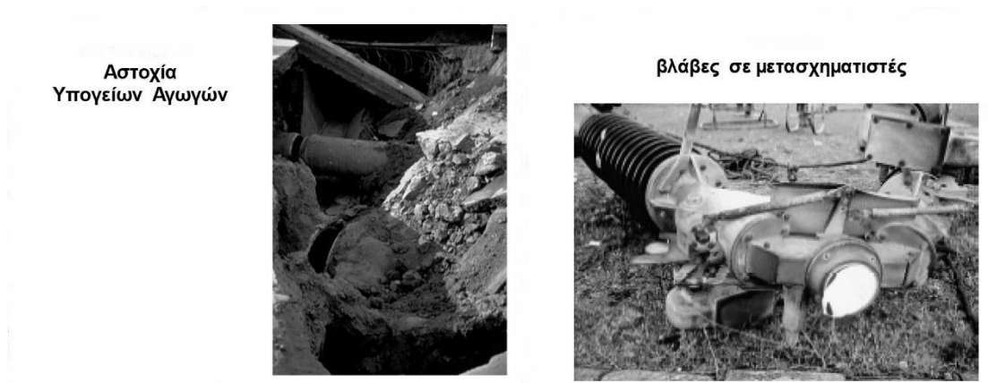
Εικόνα 2.6: Βλάβες σε δίκτυα κοινής ωφέλειας
