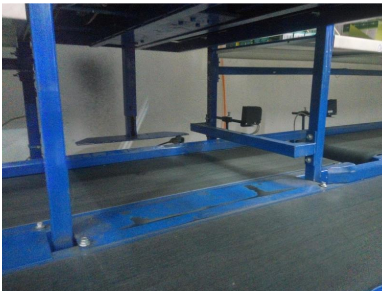
Σχήμα 6-26: Διαμόρφωση Ιμάντα – Stop Point
