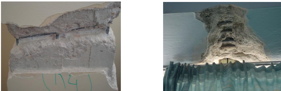
Εικόνα 8. Αποκάλυψη Οπλισμού στο υποστυλώμα K5 και στην δοκό Δ7 του ισογείου
