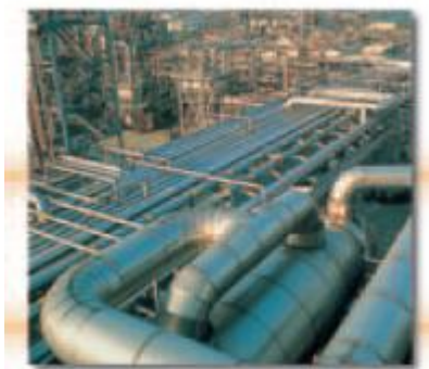
Σχήμα 1.4-1: Θέρμανση σωληνώσεων: Από μεγάλου μήκους, ευθείες γραμμές μεταφοράς μέχρι πολύπλοκες σωληνώσεις επεξεργασίας υγρών μέσων.
