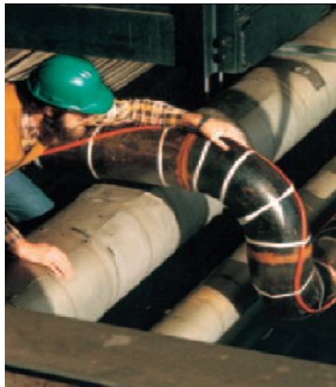
Σχήμα 1.4-5 : Τοποθέτηση θερμικών καλωδίων για αξιόπιστη διατήρηση της θερμοκρασίας σε αγωγούς μεταφοράς πετρελαίου.
