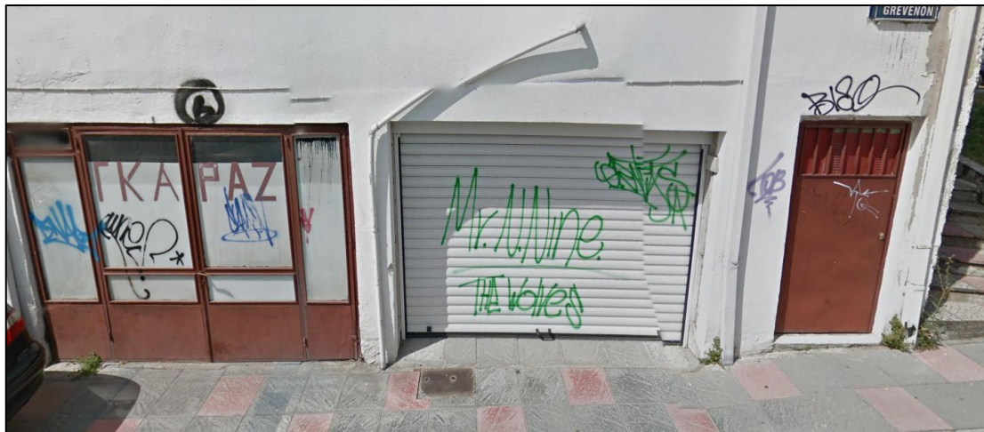
Εικόνα 4.1.8: Απεριποίητη όψη σε κτίριο στην περιοχή μελέτης ( https://www.google.gr/maps )
