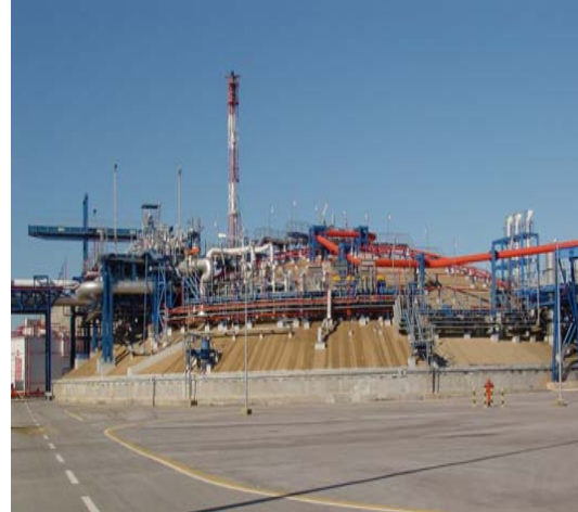
Figure 10 : Άποψη δεξαμενής στη Ρεβυθούσα
