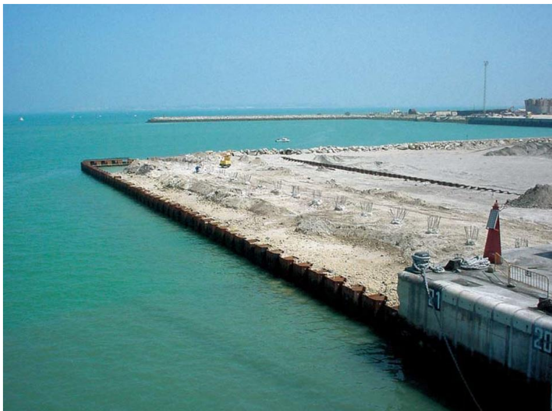
Εικόνα 2-9. Κρηπιδότοιχος από μεταλλικές πασσαλοσανίδες και τοποθέτηση αδρανών υλικών πίσω από αυτόν (ArcelorMittal, 7/2017)
