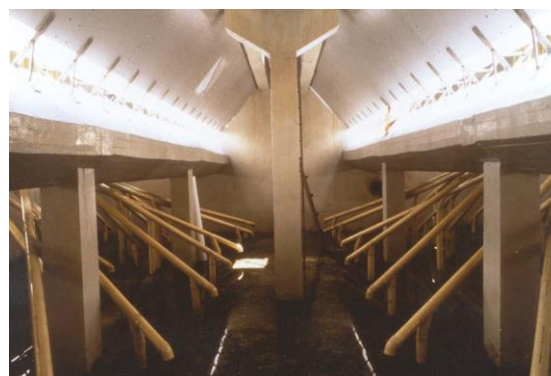
Σχήμα 2.3: Εσωτερικό αντιδραστήρα UASB, Cali Colombia. Προέλευση: Van Lier, 2012
