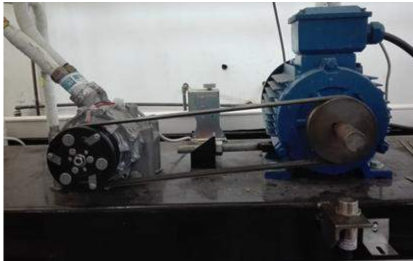
Εικόνα 2.15 Σύστημα εκτονωτή – γεννήτριας
