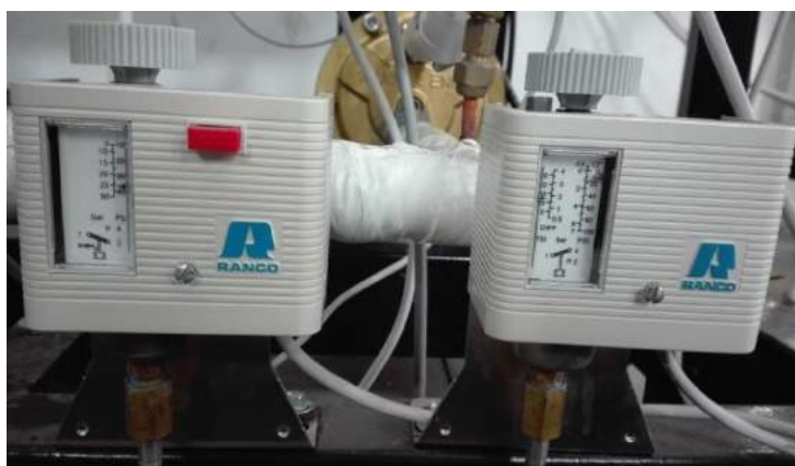
Εικόνα 2.27 Αισθητήρες υπερπίεσης (αριστερά) και υποπίεσης (δεξιά) της εγκατάστασης
