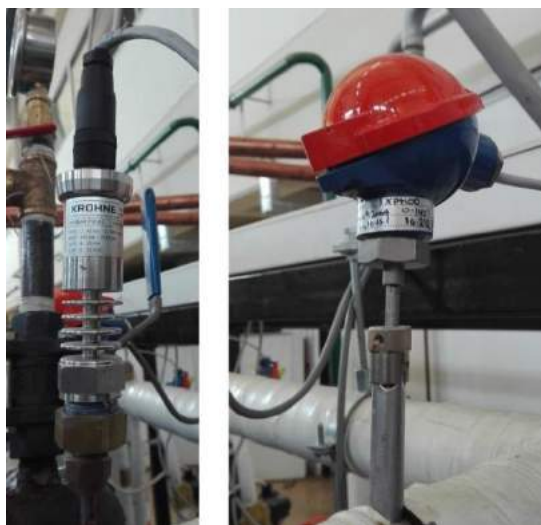
Εικόνα 2.25 Αναλογικά μετρητικά πίεσης (αριστερά) και θερμοκρασίας (δεξιά) της εγκατάστασης
