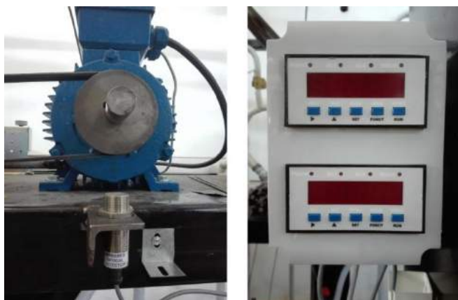
Εικόνα 2.26 Ανιχνευτής υπερύθρων και στροφόμετρο της εγκατάστασης
