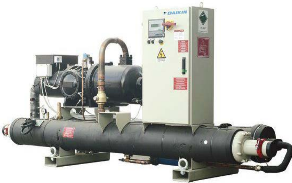
Εικόνα 9.14: Αντλία θερμότητας νερού-νερού για την παραγωγή ZNX εγκατεστημένο στο μηχανοστάσιο του κτιρίου (πηγή Daikin)
