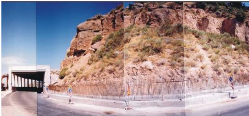
Εικόνα 4.17 Μέτρα προστασίας από καταπτώσεις στην επαρχιακή οδό Διακοφτό – Καλάβρυτα (Τσαγκάς, 2011)
