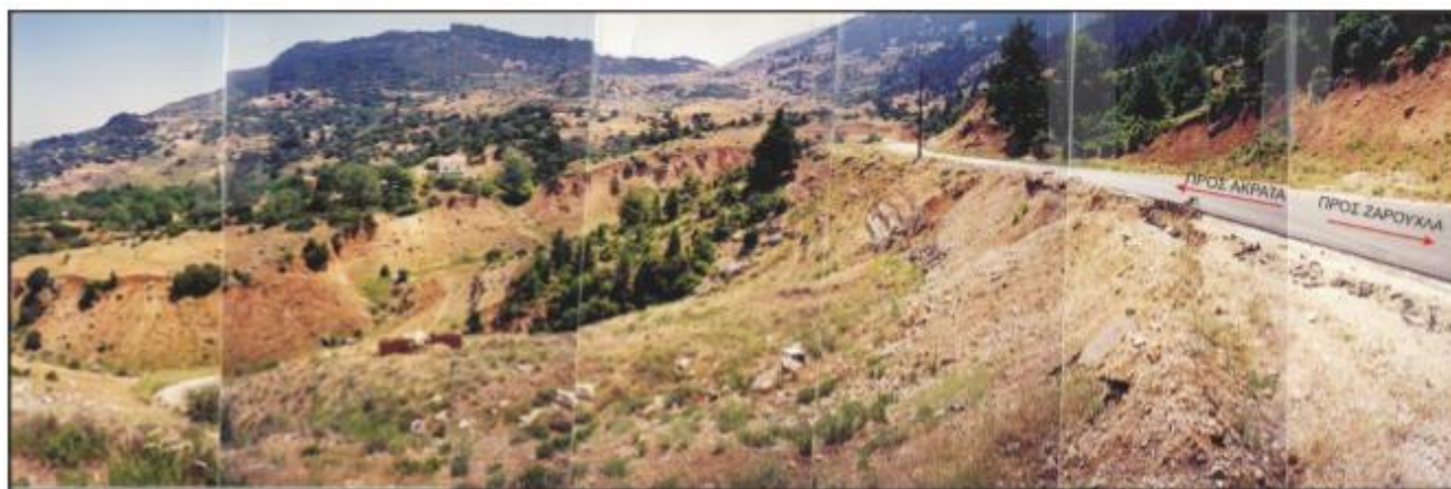
Εικόνα 4.7. Κατολισθητικά φαινόμενα που προκλήθηκαν από την διάνοιξη της επαρχιακής οδού προς Ζαρούχλα (Τσαγκάς, 2011)
