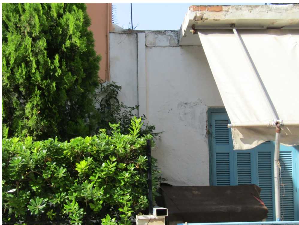
Εικόνα 6.27. Σημείο 3, Επισκευασμένη χιαστί ρωγή σε παλαιά ισόγεια μονοκατοικία
