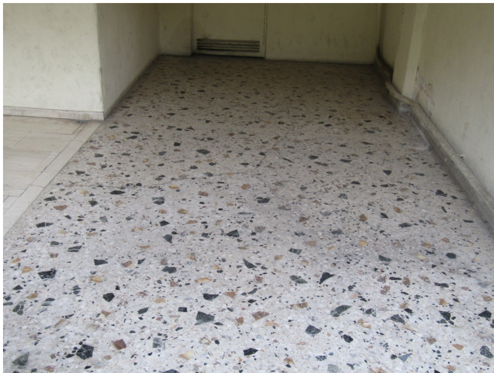
Εικόνα 6.31. Σημείο 1, Ρωγμάτωση δαπέδου σε πλάκα επί του εδάφους.
