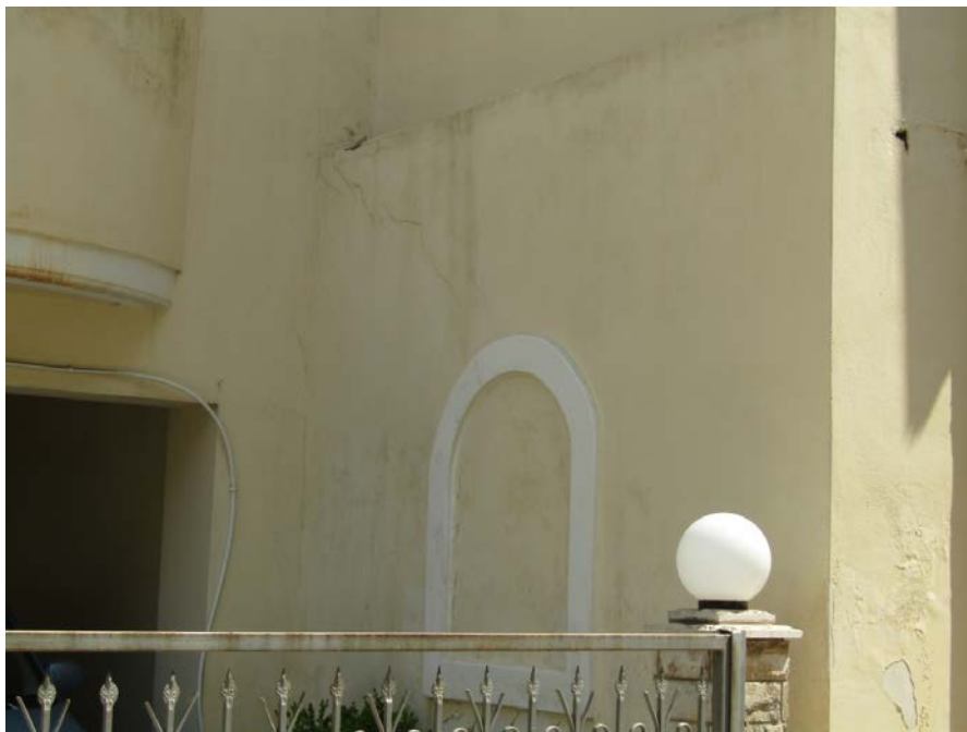
Εικόνα 6.13. Σημείο 1, Χιαστί ρωγμή σε τοιχοποιία
