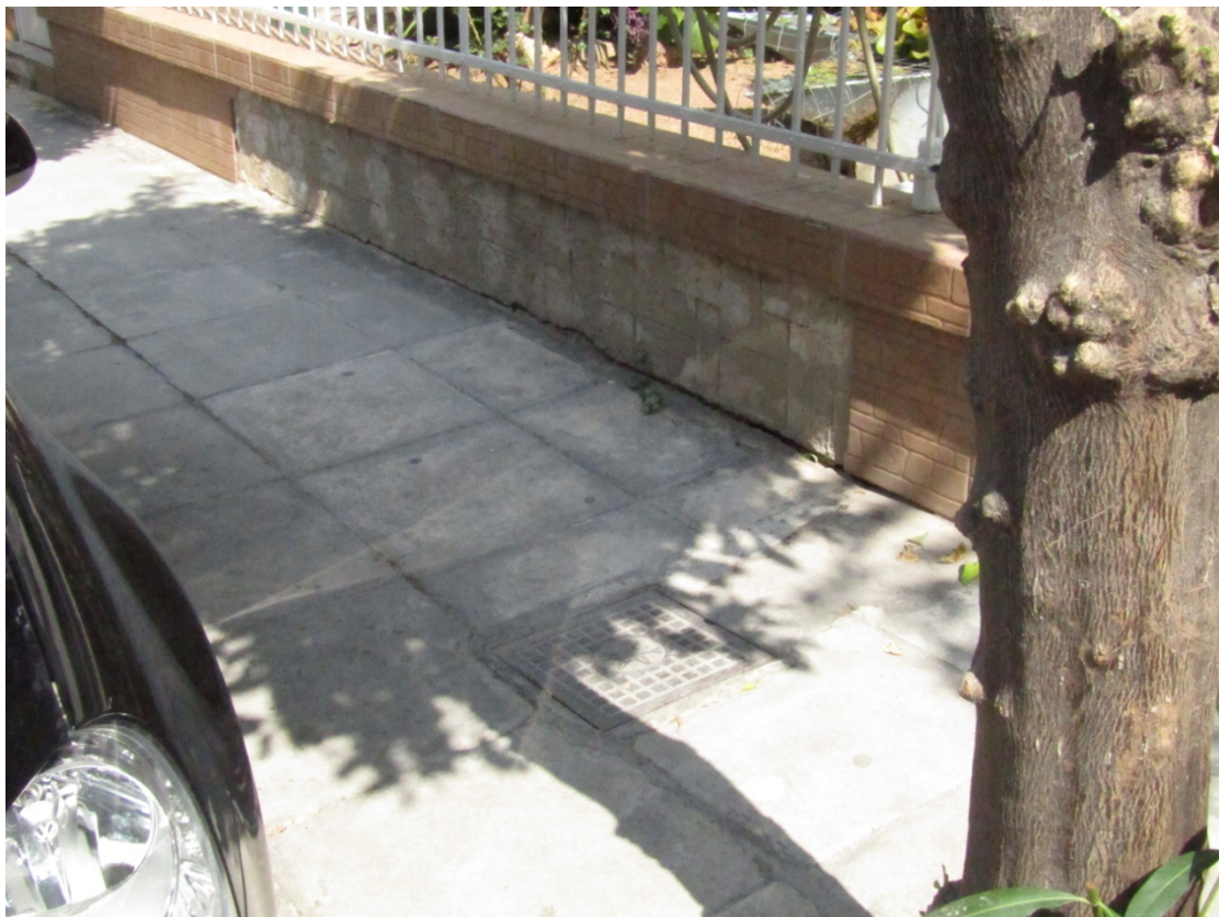
Εικόνα 6.5 Σημείο 2, υποχώρηση πεζοδρομίου
