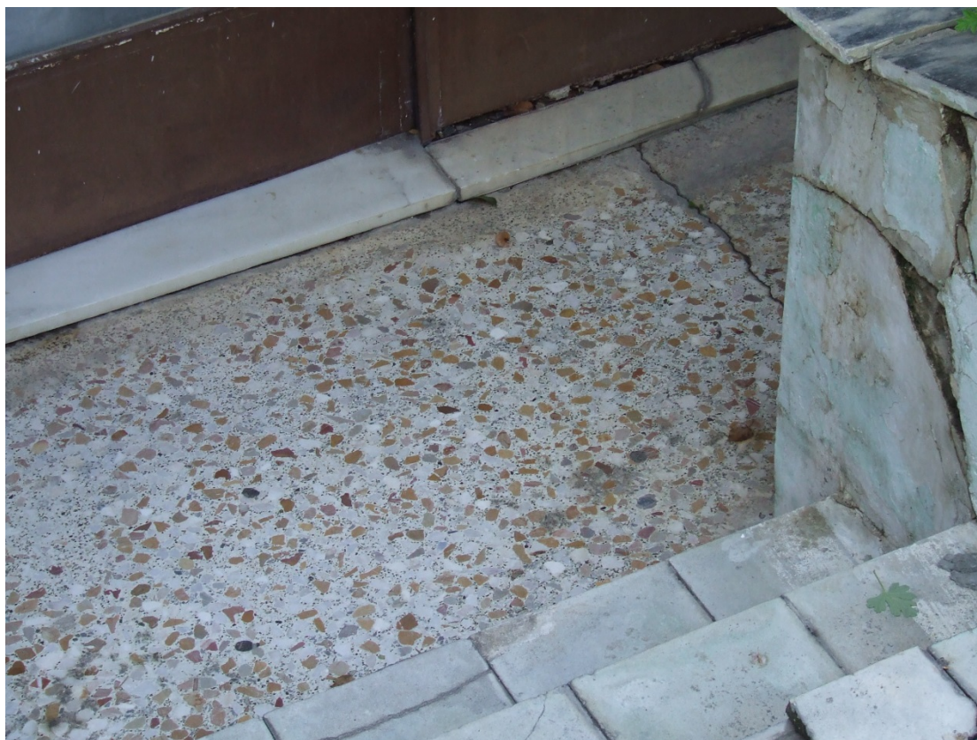
Εικόνα 6.41 Θέση 2, Έντονη ρωγμάτωση δαπέδου και μαντρότοιχου διαμορφώσεων
