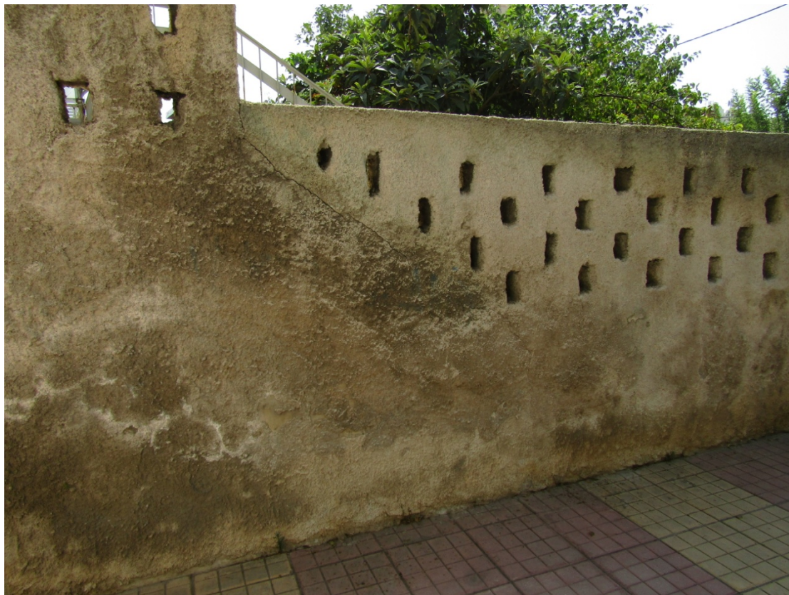
Εικόνα 7.19. Σημείο 3, Χιαστί ρωγμή σε μαντρότοιχο
