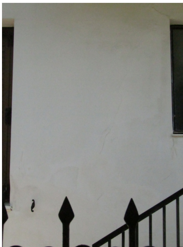
Εικόνα 6.7 Σημείο 3, Χιαστί ρωγμάτωση σε τοιχοποιία
