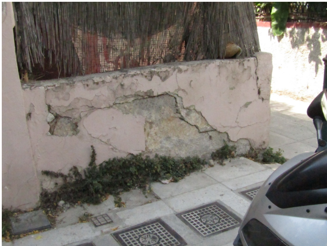
Εικόνα 6.6 Σημείο 2, Ρωγμάτωση σε μαντρότοιχο
