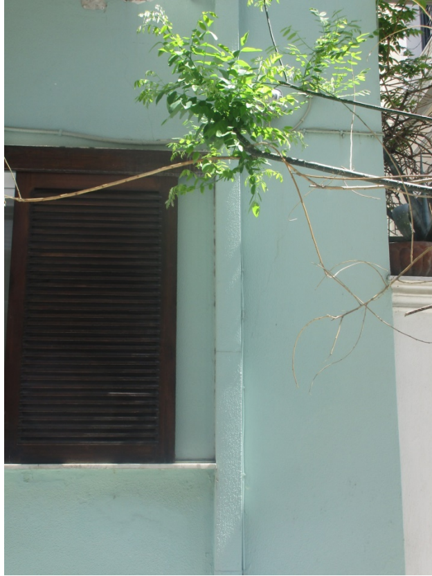
Εικόνα 7.9 Σημείο 3 διαγώνια ρωγή σε γωνιακό υποσύλωμα και τοιχοποιία
