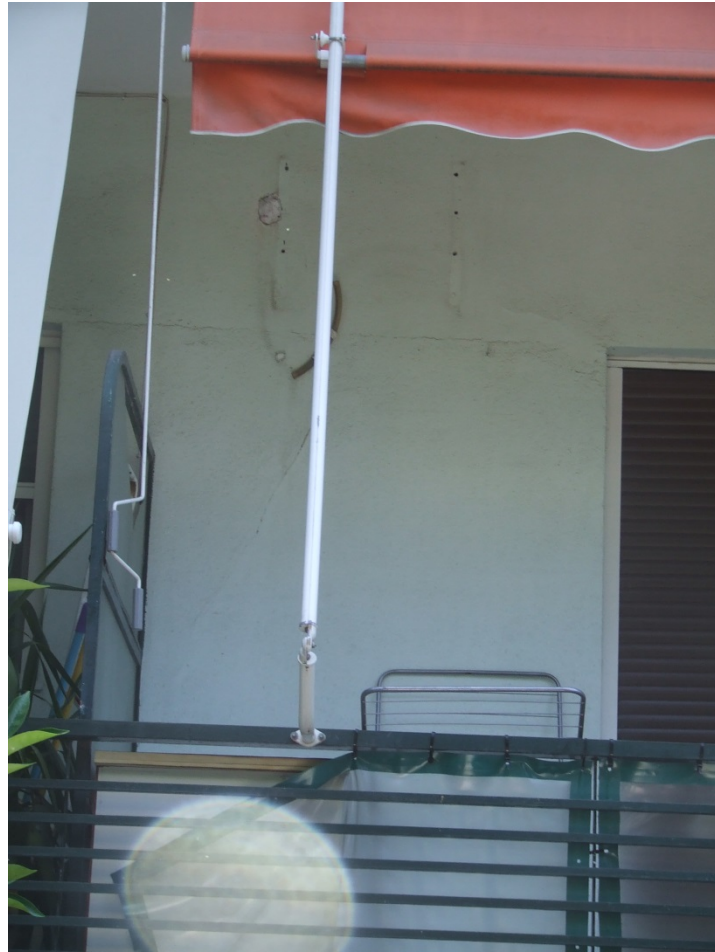
Εικόνα 6.48 Σημείο 1, Χιαστί ρωγμάτωση σε τοιχοποιία στο ισόγειο
