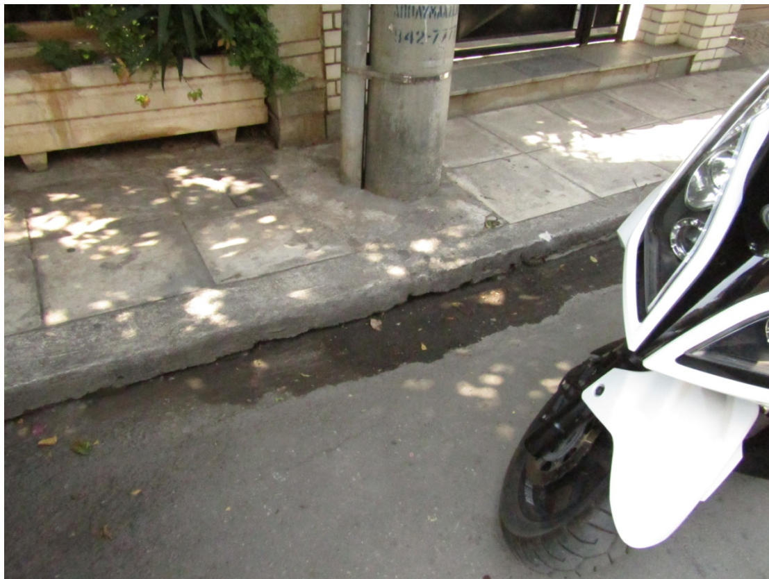
Εικόνα 6.11. Σημείο 2, Καθίζηση οδοστρώματος
