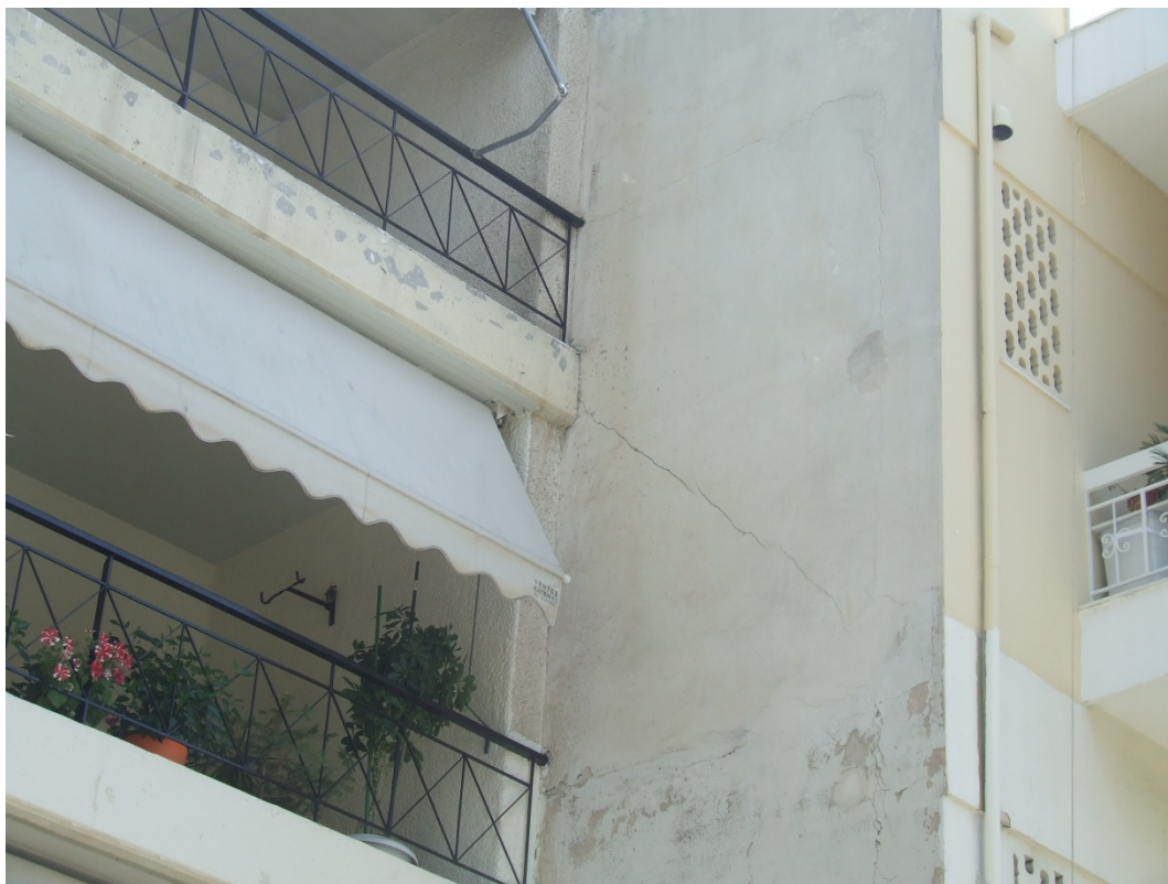
Εικόνα 6.43 Σημείο 1, Ρωγμάτωση «τυφλής» τοιχοποιίας στον τρίτο όροφο
