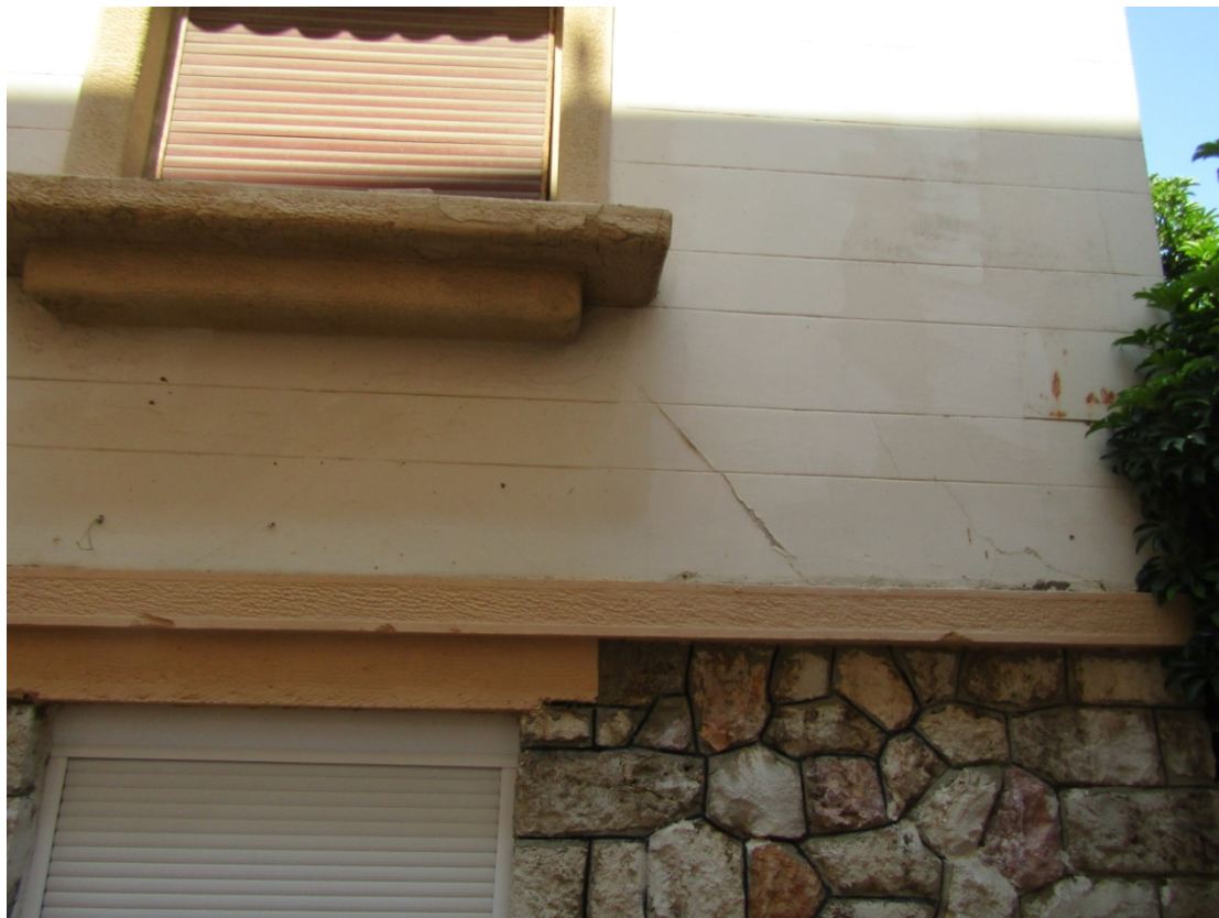
Εικόνα 7.17. Σημείο 1, Χιαστί ρωγμή σε δοκό
