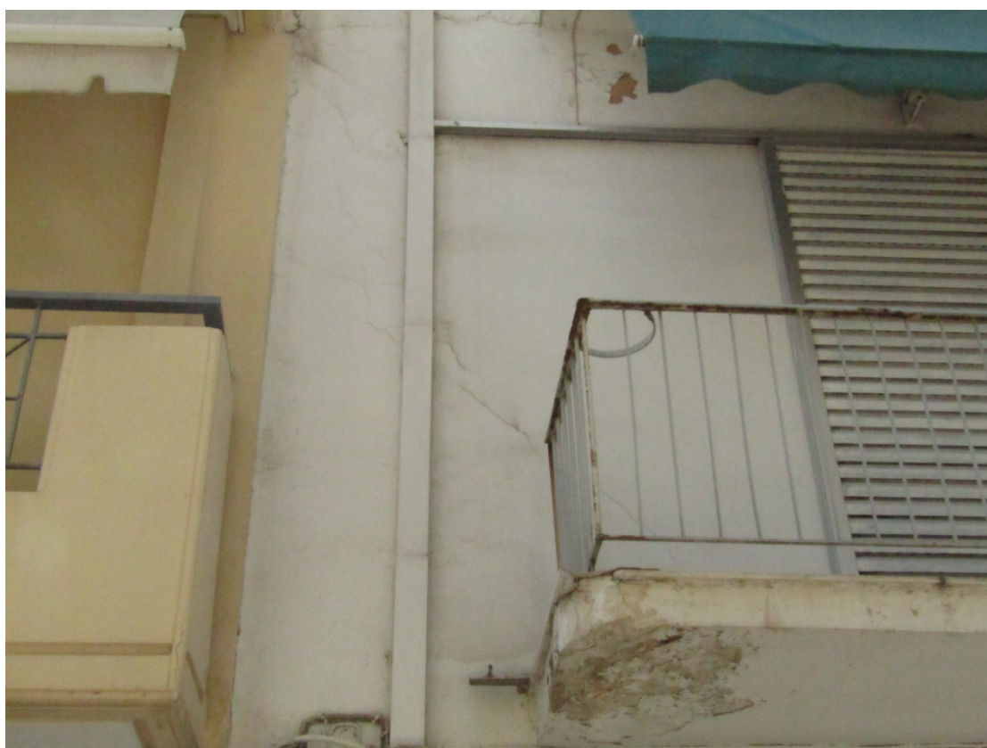
Εικόνα 6.14 Σημείο 1, Χιαστί ρωγμή σε τοιχοποιία
