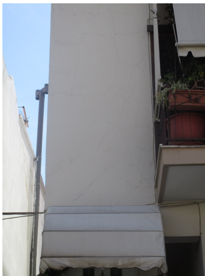
Εικόνα 7.26 Σημείο 4. Χιαστί ρωγματώσεις σε υποσύλωμα και επέκτασή τους στην τοιχοποιία
