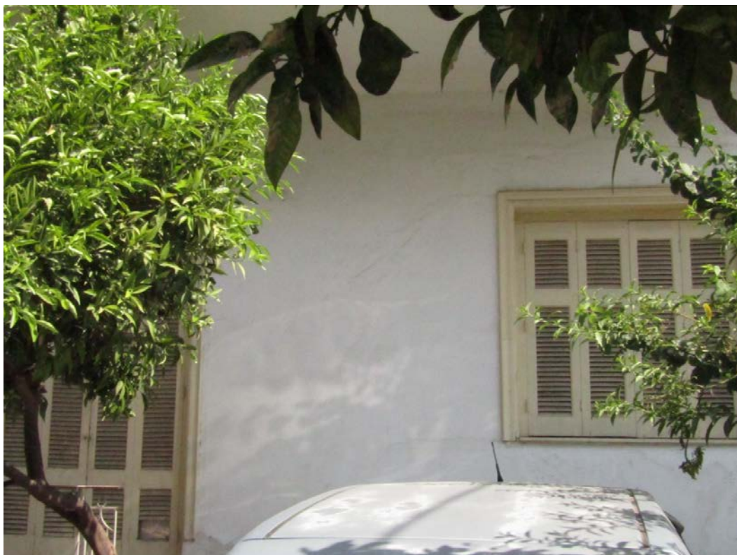
Εικόνα 6.10. Σημείο 1, Χιαστί ρωγμή σε τοιχοποιία
