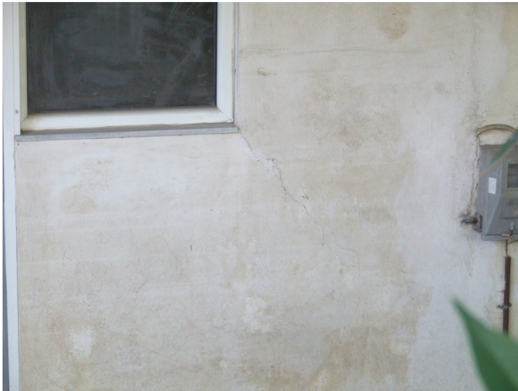
Εικόνα 6.49 Σημείο 1, Χιαστί ρωγμάτωση τοιχοποιίας στην στάθμη του υπογείου
