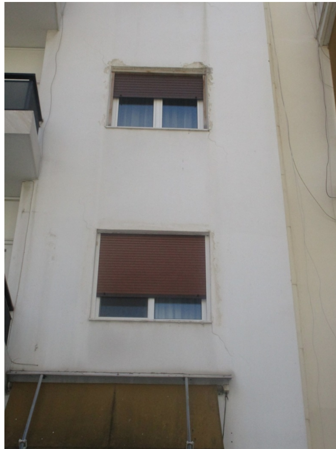
Εικόνα 7.4 Σημείο 1. διαγώνιες ρωγμές στην τοιχοποιία
