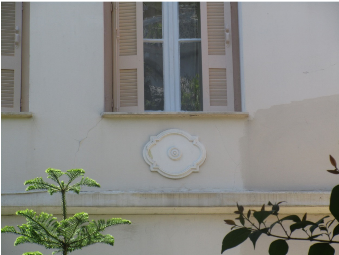
Εικόνα 7.6 Σημείο 3 ρωγμάτωση σε τοιχοποιία
