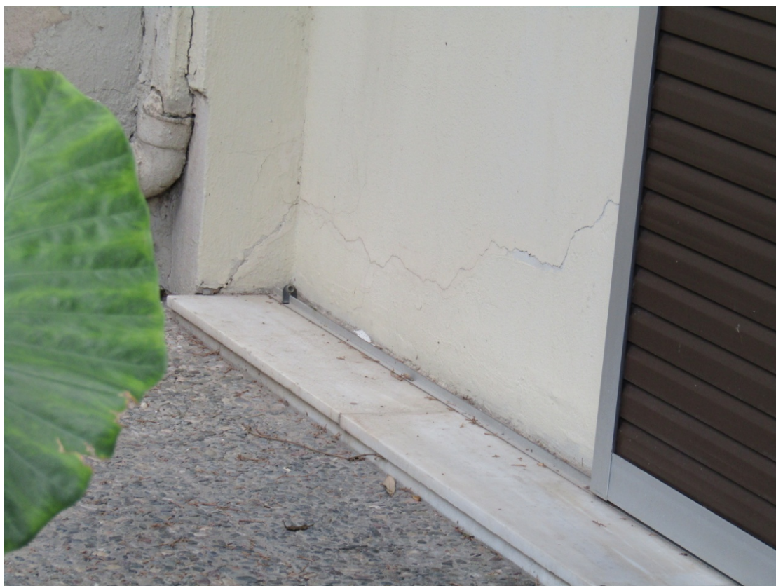
Εικόνα 6.32. Σημείο 1, Χιαστί ρωγμή σε τοιχοποιία ισογείου διαμερίσματος
