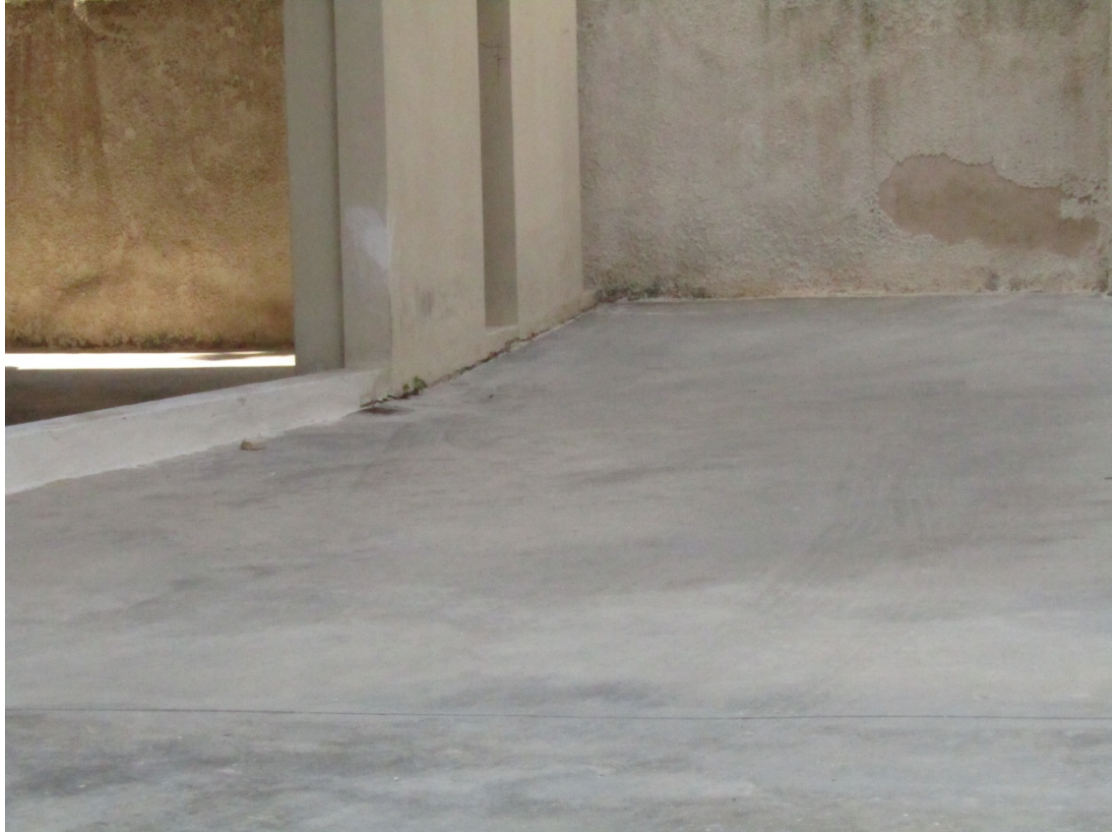
Εικόνα 6.4..Σημείο 1, Καθίζηση βιομηχανικού δαπέδου ακαλύπτου
