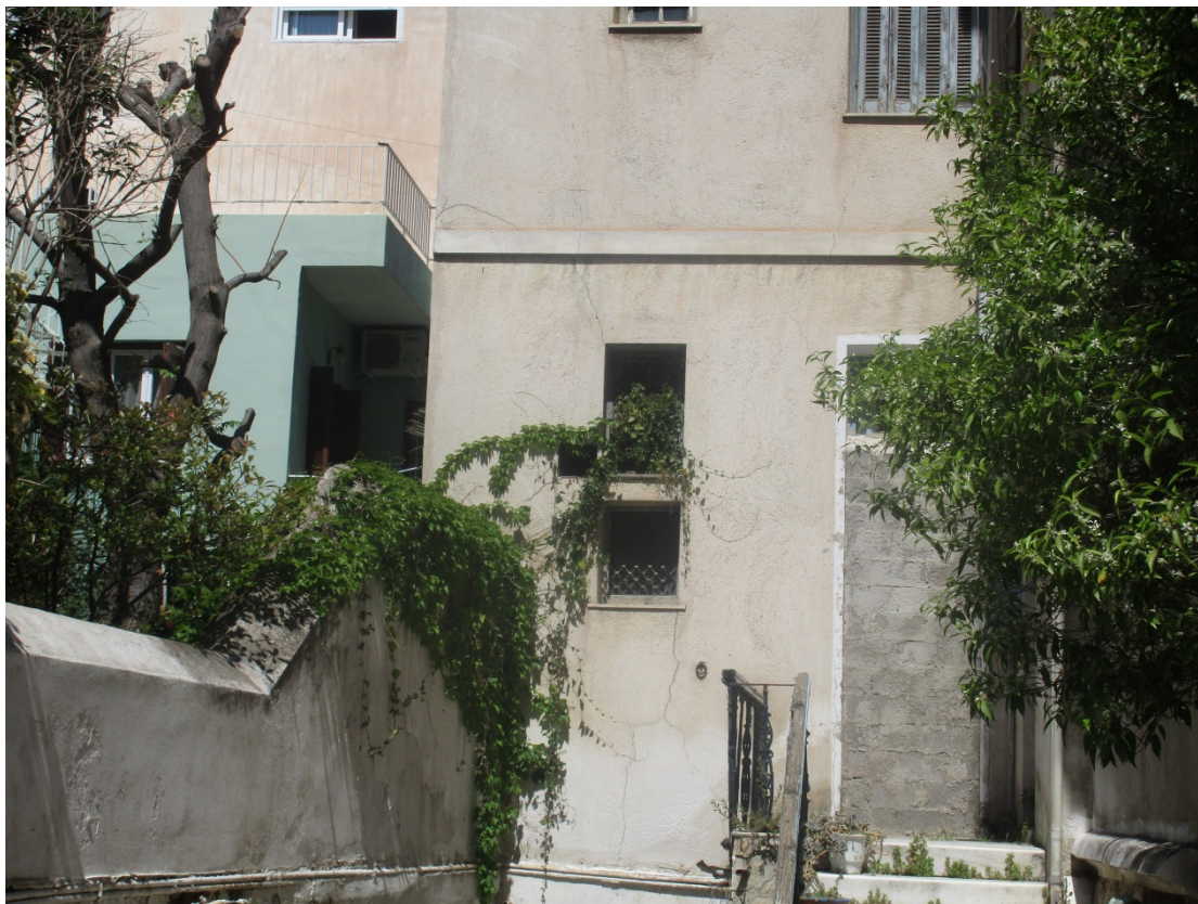
Εικόνα 7.7 Σημείο 3 έντονη ρωγμάτωση σε τοιχοποιία
