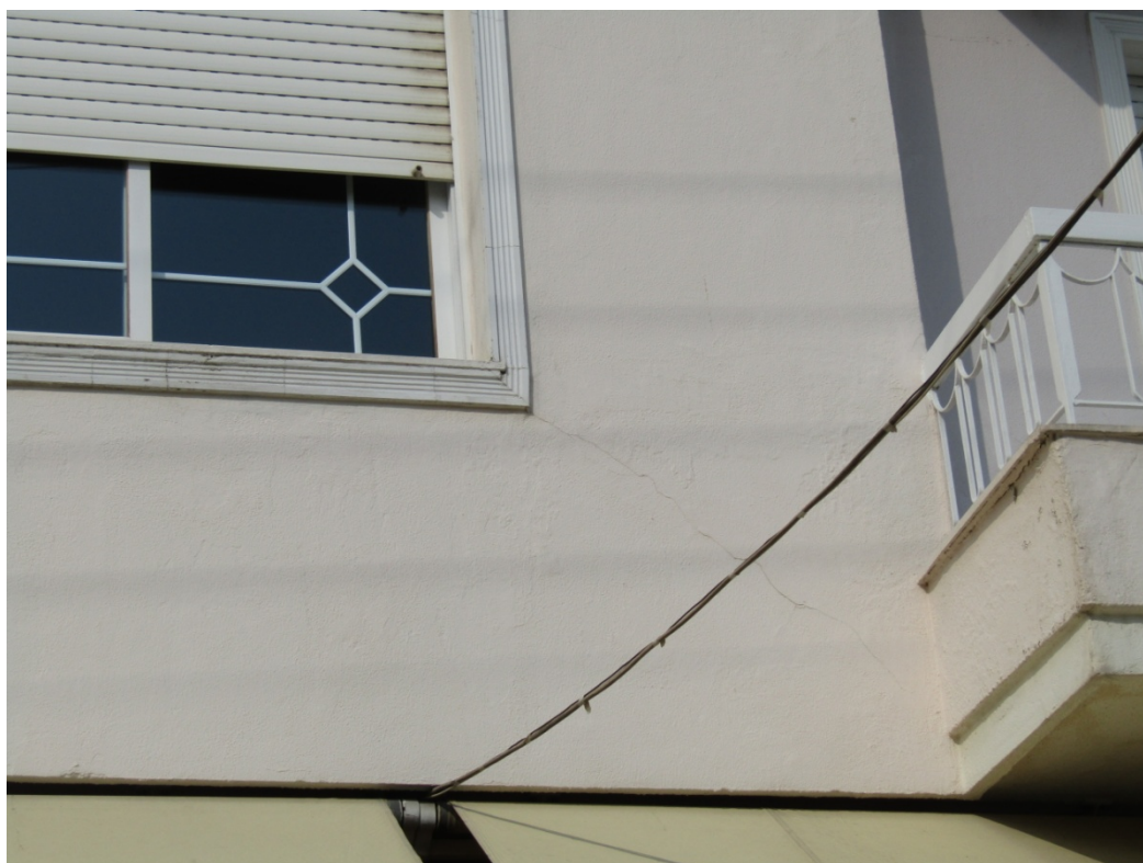
Εικόνα 6.21. Σημείο 1, χιαστί ρωγή σε τοιχοποιία
