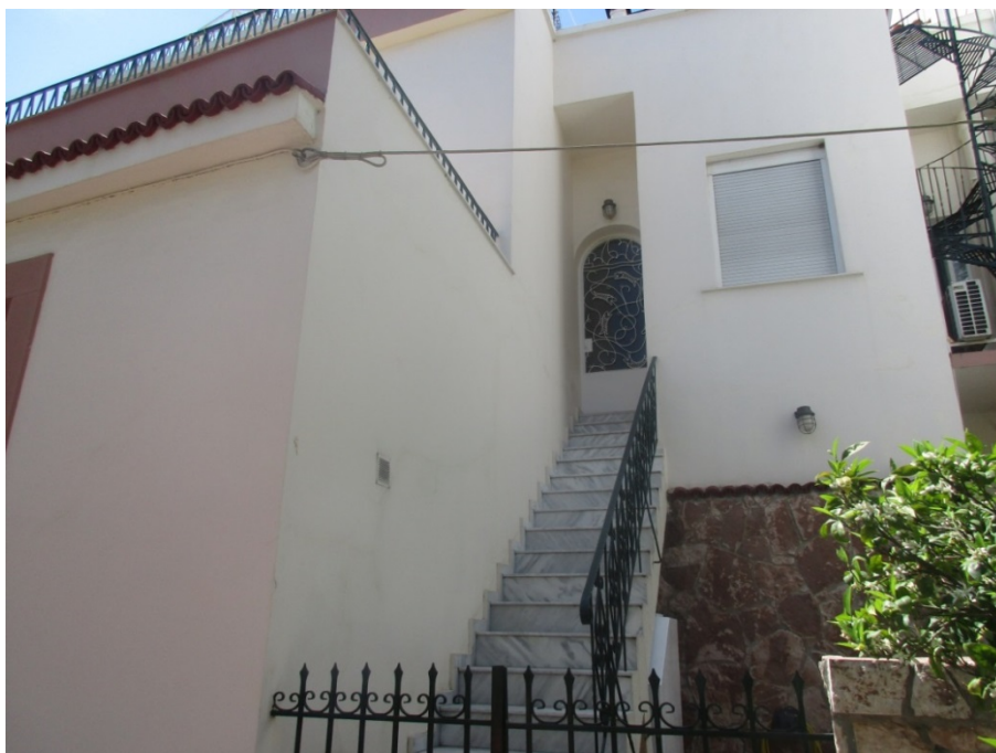
Εικόνα 7.25 Σημείο 3. Χιαστί ρωγμάτωση σε τοιχοποιία
