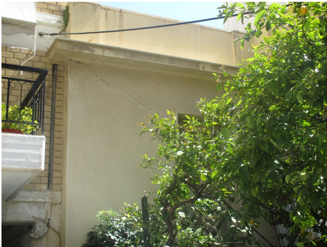
Εικόνα 7.13 Σημείο 4. Χιαστί ρωγή σε τοιχοποιία
