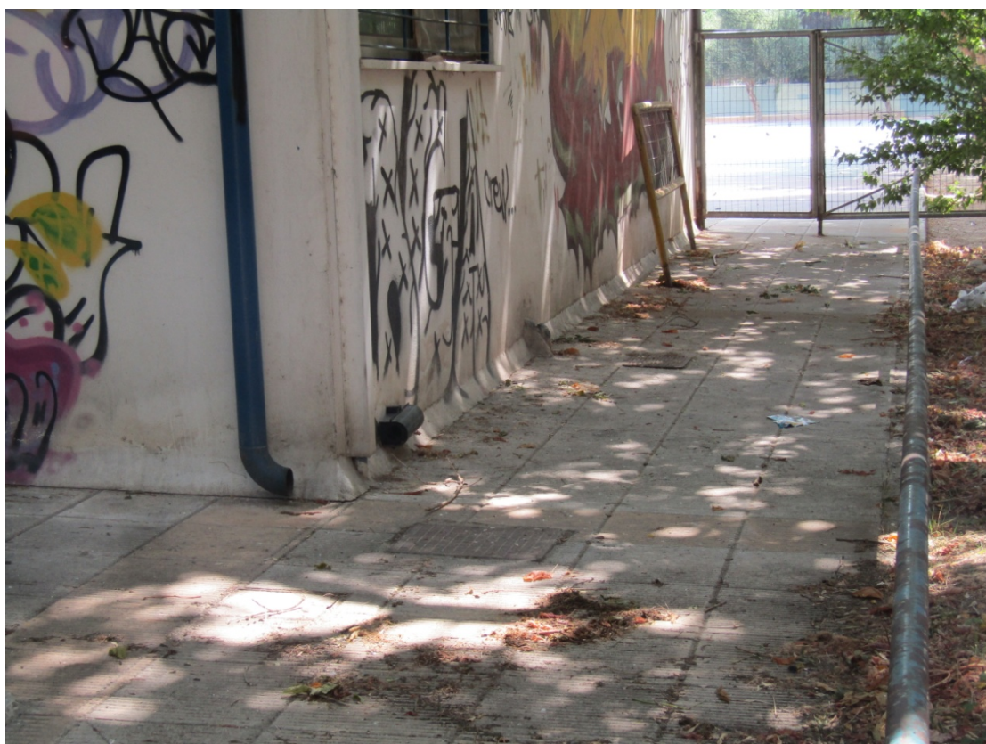
Εικόνα 7.18. Σημείο 2, Καθίζηση πλακόστρωσης σε προαύλιο χώρο σχολείου
