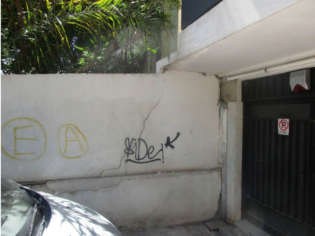
Εικόνα 7.5 Σημείο 2 διαγώνια ρωγμή σε μαντρότοιχο
