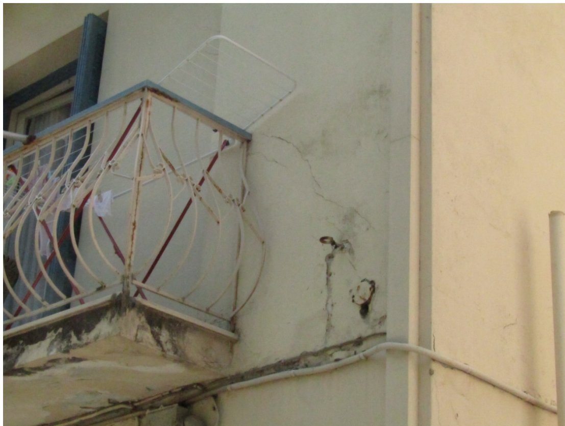
Εικόνα 6.15. Σημείο 2, Χιαστί ρωγμή σε τοιχοποιία
