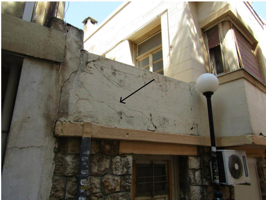
Εικόνα 7.16. Σημείο 1, Χιαστί ρωγή σε δοκό
