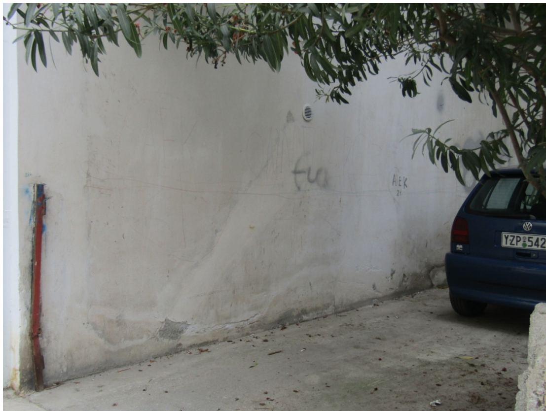
Εικόνα 6.33. Σημείο 2, Επισκευασμένη χιαστί ρωγμή σε τοιχοποιία ισογείου
