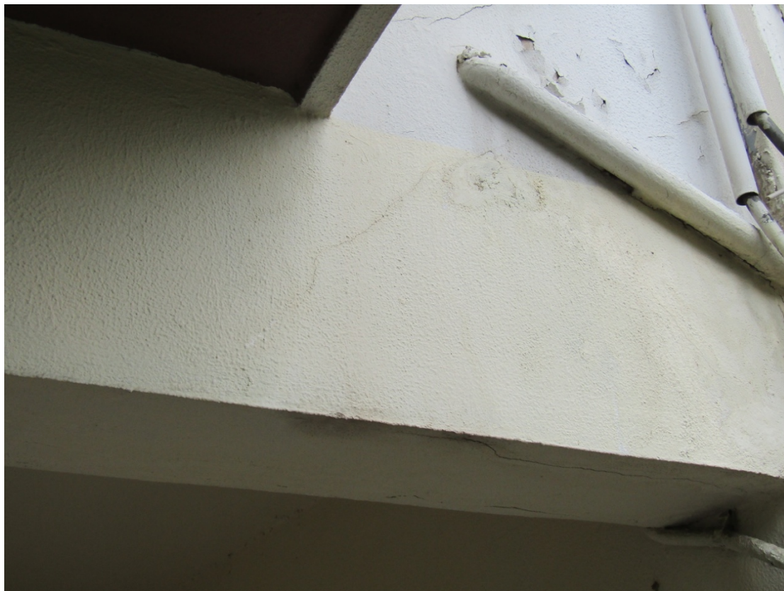
Εικόνα 6.29. Σημείο 1, Χιαστί ρωγή σε δοκό πιλοτής και συνέχεια της στην τοιχοποιία
