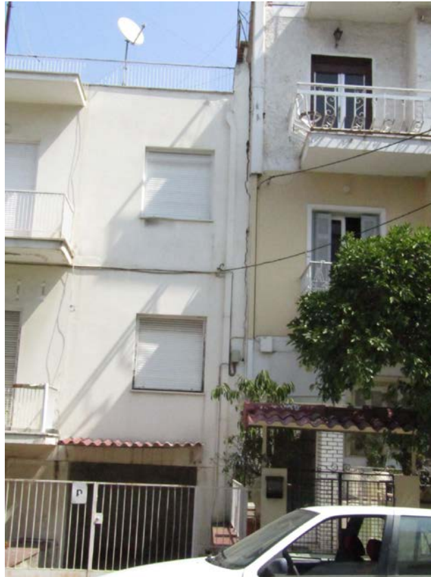
Εικόνα 6.9. Σημείο 1, διεύρυνση αντισεισμικού αρμού και χιαστί ρωγμές σε τοιχοποιία. Απόκλιση του κτηρίου από την κατακόρυφο.
