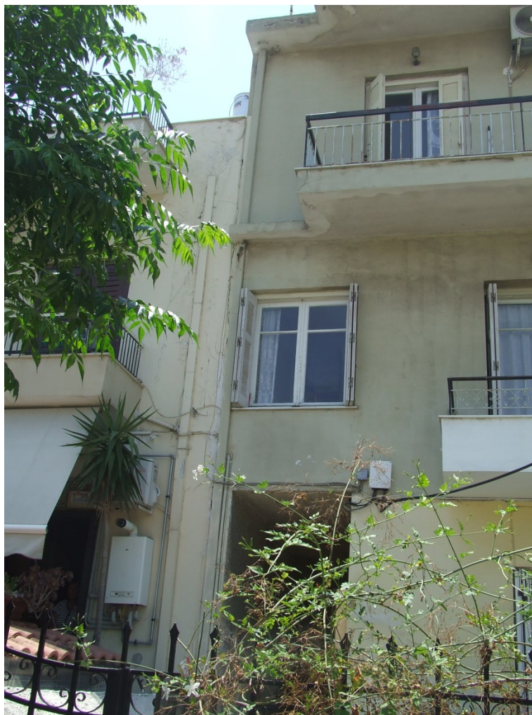
Εικόνα 6.46 Σημείο 2, Ρωγμάτωση τοιχοποιίας και διεύρυνση αρμού
