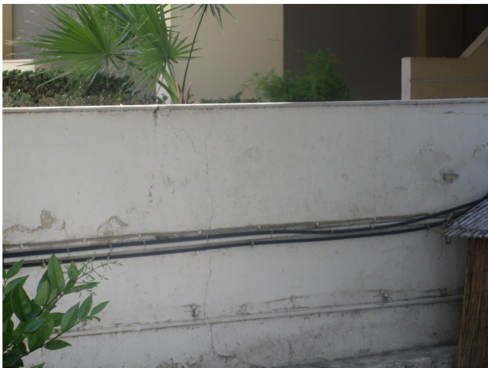
Εικόνα 7.12 Σημείο 4 Ρωγμάτωση σε μαντρότοιχο
