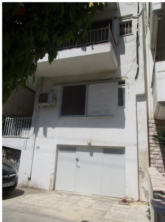
Εικόνα 7.22 Σημείο 1. Χιαστί ρωγμάτωση σε υποστύλωμα
