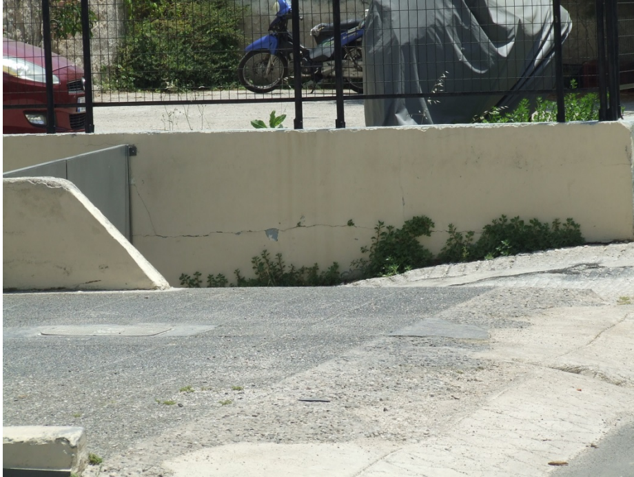
Εικόνα 6.45 Σημείο 2, Ρωγμάτωση μαντρότοιχου Ο/Σ ράμπας προς υπόγειο
