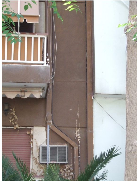
Εικόνα 6.50 Σημείο 2, Διεύρυνση σημείου επαφής ομόρων πολυκατοικιών
