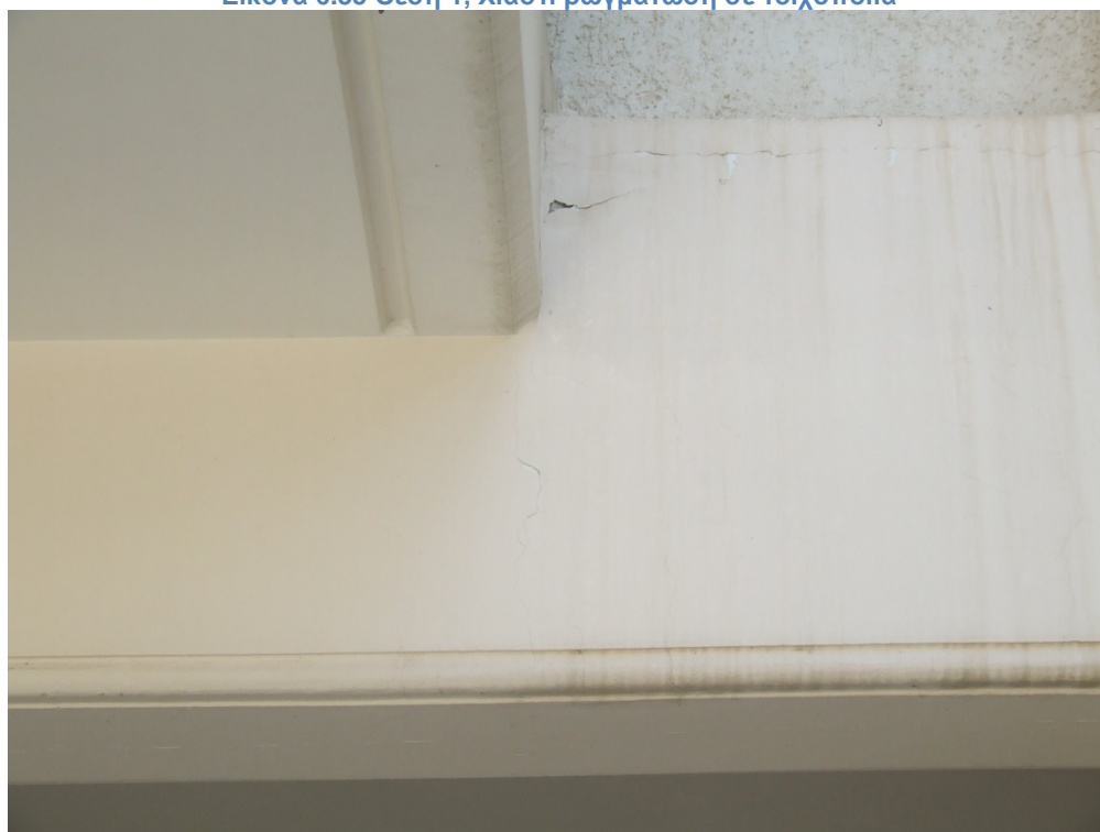
Εικόνα 6.36 Θέση 1, Καμπική ρωγμή δοκού στην στάθμη της πιλοτής.
