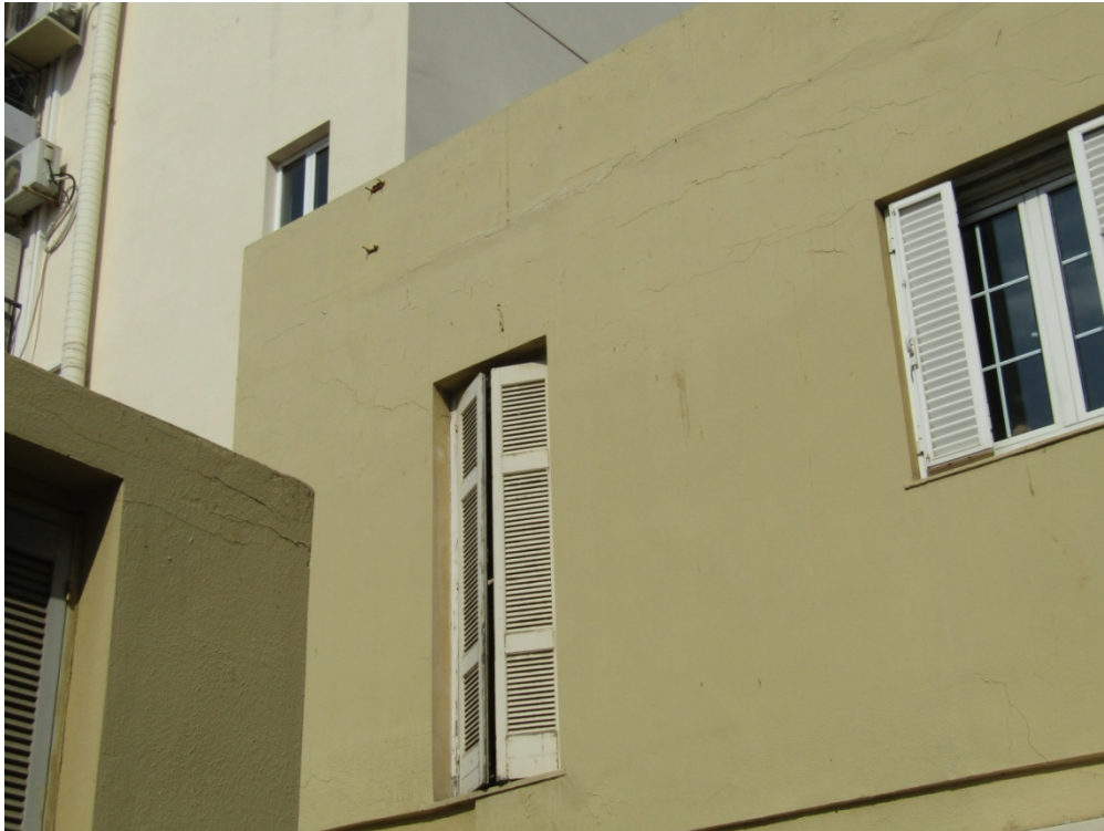
Εικόνα 6.26. Σημείο 2, Χιαστί ρωγή σε τοιχοποιία
