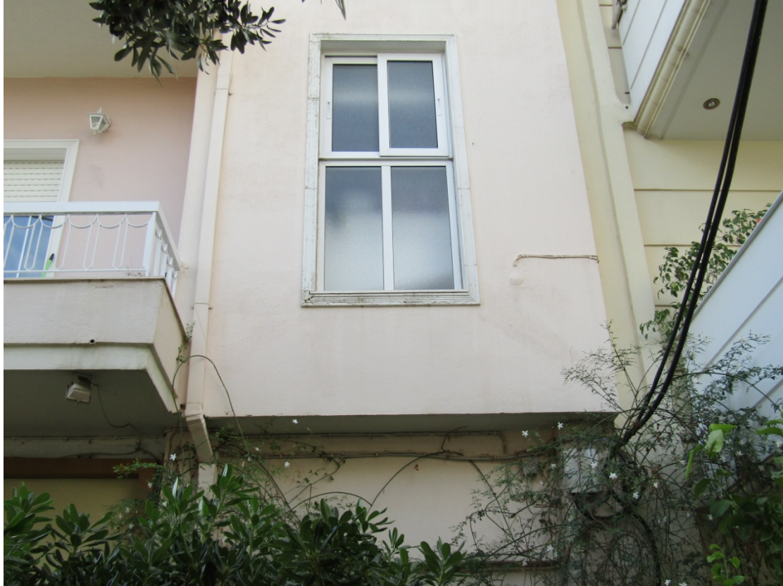
Εικόνα 6.22. Σημείο 1, Χιαστί ρωγή (επισκευασμένη) σε τοιχοποιία
