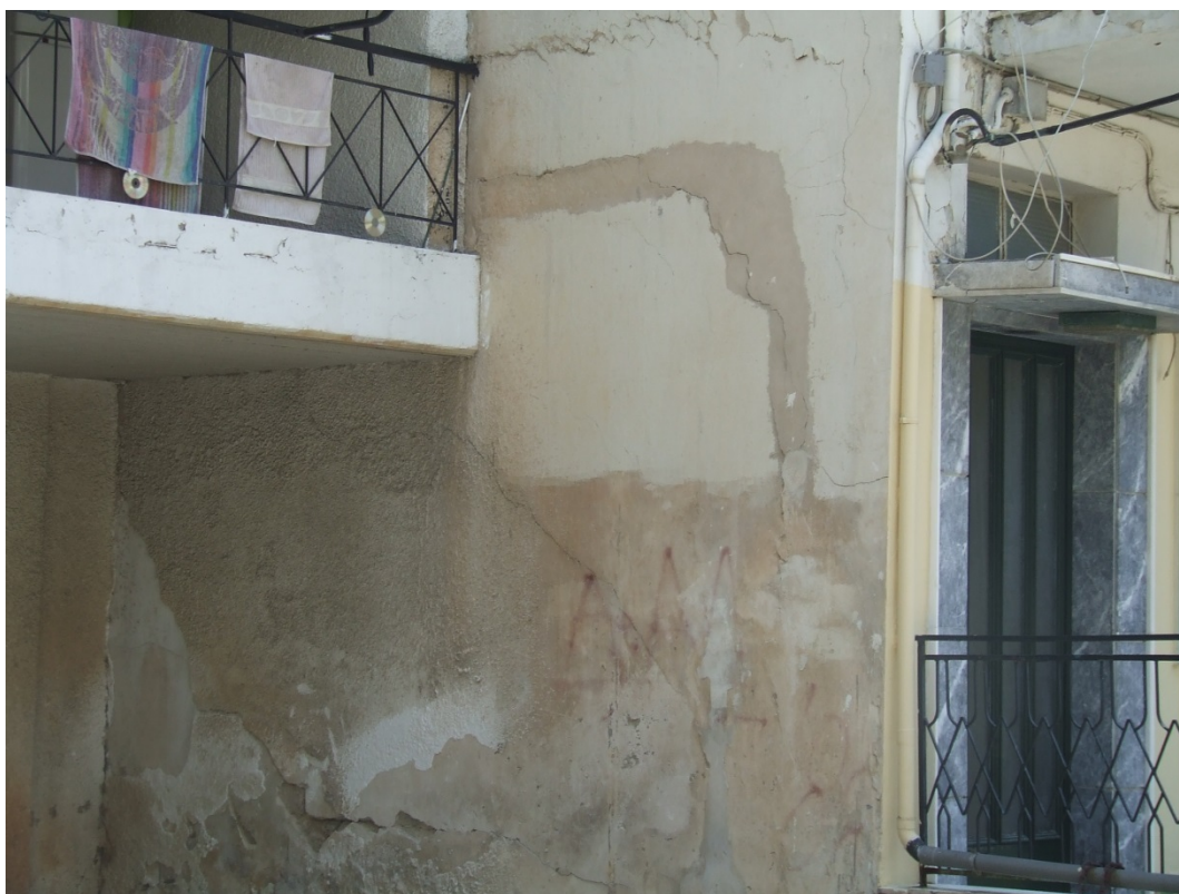
Εικόνα 6.44 Σημείο 1, Ρωγμάτωση «τυφλής» τοιχοποιίας στο ισόγειο
