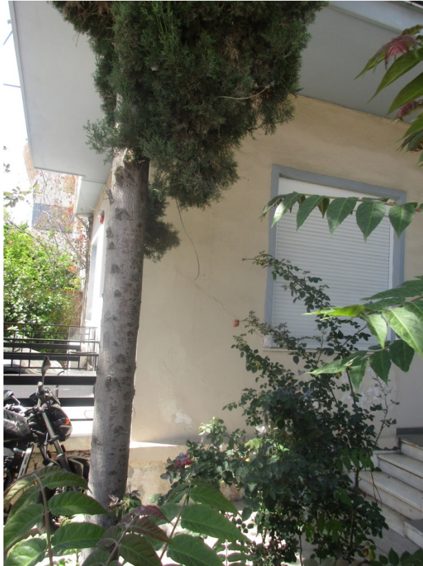
Εικόνα 7.23 Σημείο 1. Χιαστί ρωγμάτωση σε τοιχοποιία στο ισόγειο. Πιθανή καθίζηση πεδίου.
