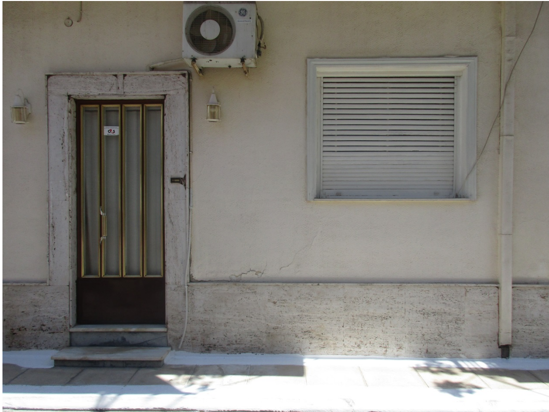
Εικόνα 7.27 Σημείο 5. Χιαστί ρωγμάτωση σε τοιχοποιία
