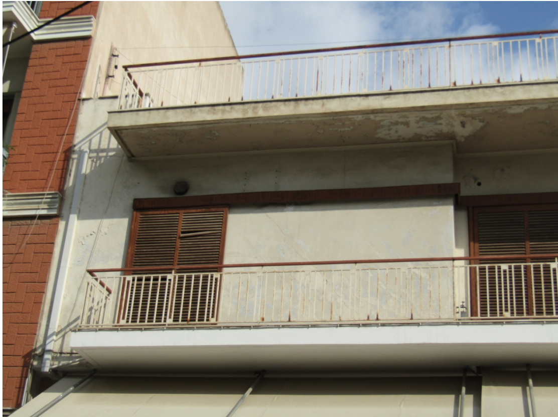
Εικόνα 6.23. Σημείο 2, Χιαστί ρωγή σε τοιχοποιία Α' ορόφου
