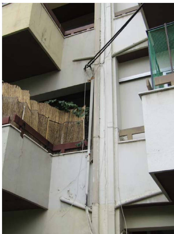
Εικόνα 6.30. Σημείο 1, Χιαστί ρωγή στον Α' όροφο
