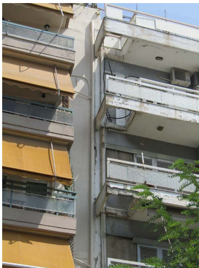
Εικόνα 7.20. Σημείο 4, διεύρυνση αντισεισμικού αρμού
