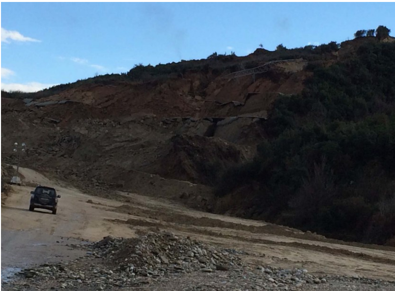
Εικόνα 3.22: Νοτιοανατολική όψη μετά το κατολισθητικό φαινόμενο στη ΧΘ 11+000
