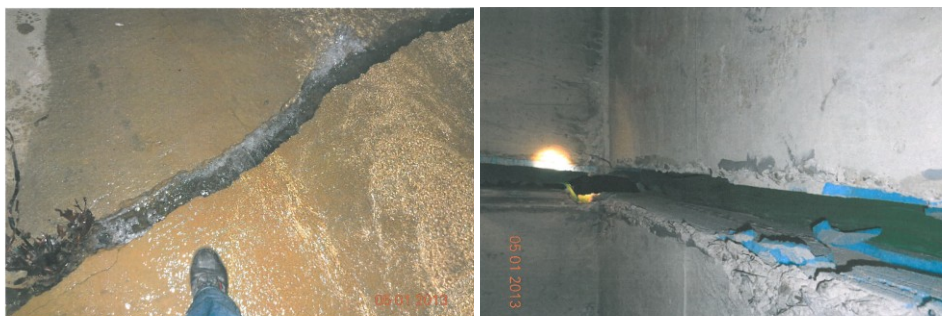
Εικόνα 3.33: Φωτογραφία της εμφανούς διαφορικής μετατόπισης των τμημάτων του οχετού στη ΧΘ 11+982
