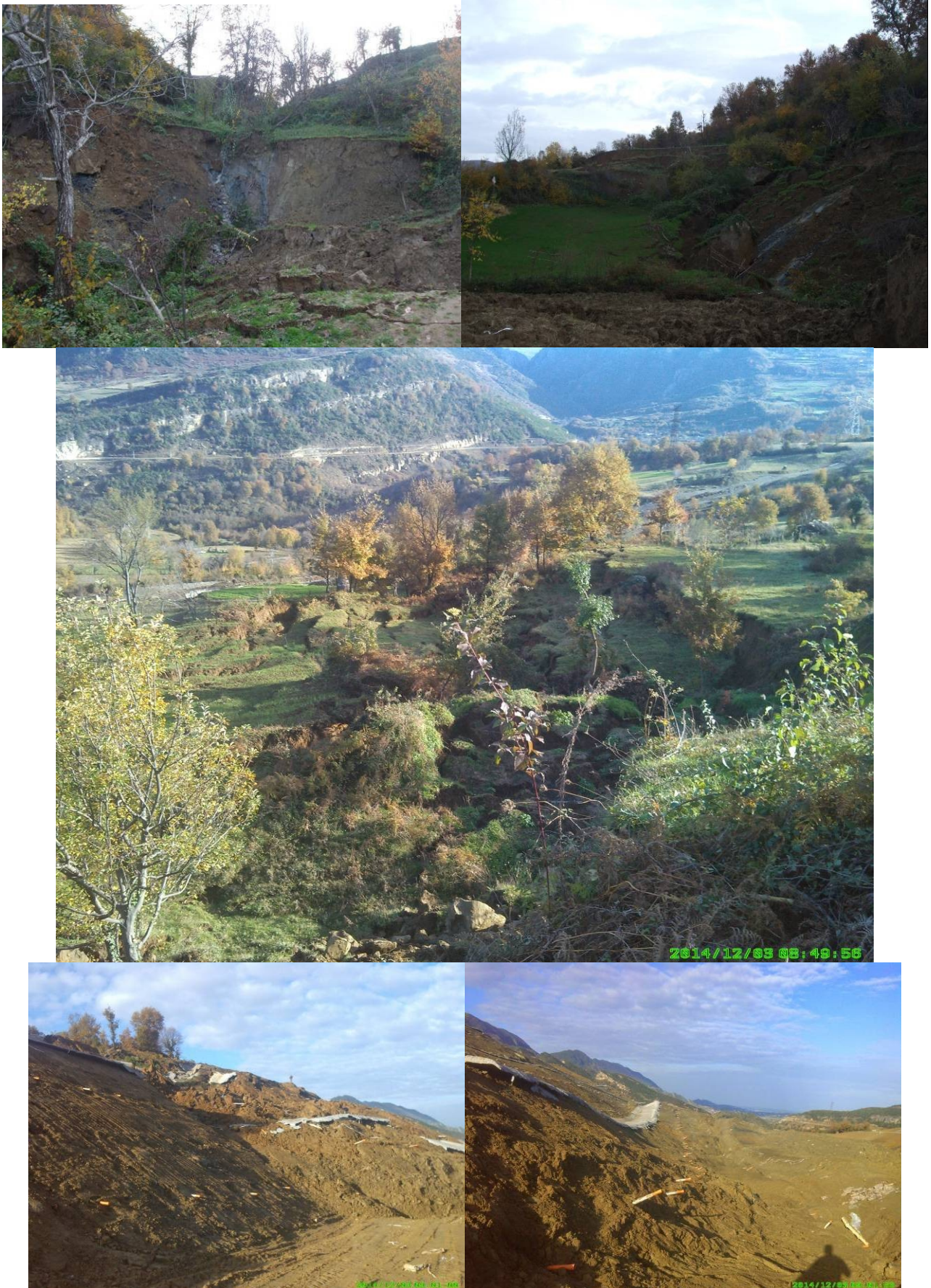
Εικόνα 3.56: Φωτογραφίες μετά από συμβάν 02/12/2014 στην κατολίσθηση της ΧΘ 13+150
