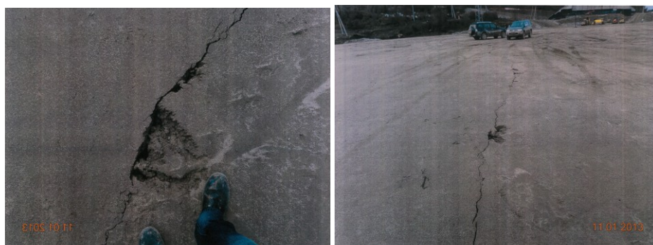
Εικόνα 3.344: Φωτογραφία της ρωγμής επί της επιφάνειας εργασίας του επιχώματος στη ΧΘ 12+000
