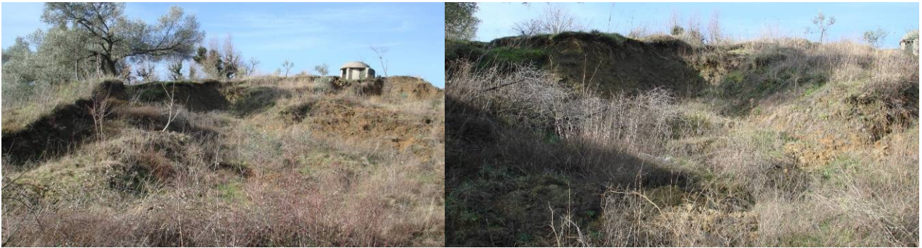
Εικόνα 3.70: Φωτογραφίες από περιοχή κατολίσθησης στη ΧΘ 14+150 πριν την αρχή των εργασιών (GEOSAT GROUP & ICE, 2011)
