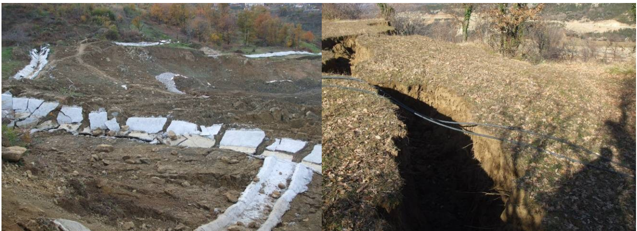
Εικόνα 3.55: Φωτογραφίες μετά από συμβάν 02/12/2014 στην κατολίσηση της ΧΘ 13+150
