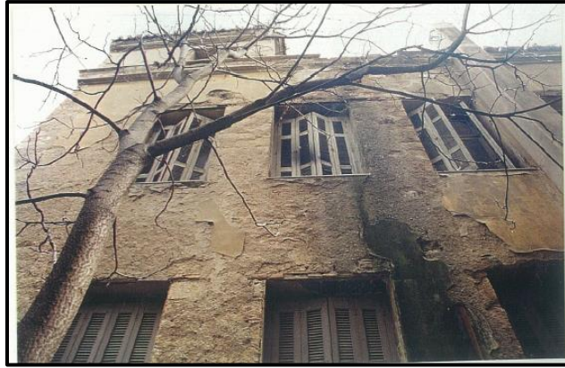
Εικόνα 4.2: Αλλοιώσεις στην όψη του διατηρητέου προς τον ακάλυπτο Πηγή: Προμελέτη Αρχιτεκτονικής Αποκατάστασης και Επέκτασης
