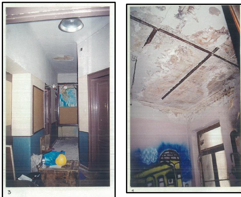
Εικόνα 4.3: Οξείδωση δοκών και καταστροφή οροφокονιαμάτων Πηγή: Προμελέτη Αρχιτεκτονικής Αποκατάστασης και Επέκτασης
