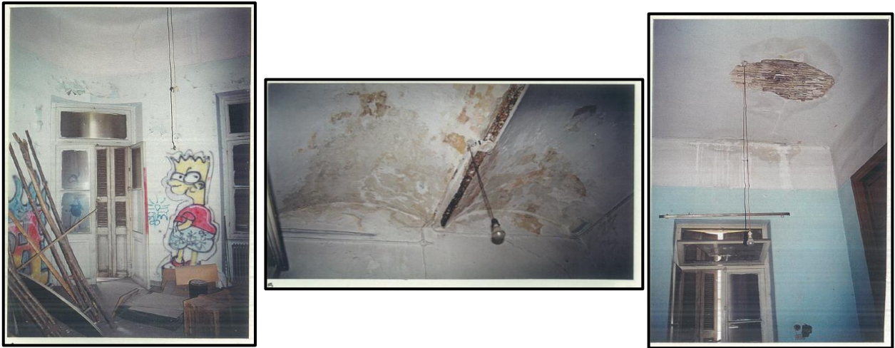
Εικόνα 4.4: Αλλοιώσεις δευτέρου ορόφου Πηγή: Προμελέτη Αρχιτεκτονικής Αποκατάστασης και Επέκτασης
