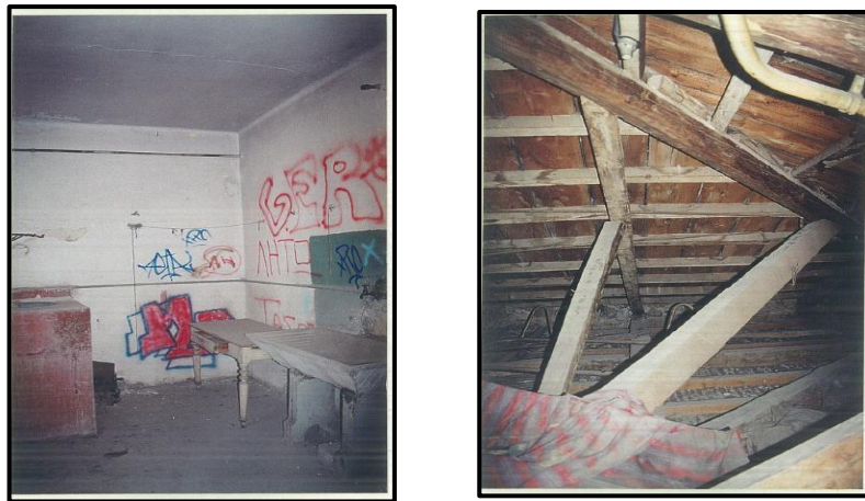
Εικόνα 4.5: Διάβρωση ξύλινων δοκών στέγης και ρηγματώσεις υπό κατεδάφιση πλυσταριού Πηγή: Προμελέτη Αρχιτεκτονικής Αποκατάστασης και Επέκτασης
