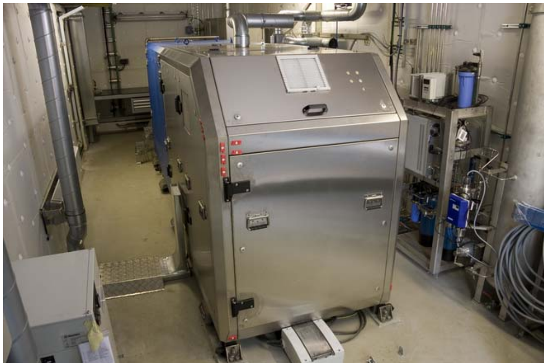
Εικόνα 3.13 Το σύστημα κυψελών καυσίμου WFC20 της Wartsila στο εσωτερικό του container [38].
