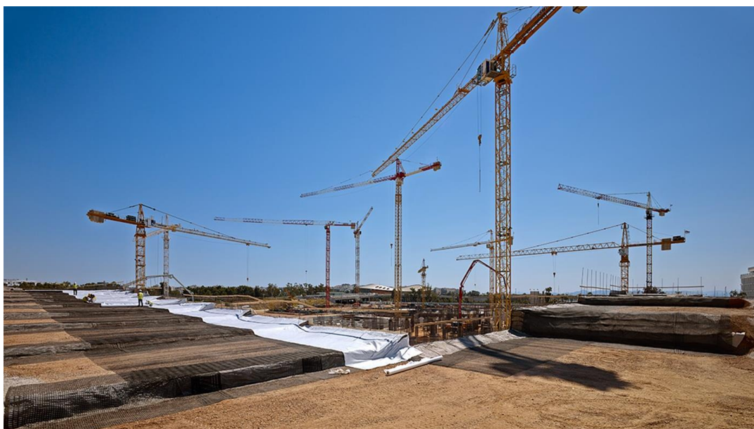
Εικόνα 3.28 : Διάστρωση αδρανών υλικών με την παρεμβολή συνθετικών πλεγμάτων για την κατασκευή της «οπλισμένης γης» ( www.snfcc.org )
