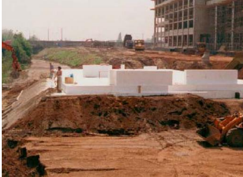
Εικόνα 2.29 : Ελαφρύ επίχωμα πάνω από υπόγειο τερματικό σταθμό μετρό για ανύψωση εδάφους , στο Dusseldorf της Γερμανίας ( www.styropan.gr )
