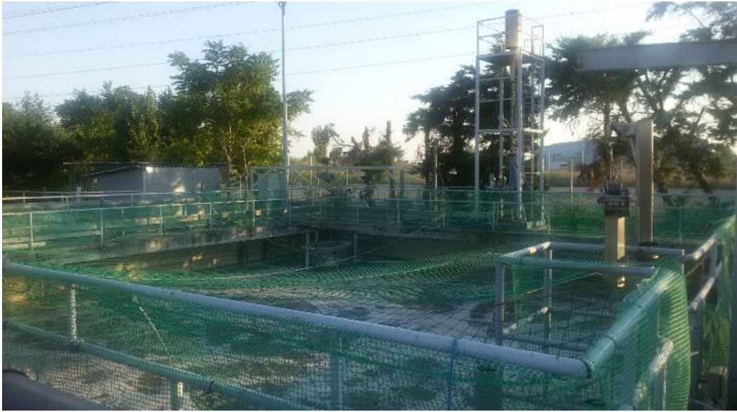
Εικόνα 5: Αντιδραστήρας SBR της μονάδας βιολογικής επεξεργασίας στην TASTYFOODS
