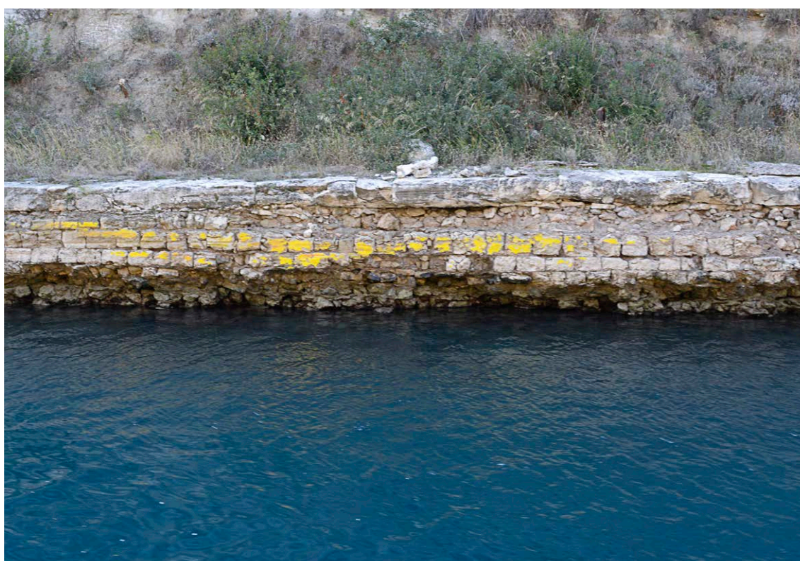
Εικ.3: Κατεστραμμένος ο χαμηλότερος αναβαθμός, σημάδι από την πρόσκρουση πλοίου
