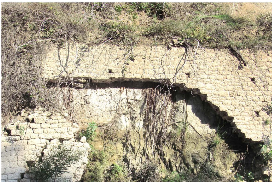
Εικ.2: Κατολίσηση λιθοδομής.
