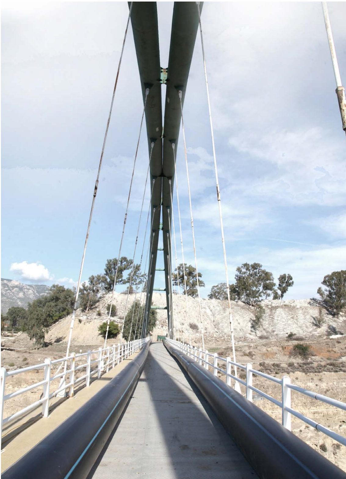
Εικ. 7: Παρεμπόδιση της κυκλοφορίας στη γέφυρα του Βιολ. Καθαρισμού λόγω των προβλεπόμενων νέων σωλήνων για τα λήμματα.
