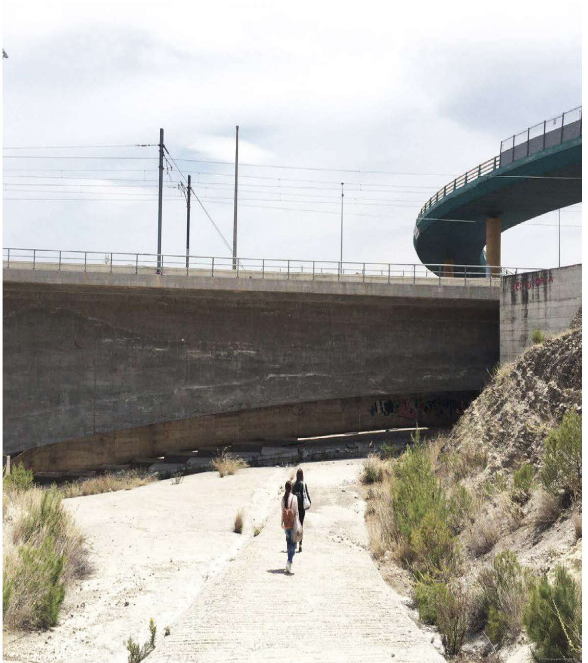
Εικ. 9: Η Νέα Εθνική Οδός, ένα σκληρό όριο στο χώρο, δημιουργία οπτικής και λειτουργικής ασυνέχειας
