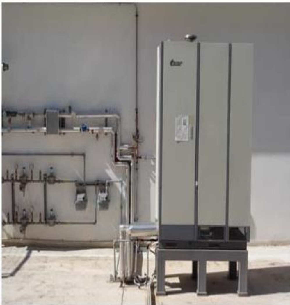
Εικόνα 3.14: Διβάθμιος ψύκτης απορρόφησης στο Ε.Μ.Π [3.12]
