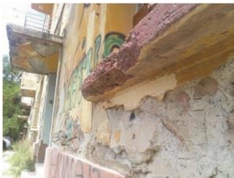
Εικόνα 24 (Εμφανής οπλισμός λόγω ρήγματος στην ποδιά του ανοίγματος, και εμφανής λιθοδομή λόγω αποκόλλησης επιχρίσματος)
