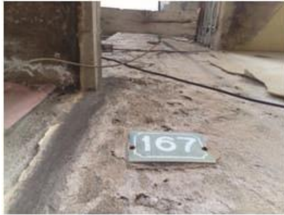
Εικόνα 25 (Εμφάνιση αυθεντικού επιχρίσματος λόγω αποφλοίωσης στρώματος χρώματος)
