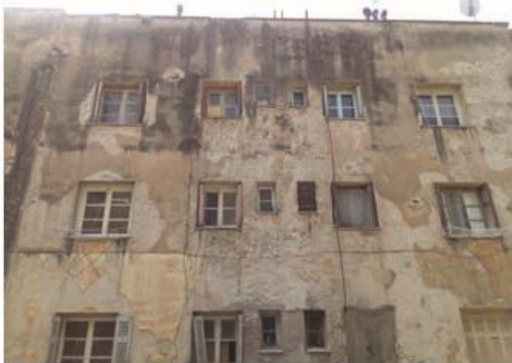
Εικόνα 23 (Βιοδιάβρωση από κατερχόμενη υγρασία από την ταράτσα λόγω οξείδωσης των υδρορροών και απώλειας επιτελεστικότητας του συστήματος διαχείρισης όμβριων υδάτων)
