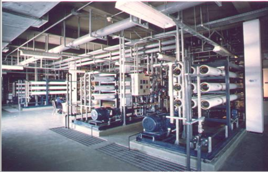
Εικόνα 5.7: Εγκαταστάσεις μονάδας αντίστροφης όσμωσης (Τζεν, 2001)
