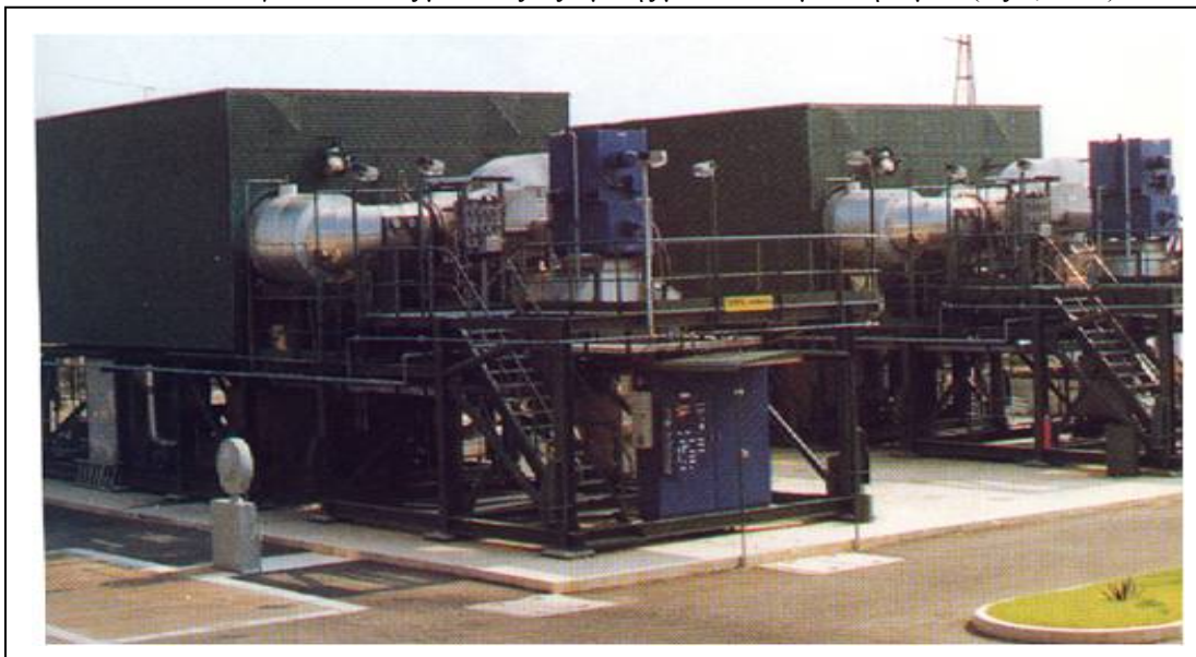
Εικόνα 5.3: Εγκαταστάσεις μονάδας Εξάτμισης με επανασυμπίεση ατμών (Τζεν, 2001)
