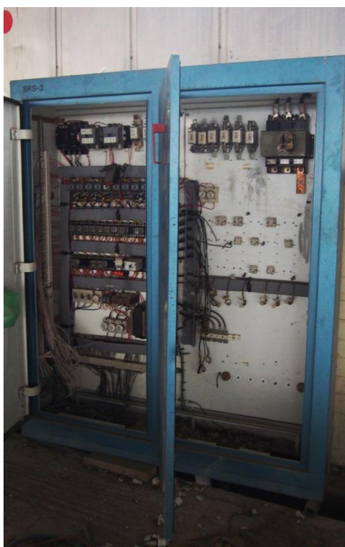
Εικόνα 54. Φθορές λόγω της διάρρηξης στο πριστήριο της Φουρνάς
