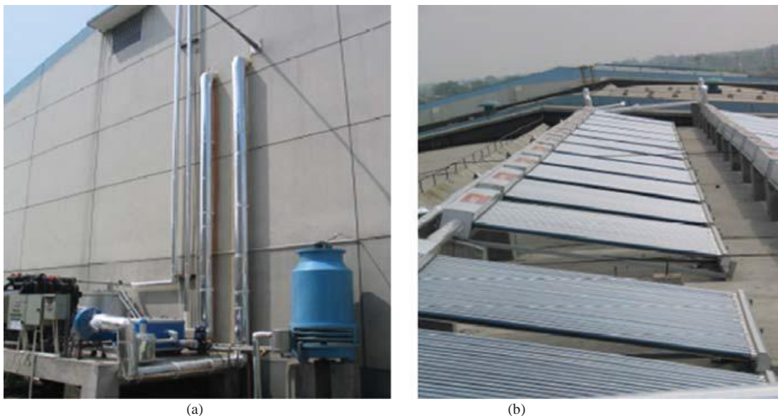
Σχήμα 5.2.6.5. Φωτογραφίες από το ηλιακό σύστημα προσρόφησης για συγκομιδή σιτηρών. (α) ψύκτης προσρόφησης, (β) ηλιακοί συλλέκτες. [300]
