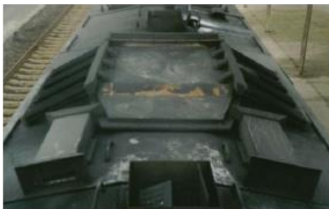
Σχήμα 5.1.3. Προσοφητής του εγκατεστημένου ,στο πάνω μέρος του σιδηροδρόμου, κλιματιστικού [34-35]
