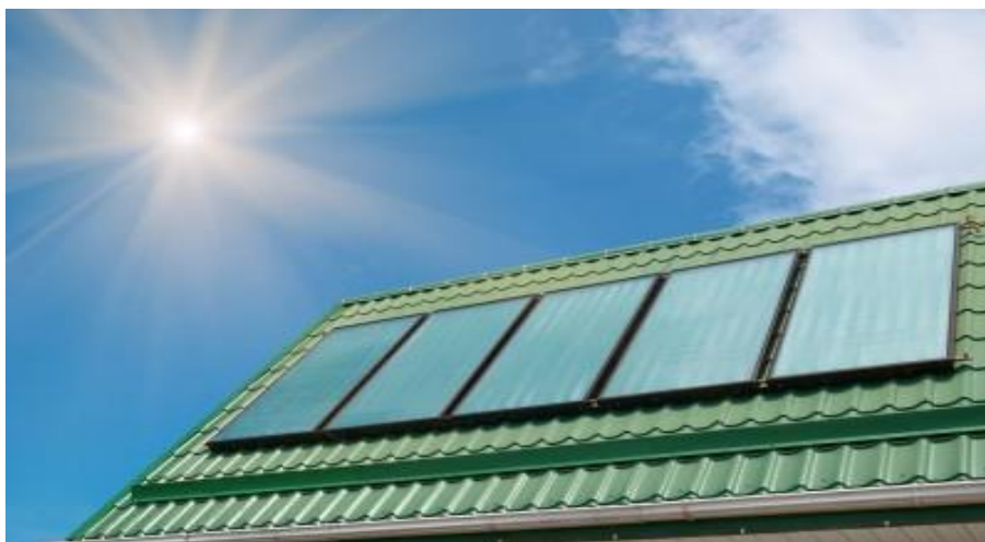
Εικόνα 1.12: Ηλιακοί συλλέκτες σε στέγη κτιρίου
