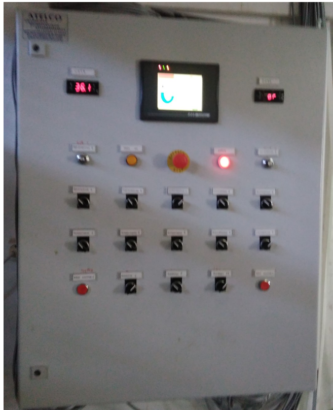
4- 6: Εικόνα του πίνακα ελέγχου PLC
