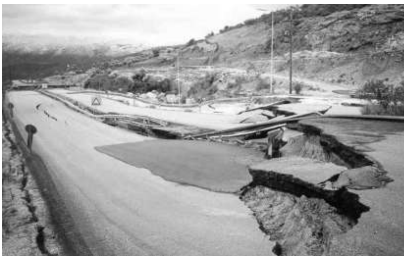
Εικόνα 5.14. Άποψη του βυθίσματος που προκάλεσε η κατολίσθηση στο οδόστρωμα της Ε.Ο. Κορίνθου - Τρίπολης / Χ.Θ. 123+000 (Ντουινιάς κ.α., 2006).
