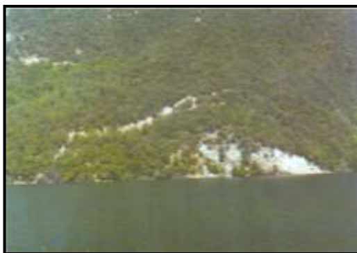
Εικόνα 4.1. Οι αυξομειώσεις της στάθμης της λίμνης στον ταμιευτήρα Ασωμάτων (Αλιάκμονας, Βέροια) και η στενή κοιλάδα με τις απότομες κλίσεις που παρουσιάζει, έχουν ενεργοποιήσει την αστάθεια των πρηνών (Κούκης και Σαμπατακάκης, 2007).
