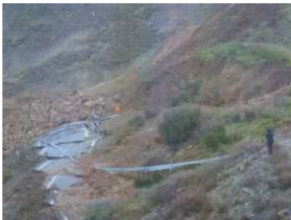
Εικόνα 5.10. Τμήμα του οδοστρώματος που μετακινήθηκε σε απόσταση της τάξης των 30m, κάτω από το αρχικό επίπεδο του αυτοκινητόδρομου (ΚΕΔΕ, 2003).
