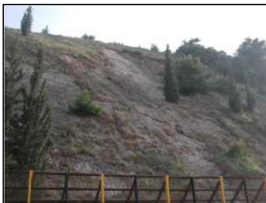
Εικόνα 5.3. Κατάπτωση των εδαφικών σχηματισμών στην επιφάνεια του πρανούς στην Ν.Ε.Ο. Το πρανές της Ε.Ο ταυτίζεται με την ρηξιγενή επιφάνεια της Παναγοπούλας ή αντίστοιχη παράλληλη η οποία ανήκει στην ίδια ρηξιγενή ζώνη (Υ.ΠΕ.ΧΩ.ΔΕ., 2002).
