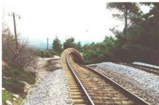
Εικόνα 5.6. Παραμόρφωση της σιδηροδρομικής γραμμής. από την κατολίσθηση της Μαλακάσας (Ρόζος κ.α., 1995).
