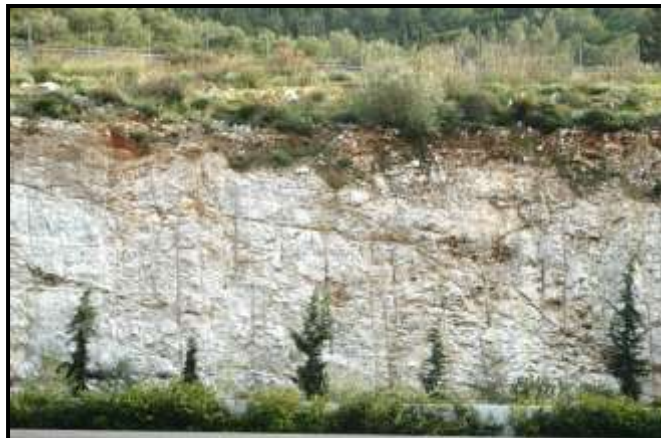
Εικόνα 3.1. Άποψη από ένα προδιατμημένο βραχώδες μέτωπο πρανούς στην Αττική Οδό (Σταθμός Διοδίων Κατεχάκη).
