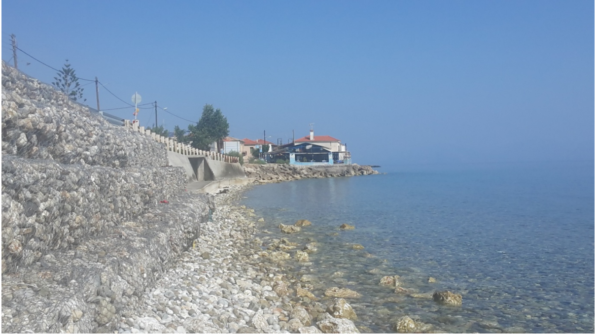
Σχήμα 3.24. Θωράκιση με συρματοκιβώτια η οποία έχει πραγματοποιηθεί στην παραλία της Πεταλούς. Στο βάθος εικονίζονται καταστήματα και οικίες εκτεθειμένα στην κυματική δράση
