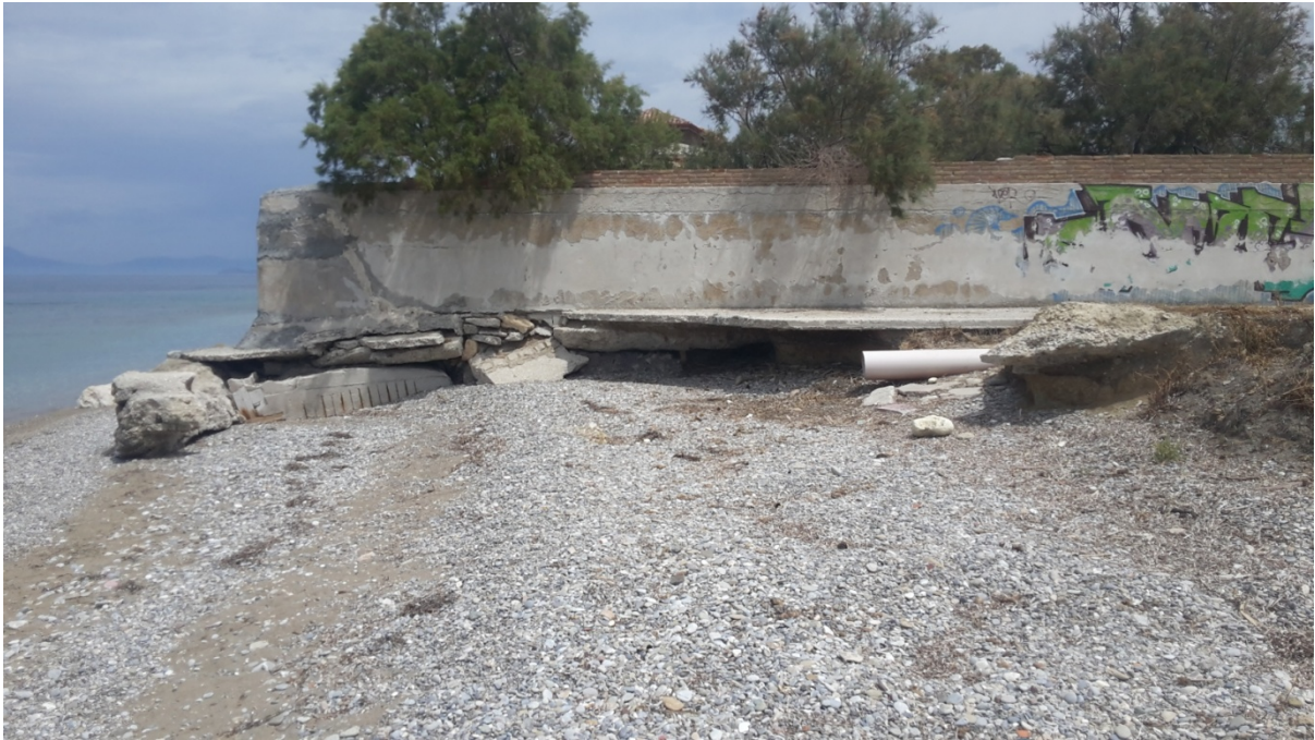
Σχήμα 3.20. Υποσκαφή σε οικίες στο Μελίσσι.
