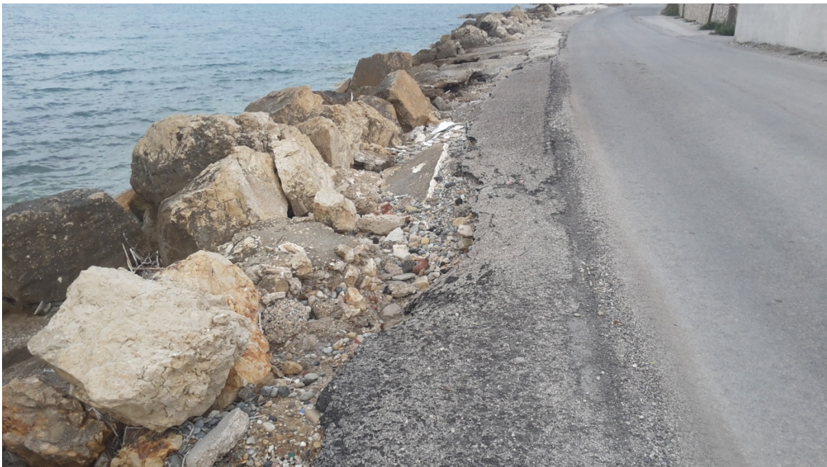
Σχήμα 3.7. Πλημμελλής θωράκιση και κατάρρευση τμήματος οδοστρώματος στην περιοχή Κάτω Άσσου
