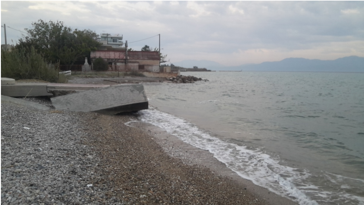
Σχήμα 3.13. Τμήμα πεζοδρόμου υπό κατάρρευση και θωράκιση παραθαλάσσιου τοιχίου με ογκόλιθους στο βάθος
