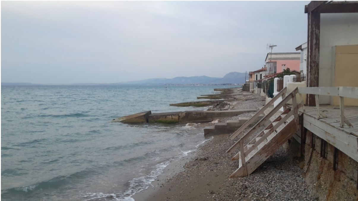
Σχήμα 3.11. Τμήμα προβόλου υπό κατάρρευση στην περιοχή Νεράτζας
