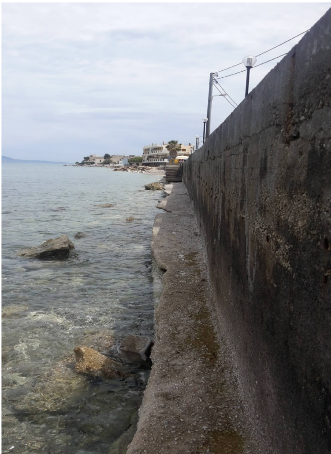
Σχήμα 3.21. Υποσκαφή στο τοίχιο της Π.Ε.Ο. Κορίνθου-Πατρών.
