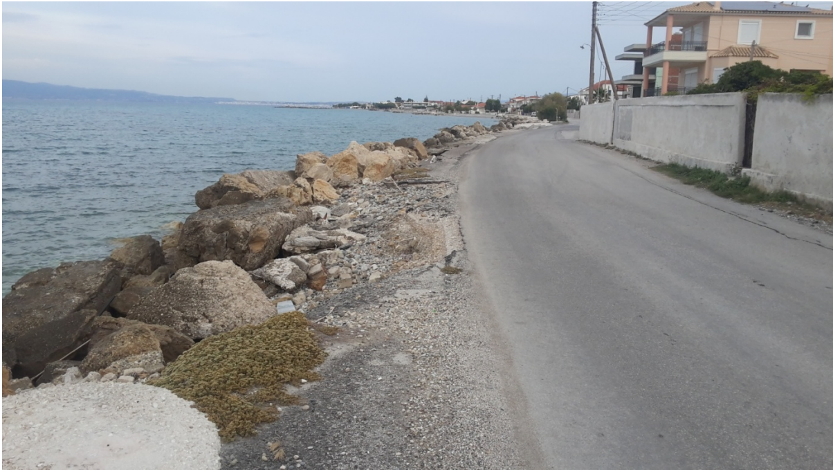
Σχήμα 3.8. Πλημελής θωράκιση και κατάρρευση τμήματος οδοστρώματος στην περιοχή Κάτω Άσσου
