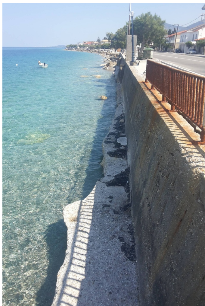
Σχήμα 3.23. Υπόσκαφη κατακόρυφου τοιχίου δρόμου εντός του οικισμού Λυκοποριάς.
