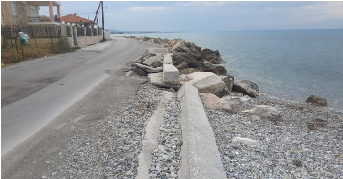
Σχήμα 3.10. Υποχώρηση τμήματος δρόμου και στηθαίου στην περιοχή Βραχατίου.
