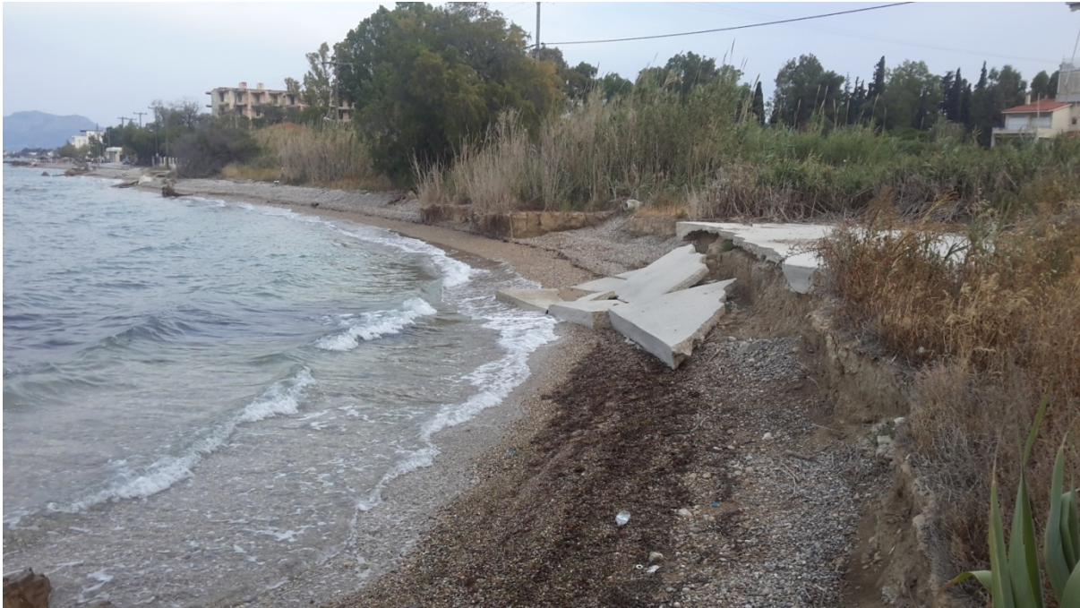
Σχήμα 3.15. Πτώση τμήματος ιδιοκτησίας στο Κοκκόνι Κορινθίας
