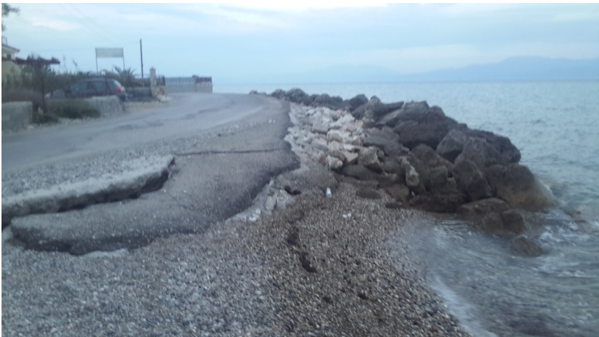
Σχήμα 3.17. Πτώση οδοστρώματος λόγω έλλειψης θωράκισης
