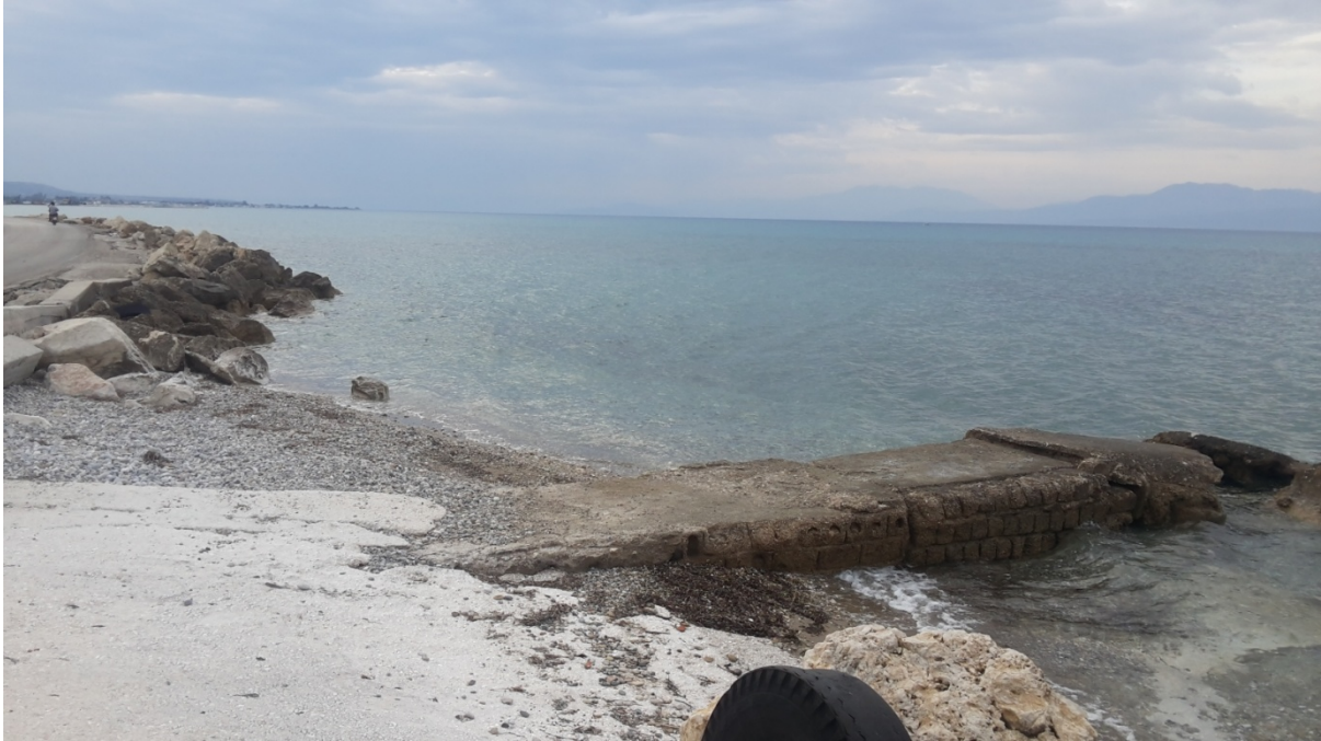
Σχήμα 3.9. Βυθισμένος πρόβολος στην περιοχή του Βραχατίου
