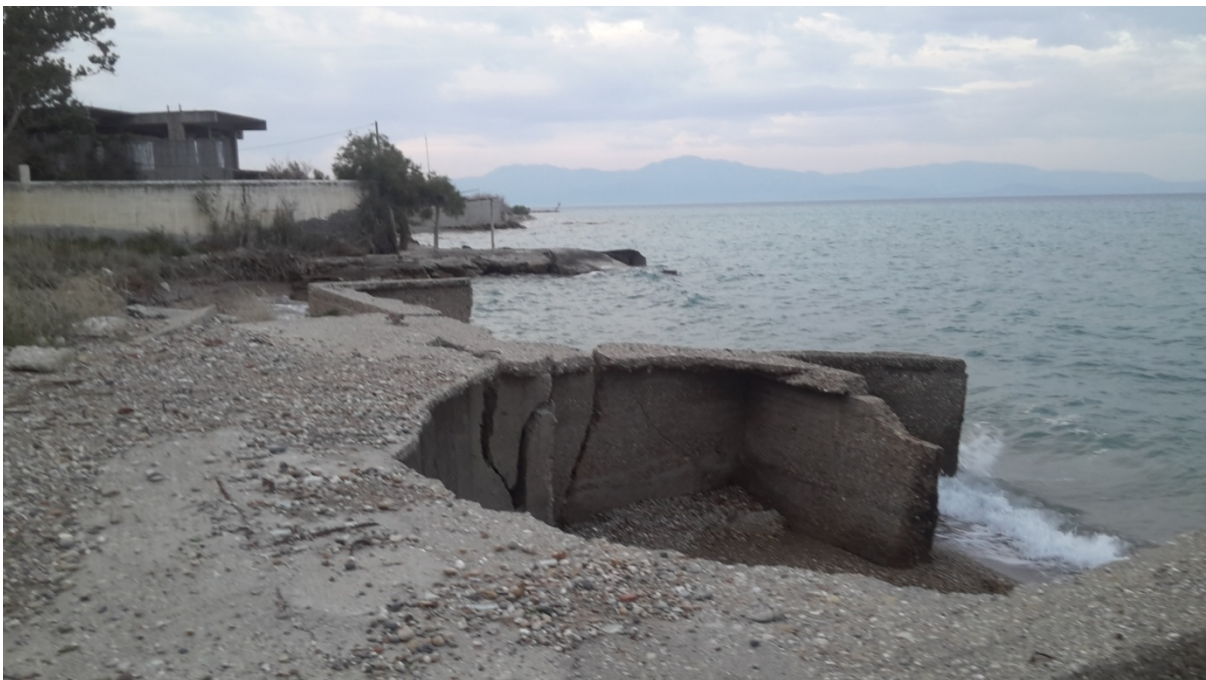
Σχήμα 3.14. Τμήμα εξωτερικού τοίχου κατασκευής υπό κατάρρευση στην περιοχή της Νεράτζας.
