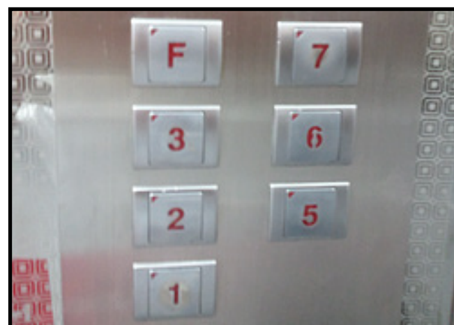
Εικ.122 Πίνακας ανελκυστήρα στη Σαγκάη
