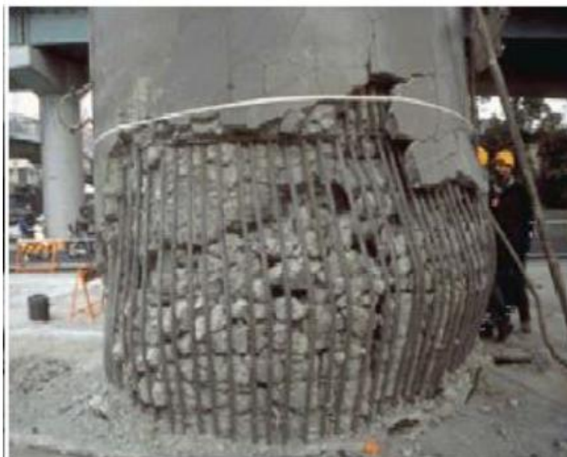
Εικόνα 2-2: Καμπτοδιατμητική αστοχία με σύνθλιψη [5]
