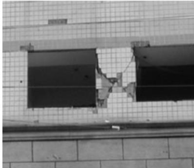
Εικόνα 2-1: Διατμητική αστοχία υποστυλώματος [5]
