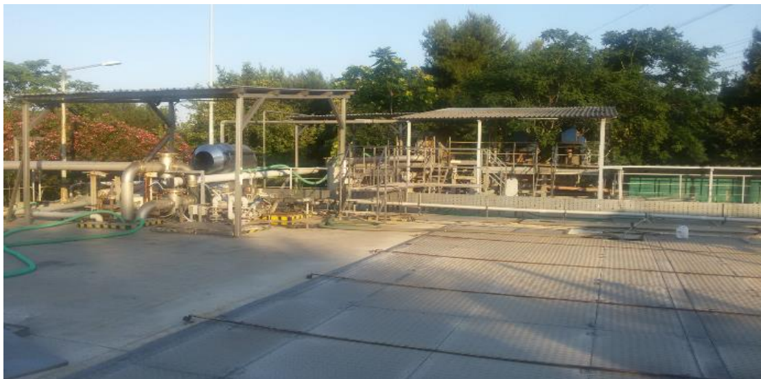
Εικόνα 2. 3 Η μονάδα επεξεργασίας λυμάτων της TASTY FOODS A.E
