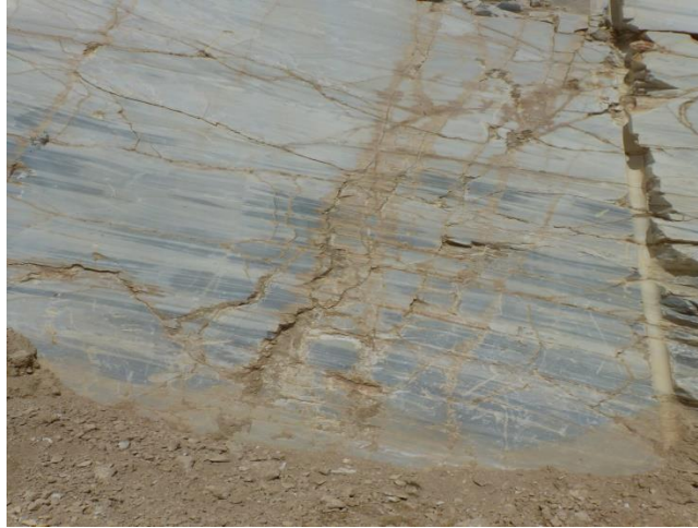
Εικόνα 6.6bbb: Επιφάνεια του μελετώμενου μετώπου μαρμάρου, όπου οι ρωγματώσεις και οι φθορές λόγω της εξόρυξης είναι εμφανείς.( Λατομείο Διονύσου, Ιανουάριος 2016)
