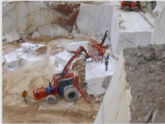
Εικόνα 2.12α: Διάτρηση όγκου προς ορθογωνισμό με υδραυλική σφύρα προσαρμοσμένη σε αυτομεταφερόμενο φορείο (τρακτέρ Ford)
