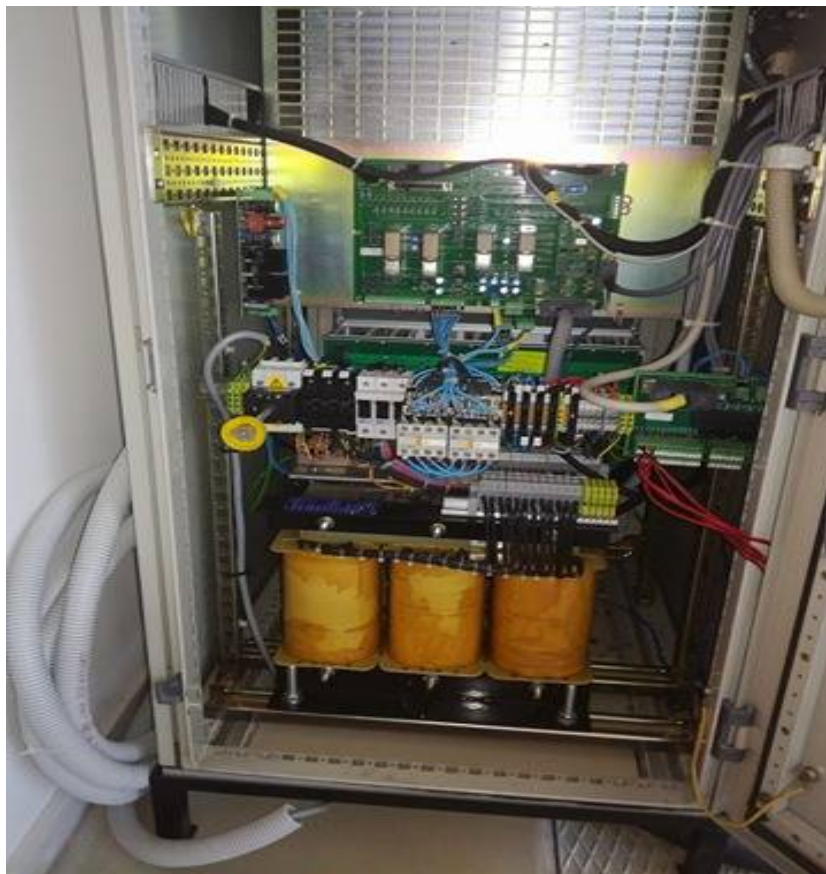
Εικόνα 2.6: Το εσωτερικό του ελεγκτή CS7
