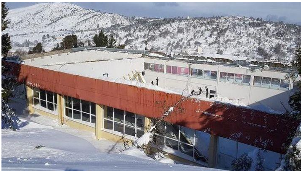
Σχήμα 3.1: Κατάρρευση της στέγης του κλειστού γυμναστήριου της Κύμης λόγω χιονιού
