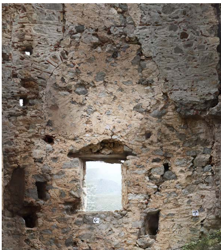
εικ. 40, Ορθοεικ. της εσωτερικής όψης του νότιου τοίχου του πύργου, Γ' όροφος. Το γκριζωπό επίχρισμα με τις χαρακτηριστικές μυστριές ανήκει στην αρχική κατασκευή, ενώ η τοιχοποιία της Β' φάσης με το ωχρό επίχρισμα σχηματίζει και το παράθυρο και είναι εμφανές πως έχει έρθει να καλύψει προηγούμενες οπές μεγάλων διαστάσεων στις όψεις
