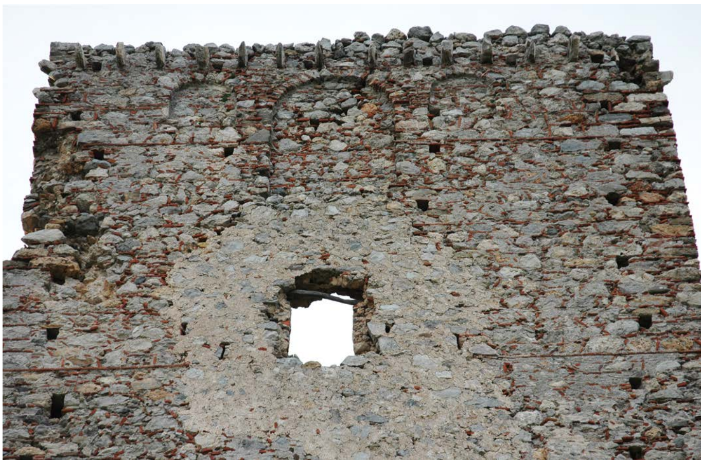
εικ. 37, Ανατολική όψη του κεντρικού πύργου του κάστρου Ζαραφώνας. Οι κιλλίβαντες της επίστεψης.
