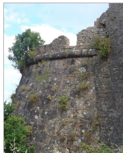
Εικ. II.Γ.19: Η ρωγμή στη βόρεια πλευρά
