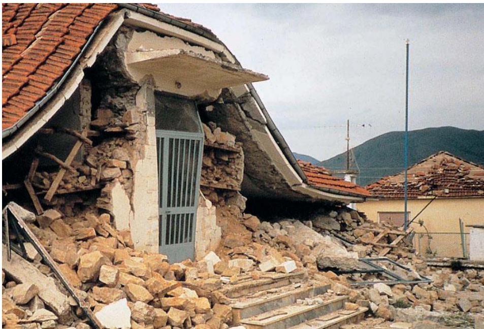
Εικόνα 1.1: Κατάρρευση κτιρίου λόγω σεισμικής διέγερσης
