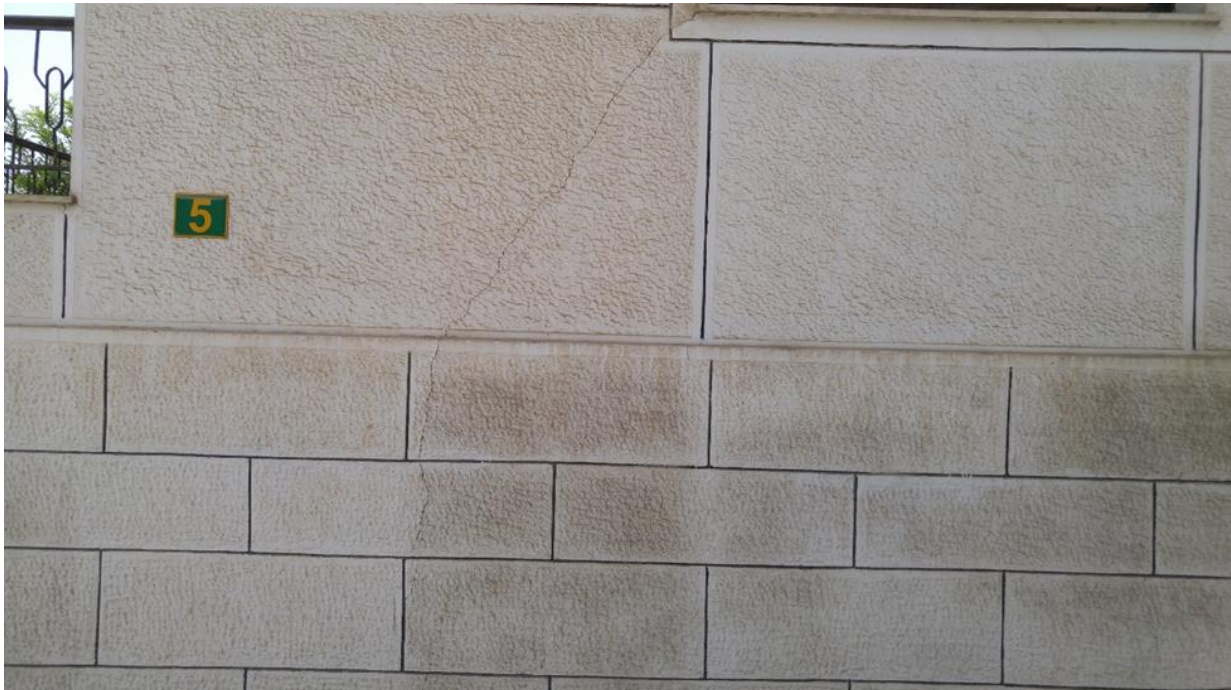
Εικόνα 4.4.26 Αριθμός 24: Ρωγμή 45° σε τοιχοποιία κύριας όψης κτιρίου με επέκταση στην επικάλυψη αυτής στην οδό Αγίου Κηρύκου
