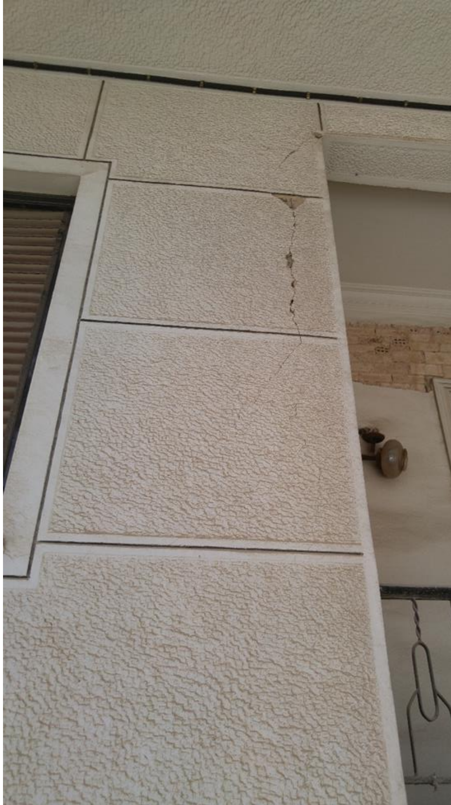
Εικόνα 4.4.27 Αριθμός 25: Εκτεταμένες ρωγμές τοιχοποιίας στον ημιώροφο κατασκευής της εικόνας 4.4.26 στην οδό Αθηνογένους
