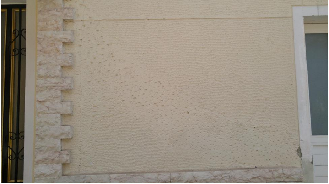
Εικόνα 4.4.76 Αριθμός 69: Ρωγμή με επένδυση επιχρίσματος σε τοιχοποιία κύριας όψης μονοκατοικίας της οδού Απολλωνίας
