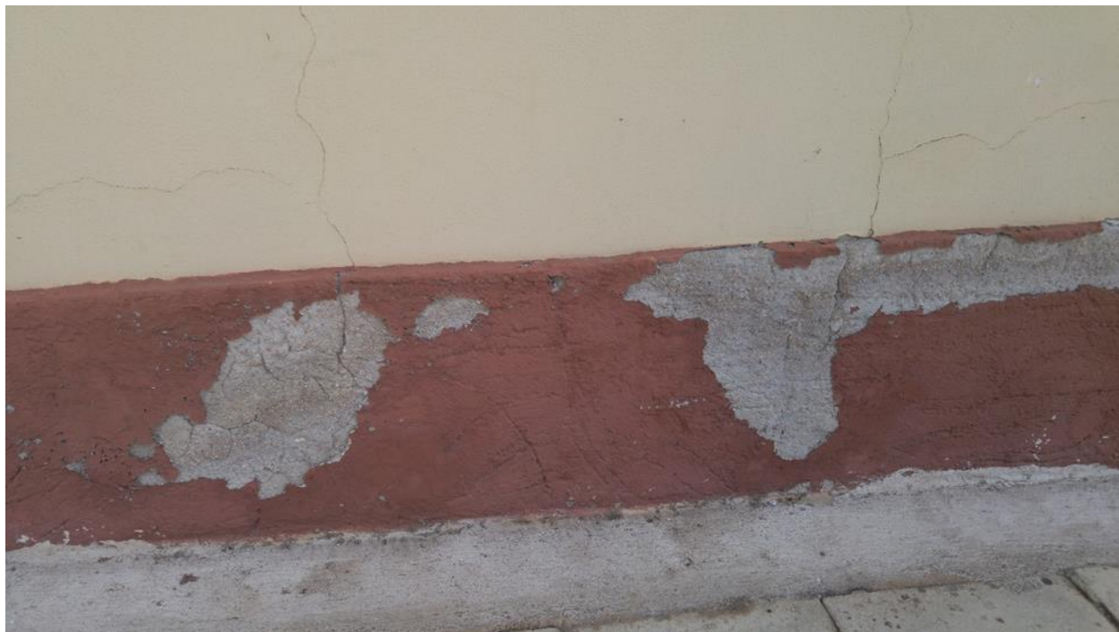
Εικόνα 4.4.24 : Αριθμός 22: Εκτεταμένες ρωγμές στην τοιχοποιία στο κάτω μέρος δυτικής όψης με επέκταση στο τοίχιο σκυροδέματος στην οδό Αγίου Κηρύκου
