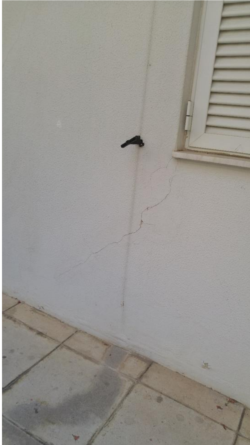
Εικόνα 4.4.57 Αριθμός 52: Εκτεταμένη ρωγμή αριστερά του κουφώματος δυτικής όψης μονοκατοικίας με επέκταση στο πεζοδρόμιο της οδού Αμαλιάδος
