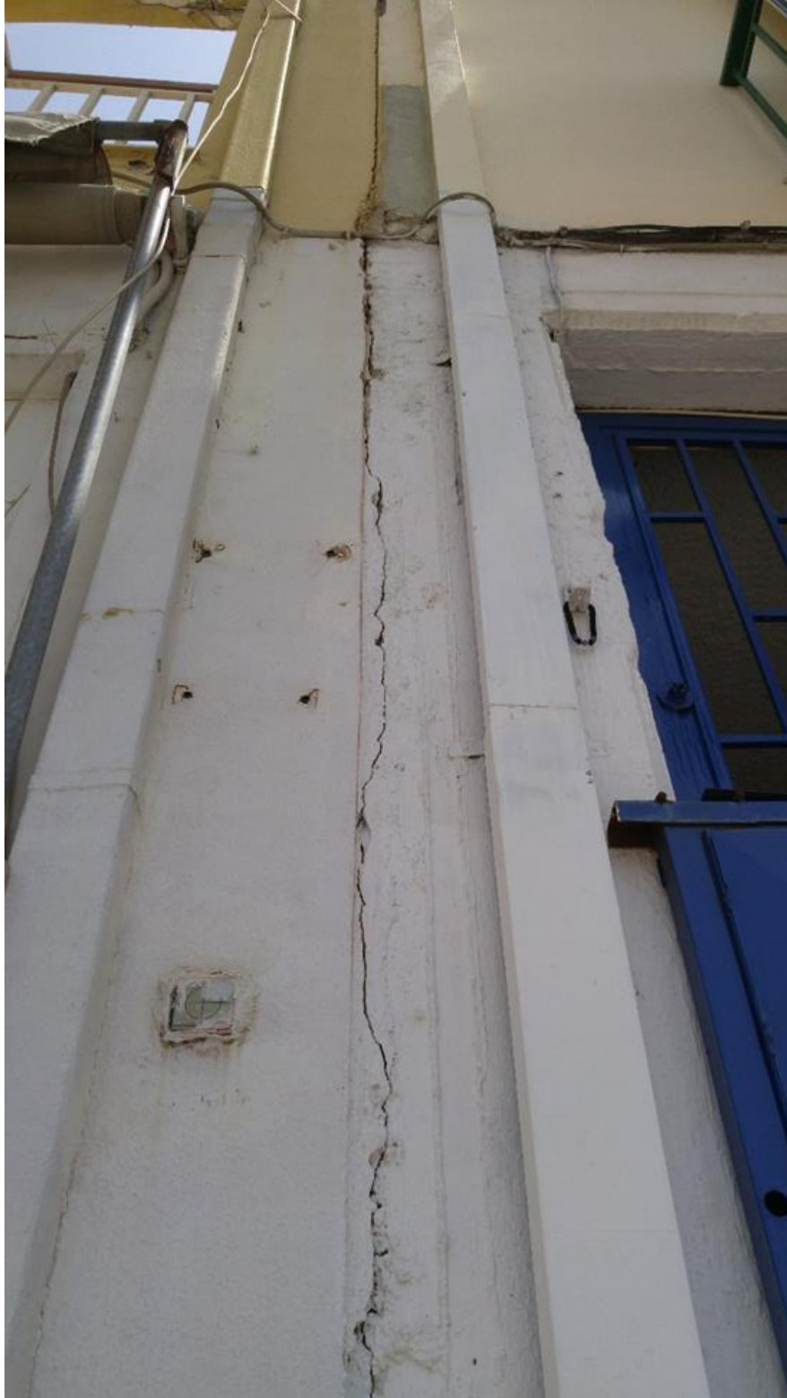
Εικόνα 4.4.21 Αριθμός 20: Κατακόρυφη ρωγμή μεταξύ δυο πολυκατοικιών στην οδό Αγίου Κηρύκου
