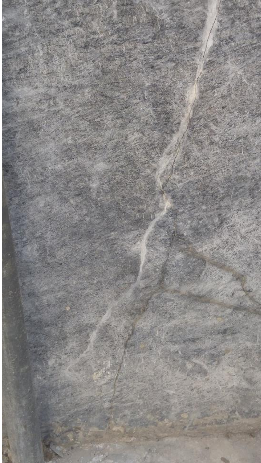
Εικόνα 4.4.48 Αριθμός 44: ρωγμή γωνίας 45° κατά μήκος της ορθομαρμάρωσης σε κολόνα νότιας όψης πολυκατοικίας στην οδό Αγρινίου
