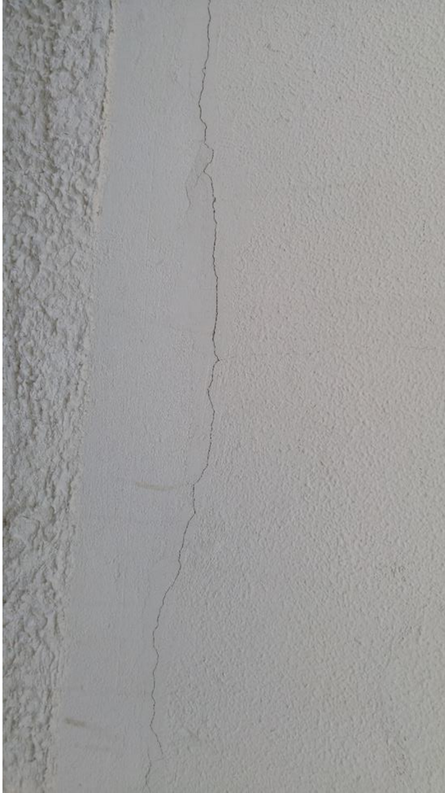
Εικόνα 4.4.17 Αριθμός 15: Κατακόρυφη ρωγμή σε δυτική όψη σε τοιχοποιία διάροφης κατασκευής στην οδό Καρκαβίτσα
