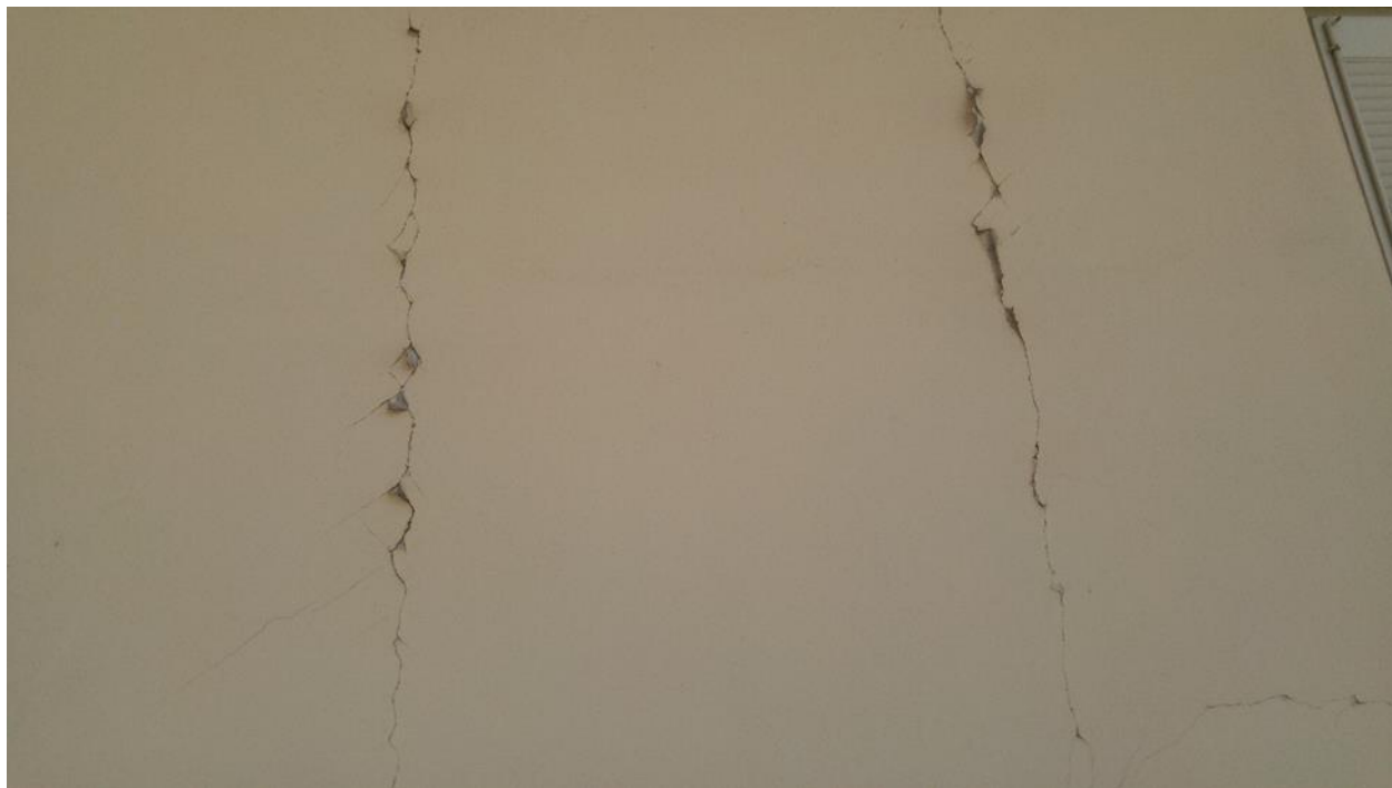
Εικόνα 4.4.23 Αριθμός 21: Κατακόρυφες ρωγμές στην τοιχοποιία δυτικής όψης πολυκατοικίας στην οδό Αγίου Κηρύκου
