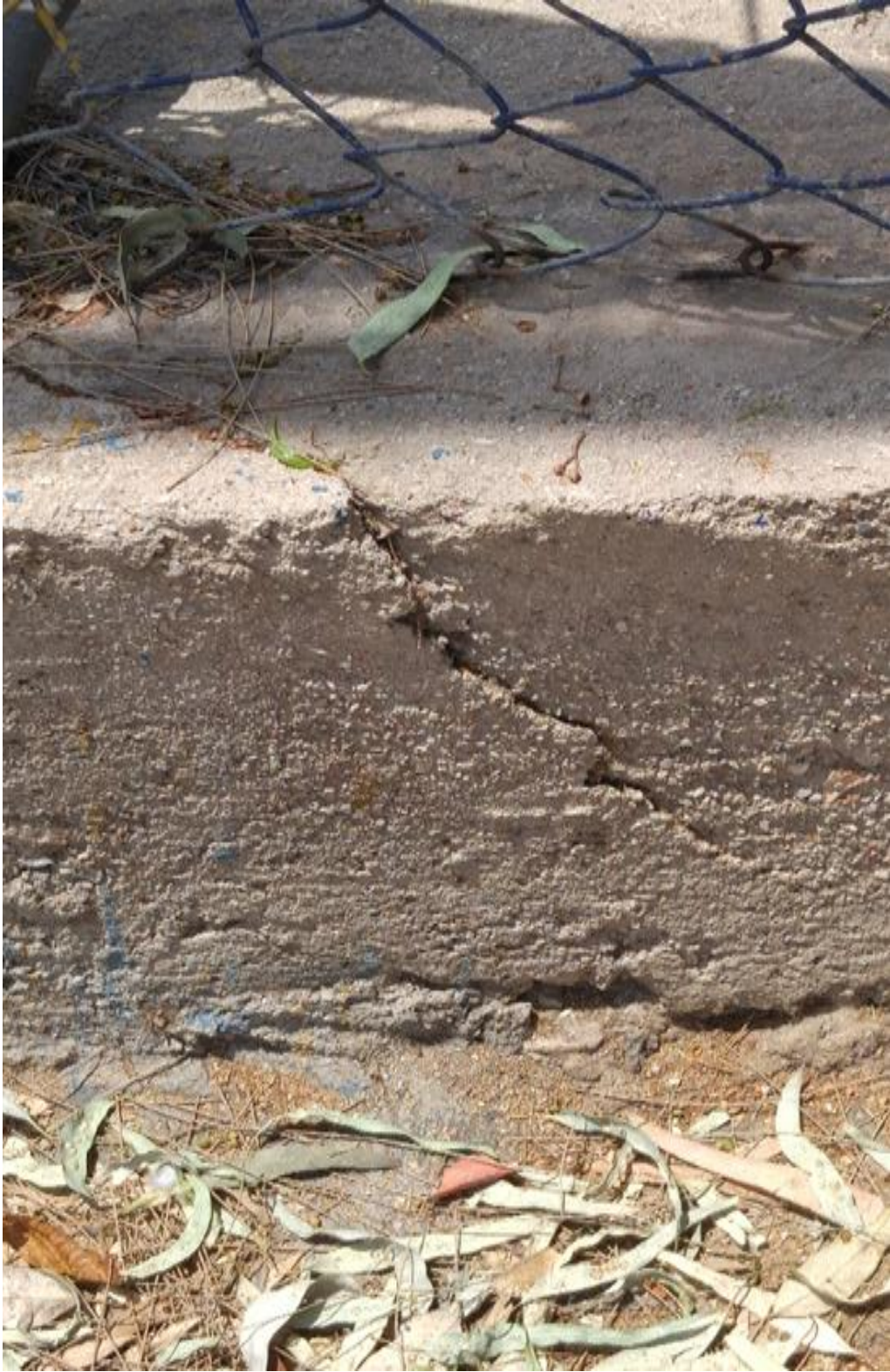
Εικόνα 4.4.106 Αριθμός 96: Ρωγμή γωνίας 45° σε κράσπεδο πεζοδρομίου της οδού Θηβών
