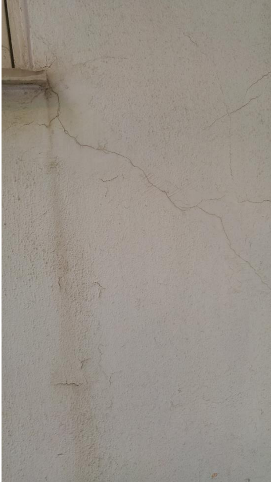
Εικόνα 4.4.74 Αριθμός 67: Τριχοειδής ρωγμή σε τοιχοποιία γωνίας 45° στο αριστερό τμήμα του κουφώματος πολυκατοικίας στην οδό Αγίας Μαρίνας
