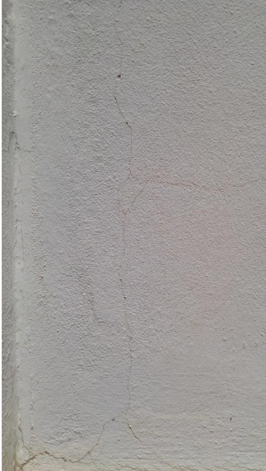
Εικόνα 4.4.9 Αριθμός 8: Κατακόρυφη ρωγμή χαμηλά της μπροστινής όψης μονοκατοικίας στην οδό Αγίου Ιεροθέου
