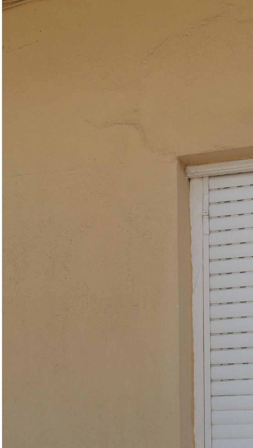
Εικόνα 4.4.60 Αριθμός 54: Ρωγμή 45° στο άνω τμήμα κουφώματος πολυκατοικίας στην οδό Αροανίας
