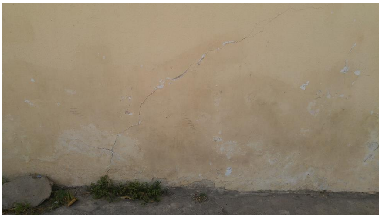
Εικόνα 4.4.37 Αριθμός 34: Ρωγμή γωνίας 45° στην κύρια όψη πολυκατοικίας στην οδό Αθηνογένους
