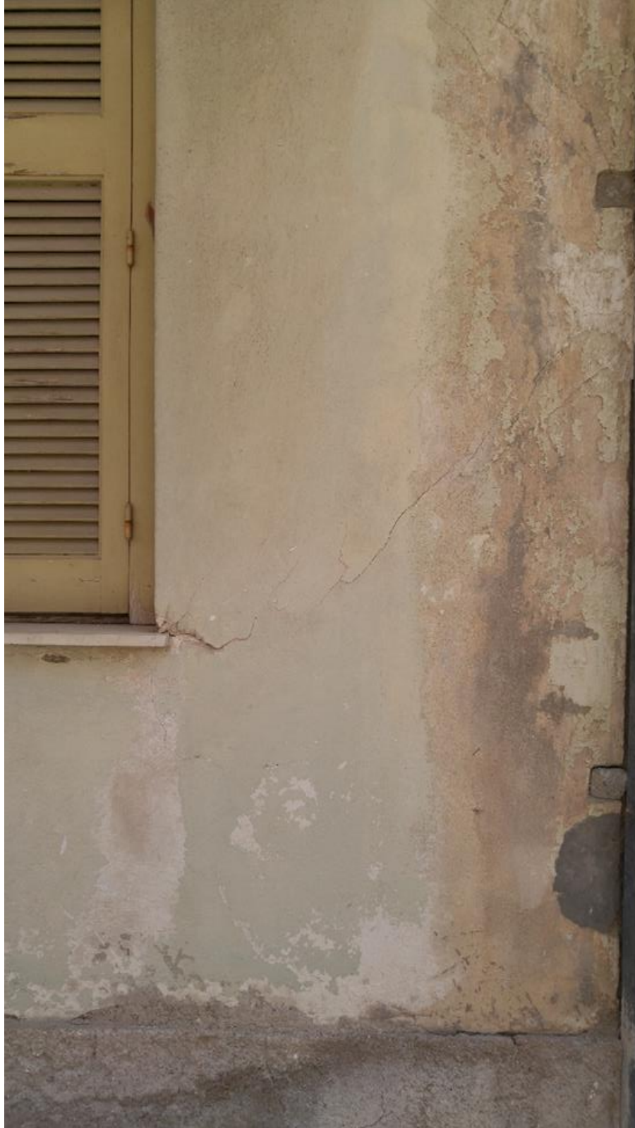
Εικόνα 4.4.87 Αριθμός 79: Διευρυνόμενη ρωγμή γωνίας 45° σε τοιχοποιία κύριας όψης μονοκατοικίας στην οδό Αμφιπόλεως με επέκταση του φαινομένου στην κάτω επένδυση άοπλου σκυροδέματος
