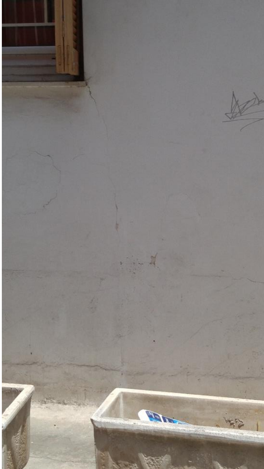
Εικόνα 4.4.75 Αριθμός 68: Ρωγμή σε τοιχοποιία που επεκτείνεται έως τη βάση της νότιας όψης μονοκατοικίας της οδού Αγίας Μαρίνας. Επιπλέον παρατηρούνται δευτερεύουσες τριχοειδείς ρωγματώσεις της τοιχοποιίας και του επιχρίσματος
