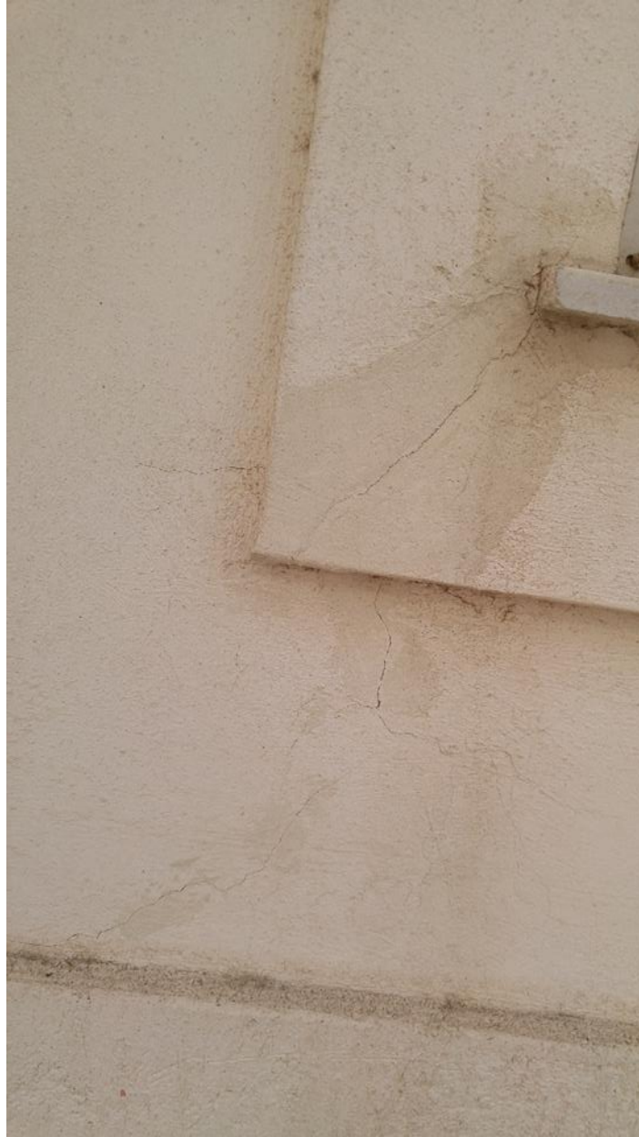
Εικόνα 4.4.66 Αριθμός 60: Ρωγμή γωνίας 45° στο αριστερό τμήμα του κουφόματος της νότιας όψης κατοικίας στην οδό Αρτεμισίου
