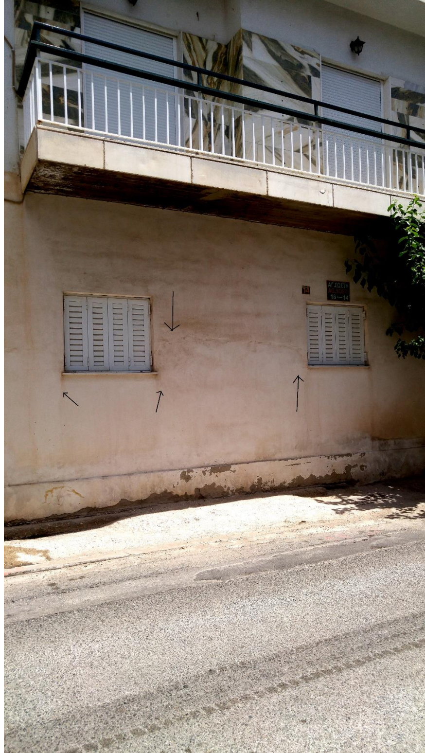
Εικόνα 4.4.77 Αριθμός 70: Εκτεταμένη ρωγμή σε τοιχοποιία ενδιάμεσα των κουφωμάτων κατά μήκος της πλάγιας όψης κατοικίας στην οδό Αμαλιάδος. Επιπλέον παρατηρούνται δευτερεύουσες ρωγματώσεις γωνίας 45^\circ στις ακμές των κουφωμάτων
