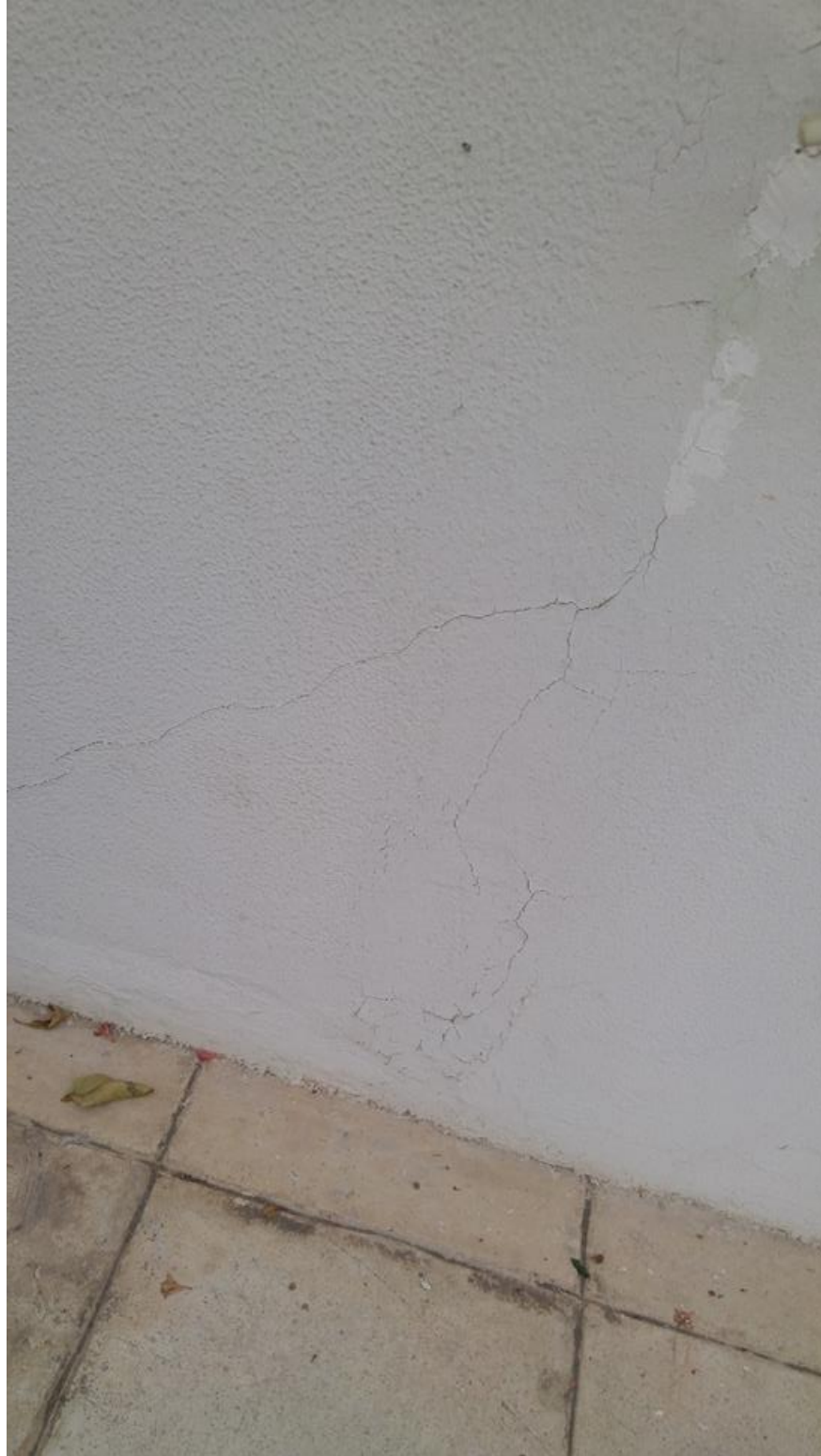
Εικόνα 4.4.58 Αριθμός 52: Τριχοειδής ρωγή γωνίας 45° σε τοιχοποιία αριστερά του κουφώματος δυτικής όψης πολυκατοικίας στην οδό Αμαλιάδος
