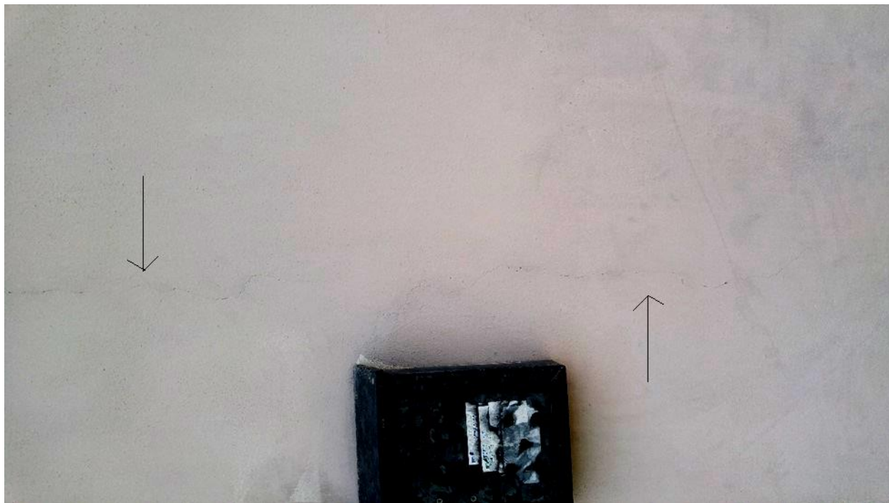
Εικόνα 4.4.19 Αριθμός 18: Οριζόντια ρωγή στην κύρια όψη μονοκατοικίας στην οδό Αγίου Κηρύκου
