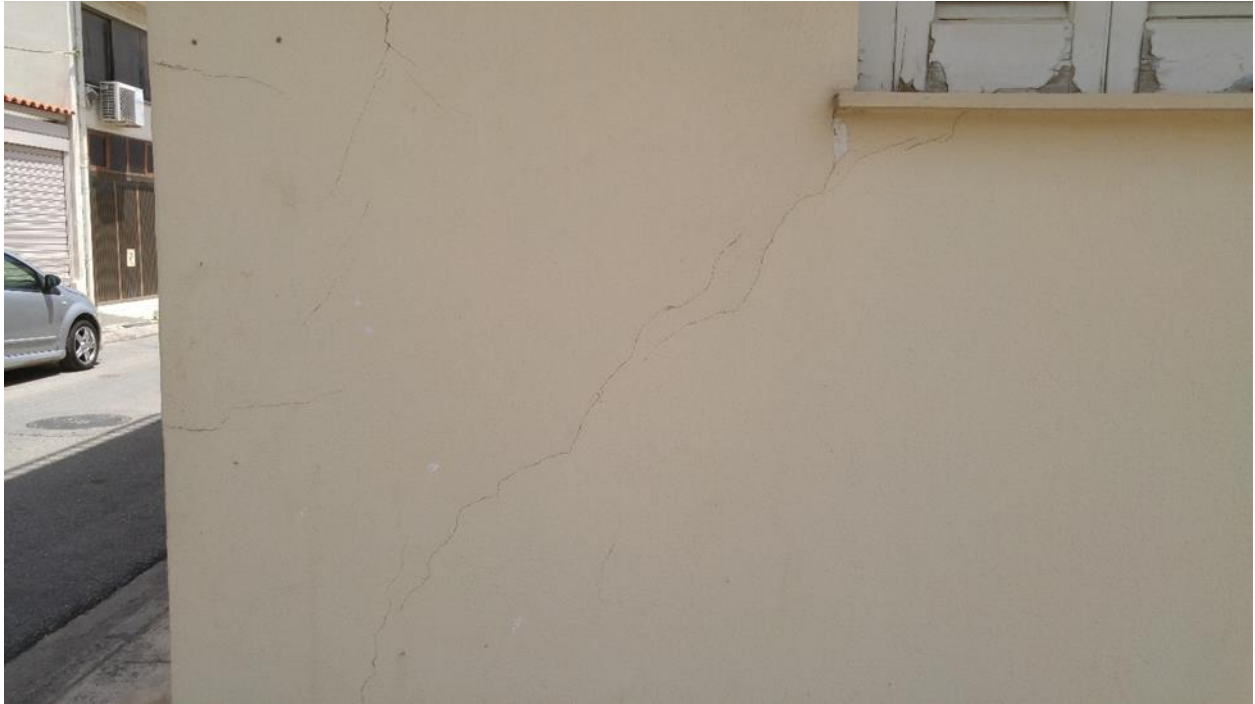
Εικόνα 4.4.25 Αριθμός 23: Ρωγμή 45° αριστερά του κουφώματος σε πολυκατοικία στην οδό Αθηνογένους
