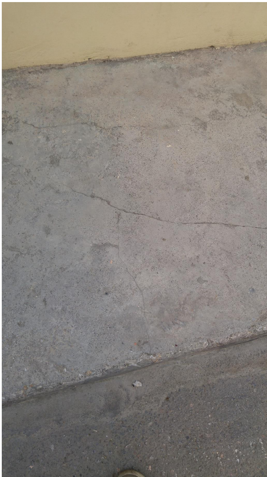
Εικόνα 4.4.59 Αριθμός 53: Τριχοειδής ρωγμή σε πεζοδρόμιο της οδού Αροανίας
