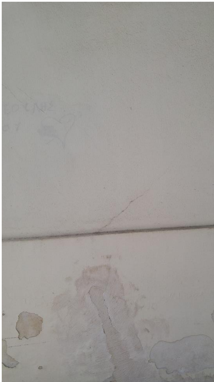
Εικόνα 4.4.51 Αριθμός 47: Ρωγμές σε τοιχοποιία πλάγιας όψης κτιριακής κατασκευής με επέκταση στην επικάλυψη άοπλου σκυροδέματος στην οδό Αγίας Μαρίνας
