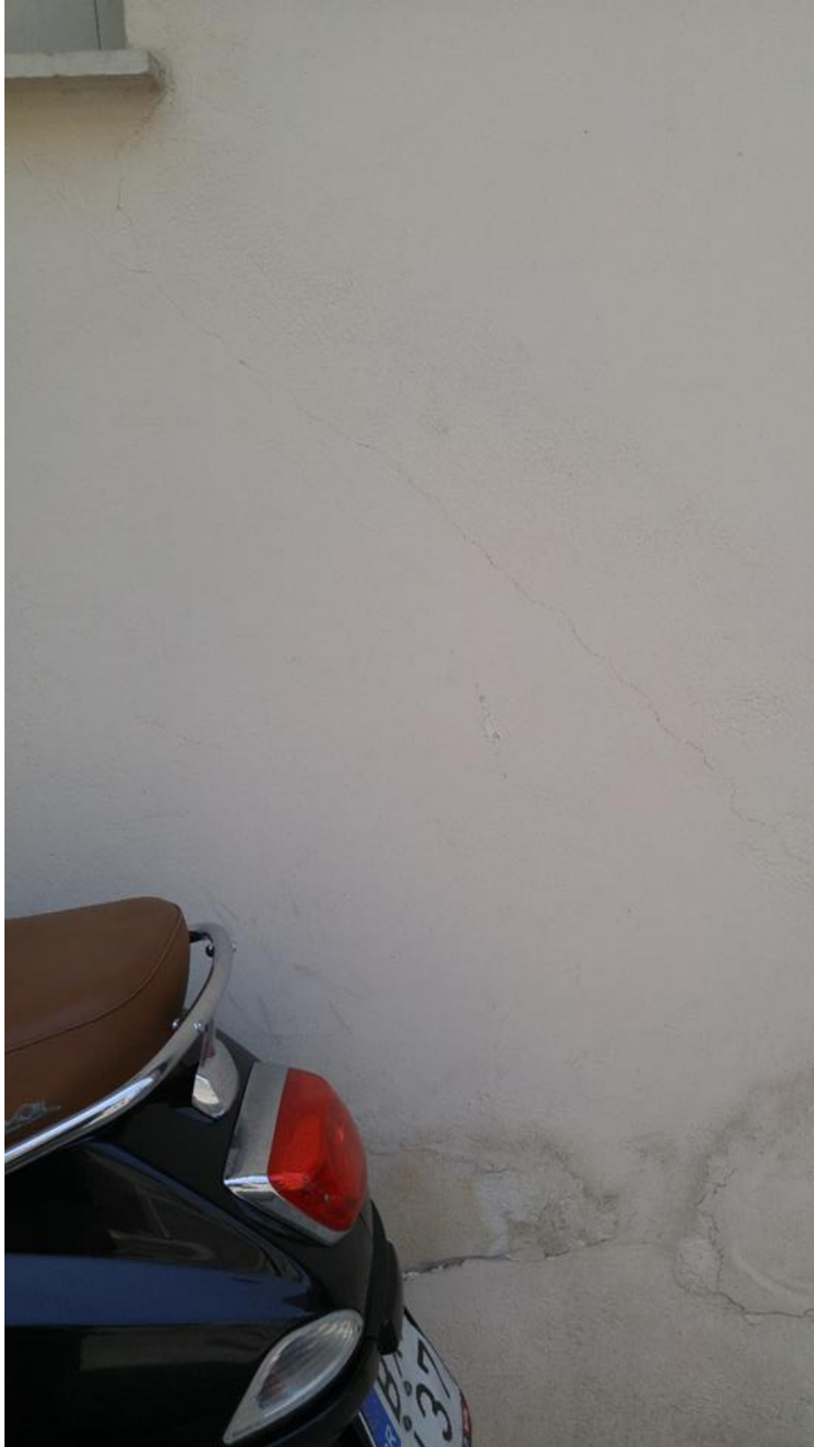
Εικόνα 4.4.84 Αριθμός 76: Εκτεταμένη ρωγμή κατά μήκος τοιχοποιίας που εμφανίζεται στο κάτω μέρος του κουφώματος ανατολικής όψης διάδροφης κατοικίας στην οδό Αμφιπόλεως
