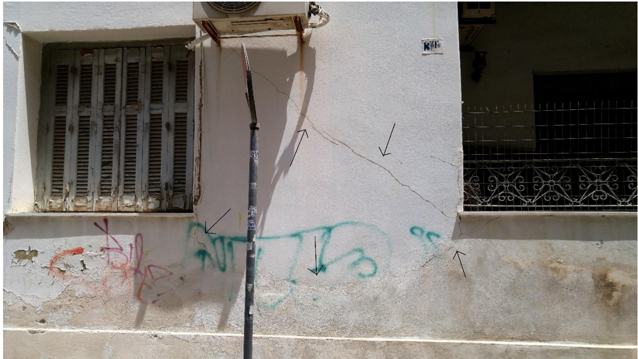
Εικόνα 4.4.65 Αριθμός 59: Ρωγμές γωνίας 45^\circ σε τοιχοποιία κύριας όψης κατοικίας στην οδό Αθηνών. . Παρατηρείται ρωγμή στο άνω δεξιό τμήμα του κουφώματος, η οποία συναντά διαφορετική ρωγμή με αφετηρία το αριστερό τμήμα του τοιχίου του μπαλκονιού. Επιπλέον, διαφορετικές ρωγμές ξεκινούν στο κάτω δεξιό τμήμα του κουφώματος καθώς και στο κάτω αριστερό τμήμα του προαναφερθέντος τοιχίου
