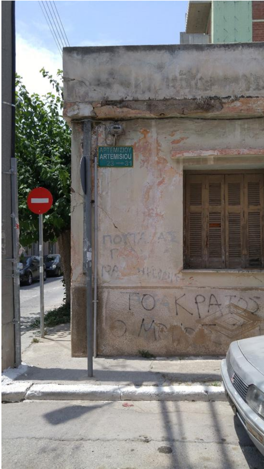
Εικόνα 4.4.102 Αριθμός 92: Ρωγμή γωνίας 45° σε φέρουσα τοιχοποιία κύριας όψης σε μονοκατοικία στην οδό Αρτεμισίου
