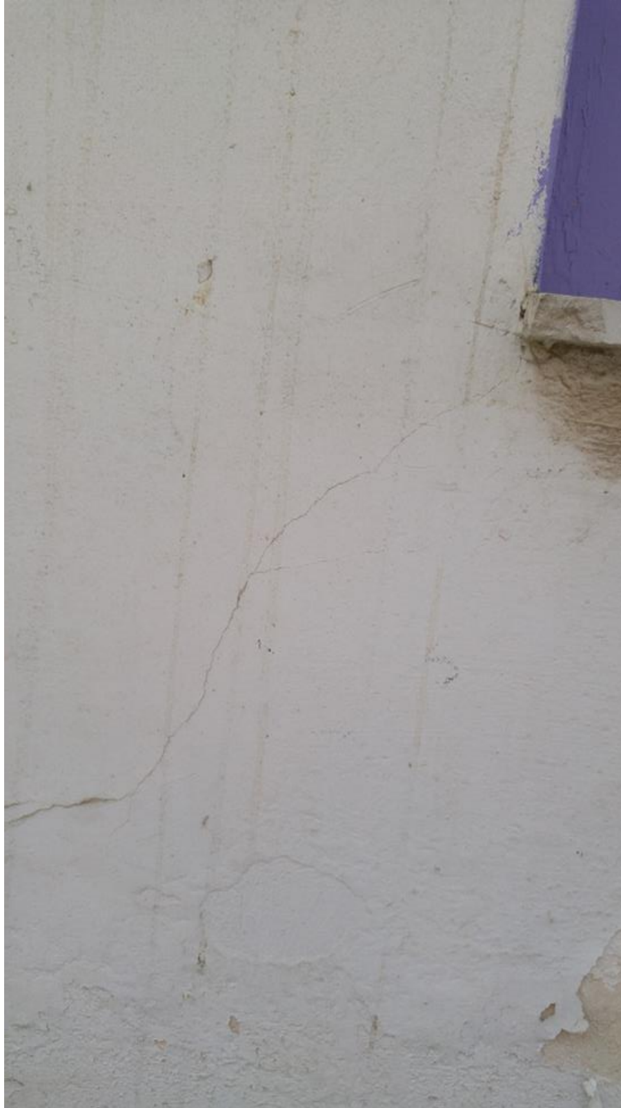
Εικόνα 4.4.80 Αριθμός 72: Ρωγμή γωνίας 45° σε τοιχοποιία κύριας όψης κατοικίας στην οδό Δεστούνη
