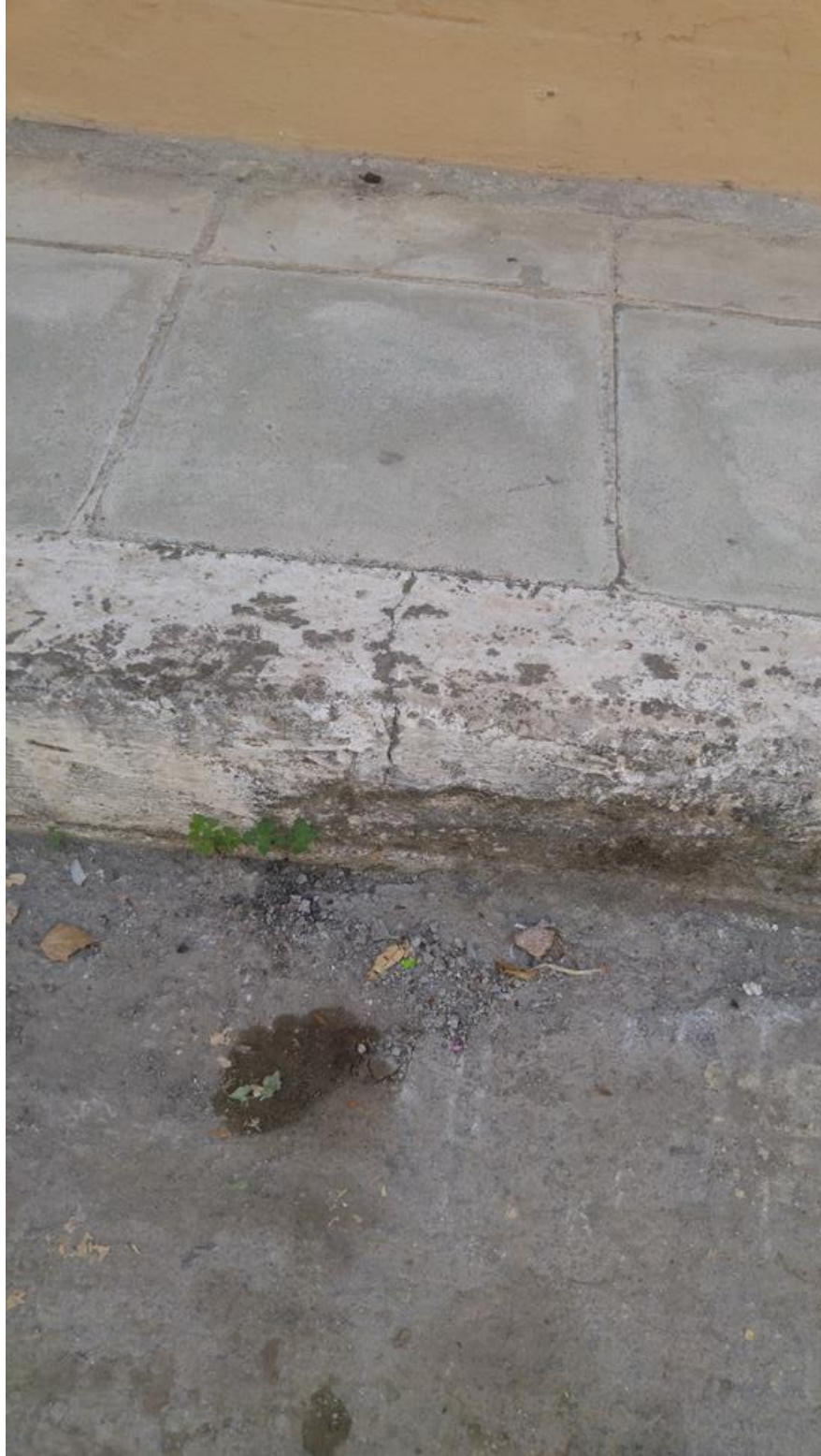
Εικόνα 4.4.49 Αριθμός 45: Αστοχία κρασπέδου με ελαφριά επέκταση στο οδόστρωμα της οδού Αγρινίου
