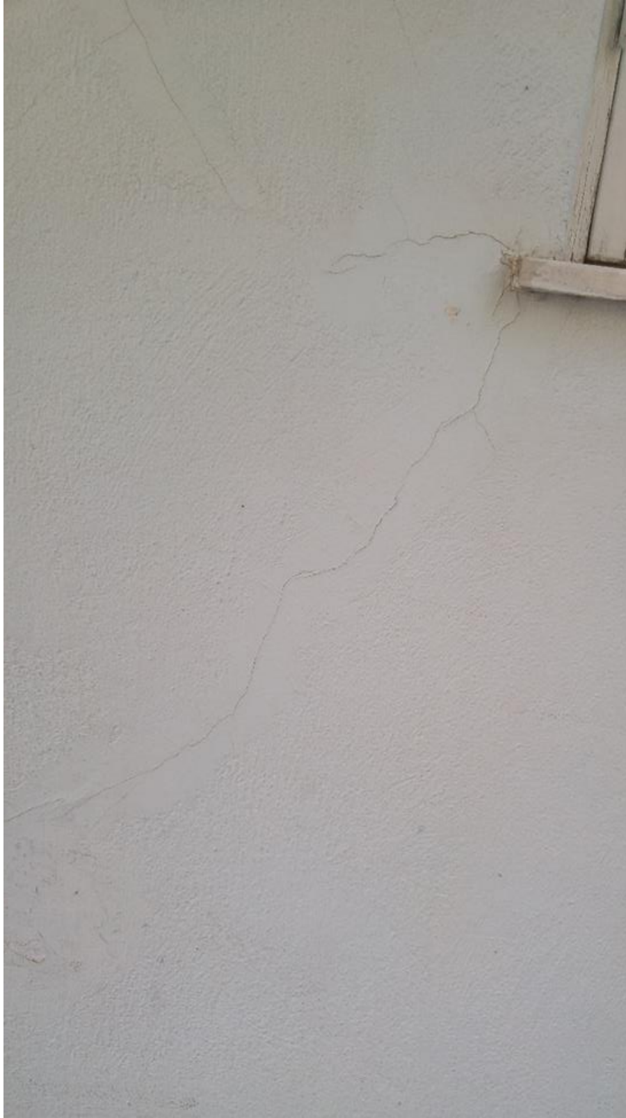
Εικόνα 4.4.72 Αριθμός 65: Τριχοειδείς ρωγμές σε τοιχοποιία κατοικίας της οδού Αγίας Μαρίας
