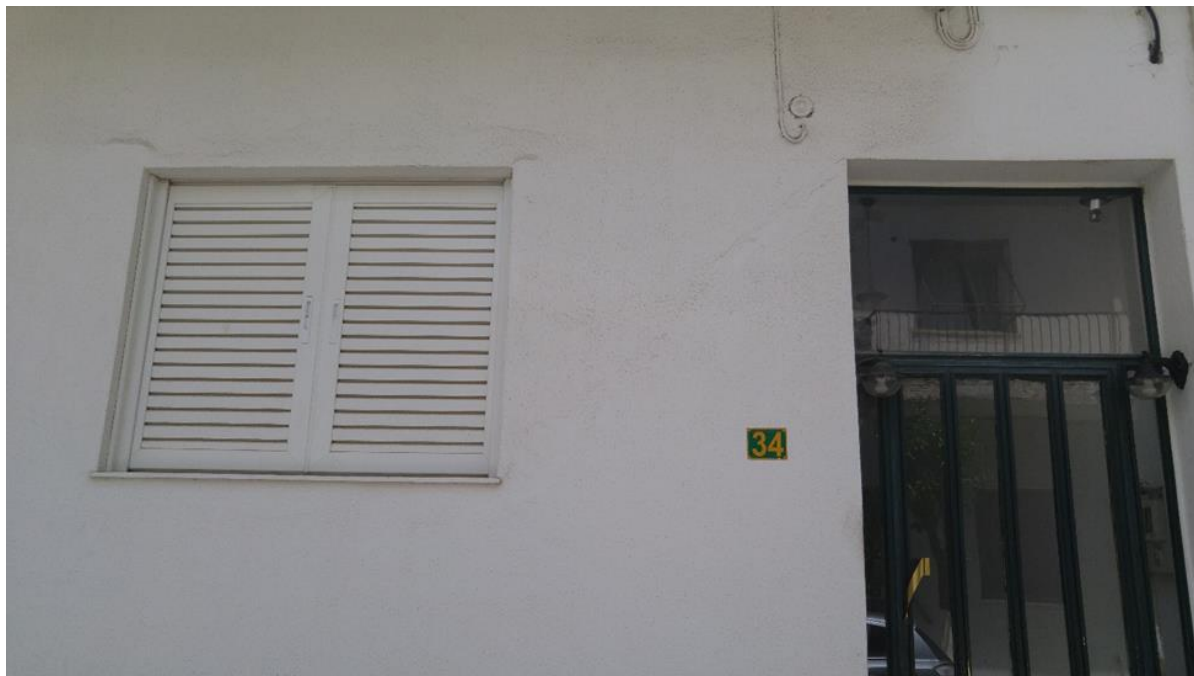
Εικόνα 4.4.63 Αριθμός 57: ρωγμές γωνίας 45° αριστερά του άνω μέρους του κουφώματος και αριστερά της πόρτας. Οι ρωγμές παρατηρούνται στην τοιχοποιία κατοικίας της οδού Αρτεμισίου
