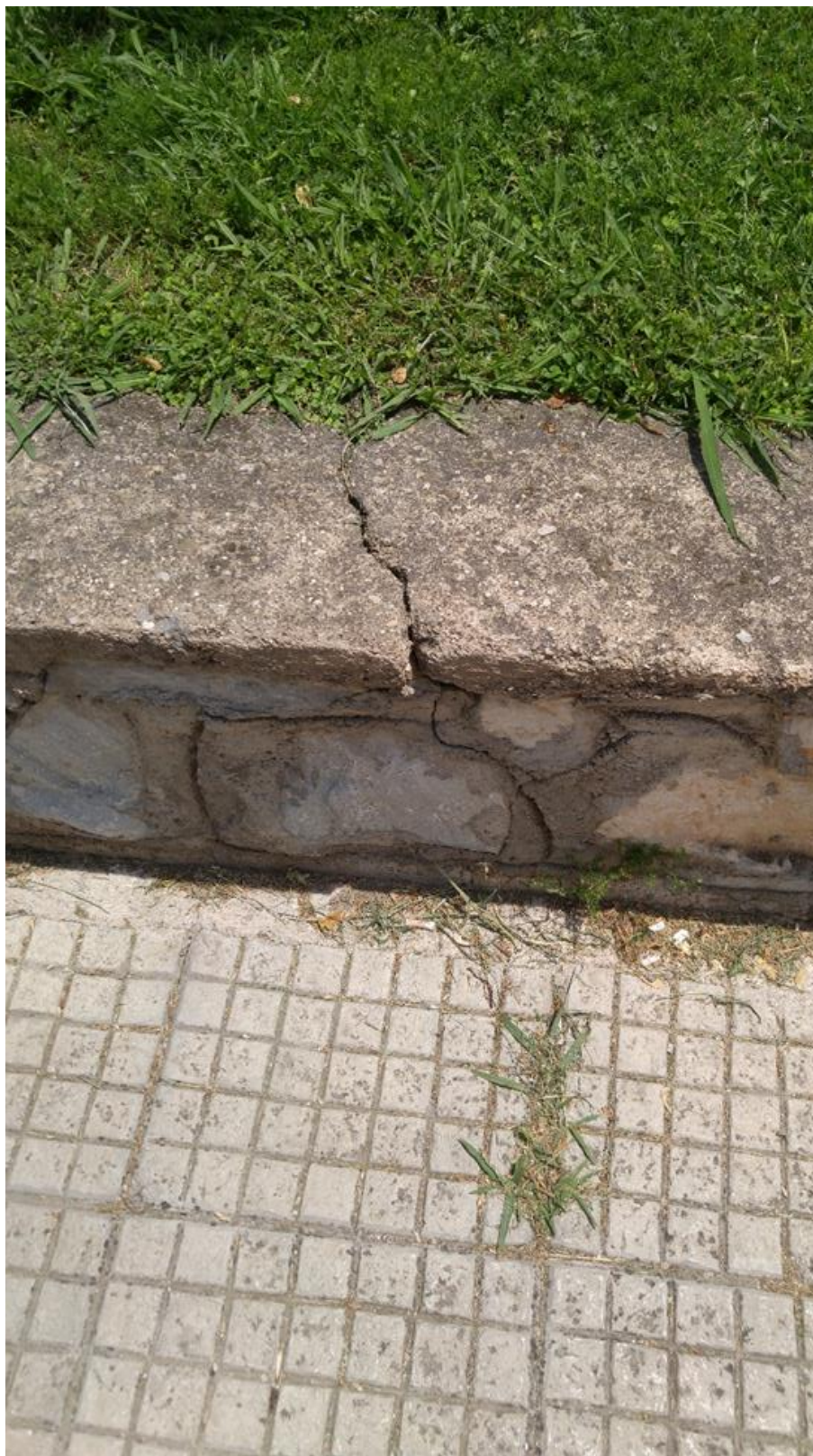
Εικόνα 4.4.97 Αριθμός 88: Συνέχεια ρωγμών πέτρινου τοιχίου των παραπάνω εικόνων στην οδό Αορανίας. Η ύπαρξη φυτών μεταξύ των πλακών του πεζοδρομίου σκιαγραφεί υποψία συνέχισης της ρωγμής στον αρμό τους
