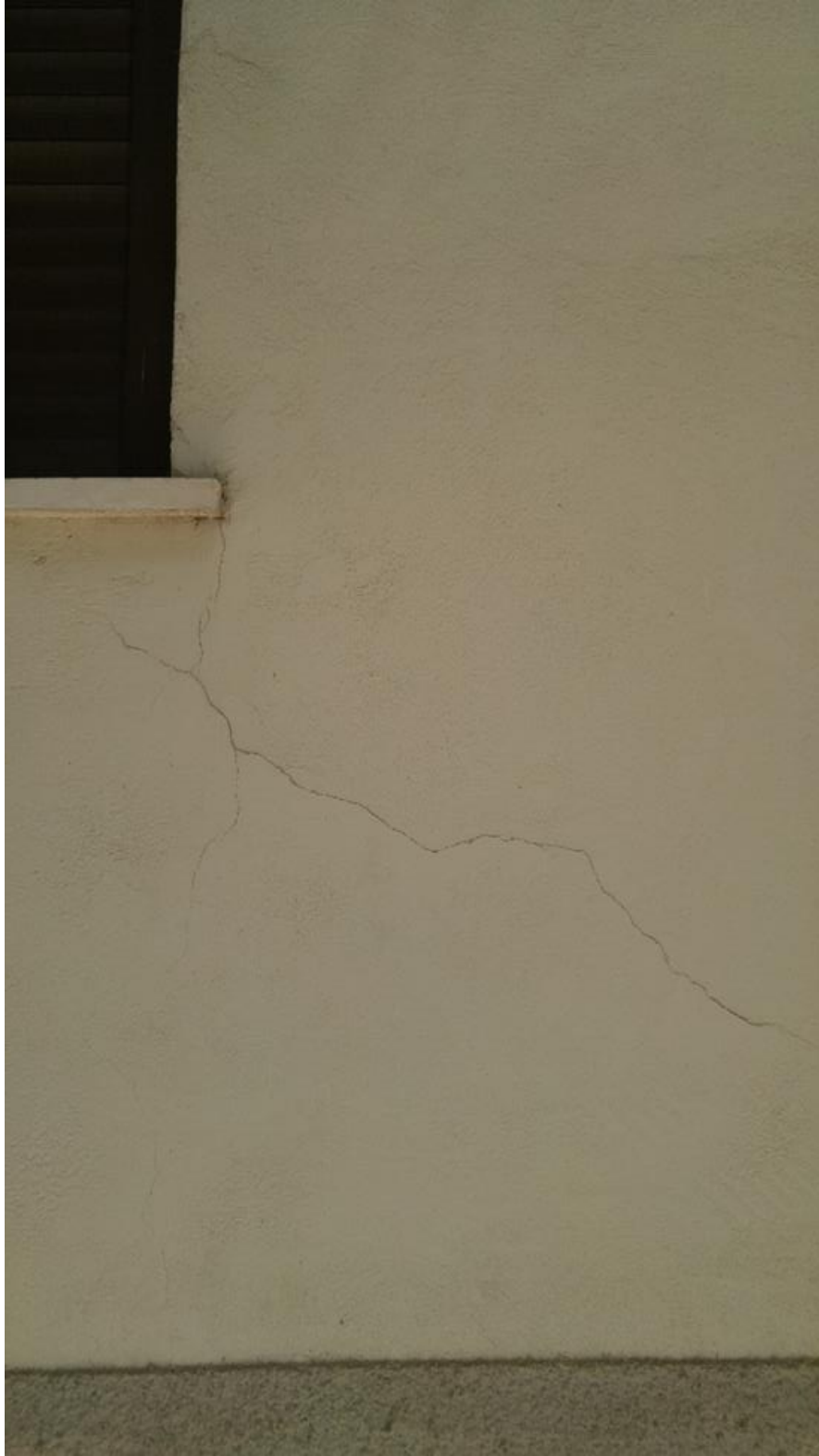
Εικόνα 4.4.6 Αριθμός 5: Ρωγμή σε κούφωμα βόρειας όψης τριώροφης πολυκατοικίας στην οδό Πάριδος
