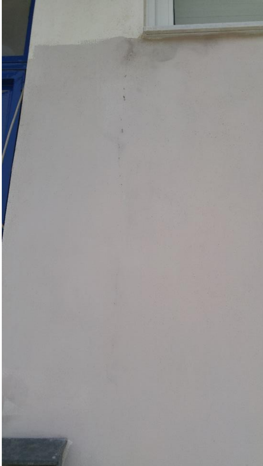
Εικόνα 4.4.18 Αριθμός 17: Κατακόρυφη ρωγμή στο αριστερό τμήμα κουφώματος στην κύρια όψη μονοκατοικίας στην οδό Αγίου Κηρύκου
