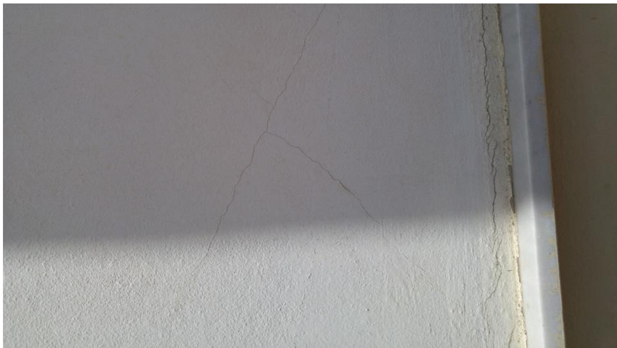
Εικόνα 4.4.8 Αριθμός 7: «Χιαστί» ρωγμή αριστερά της πλωτής διάροφης πολυκατοικίας στην οδό Δωδεκανήσου
