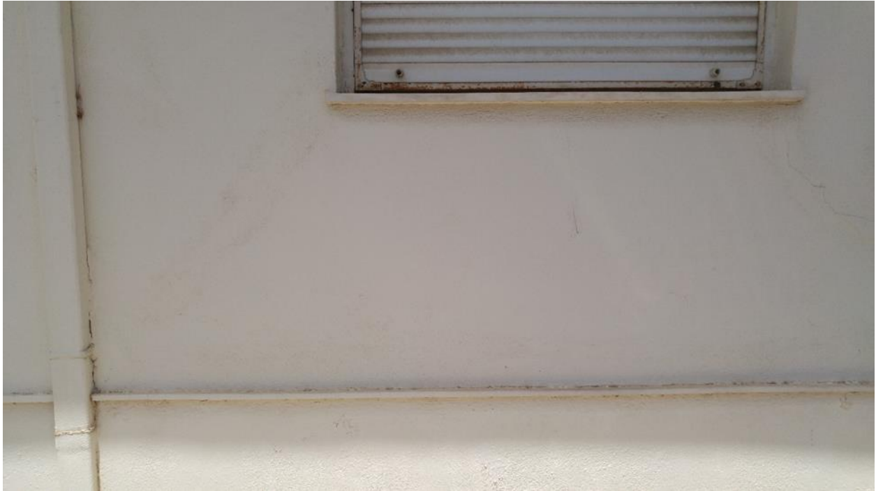
Εικόνα 4.4.34 Αριθμός 31:Ρωγμές γωνίας 45° εκατέρωθεν κουφώματος σε πλάγια όψη διάροφης κατασκευής στην οδό Αθηνογένους. Το φαινόμενο επικάλυψης των αστοχιών με επίχρισμα είναι αρκετά σύνηθες
