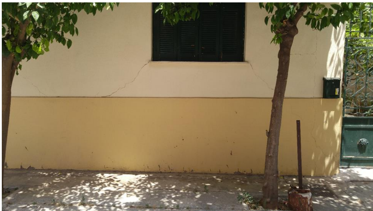
Εικόνα 4.4.90 Αριθμός 81: Ρωγμές γωνίας 45° σε τοιχοποιία εκατέρωθεν του κουφώματος κύριας όχλης σε μονοκατοικία της οδού Απολλωνίας
