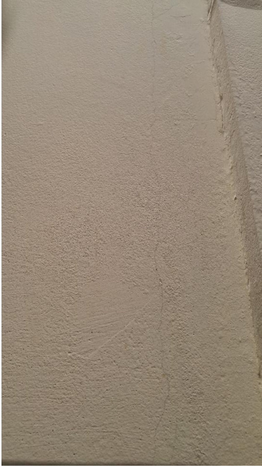
Εικόνα 4.4.10 Αριθμός 9: Κατακόρυφη ρωγμή στο αριστερό τμήμα μπροστινής όψης διώροφης πολυκατοικίας στην οδό Αγίου Ιεροθέου
