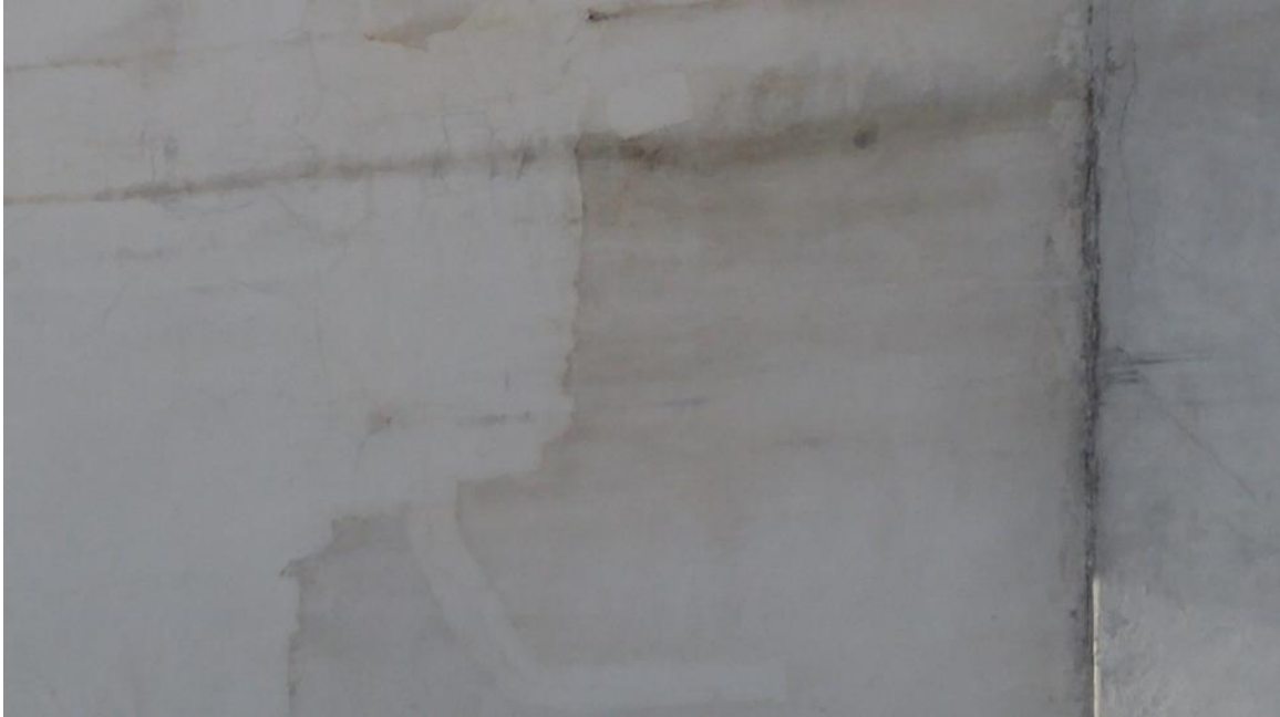
Εικόνα 4.4.2 Αριθμός 1: Τριχοειδής ρωγμή τοιχοποιίας διώροφης πολυκατοικίας στην οδό Αντιπάρου
