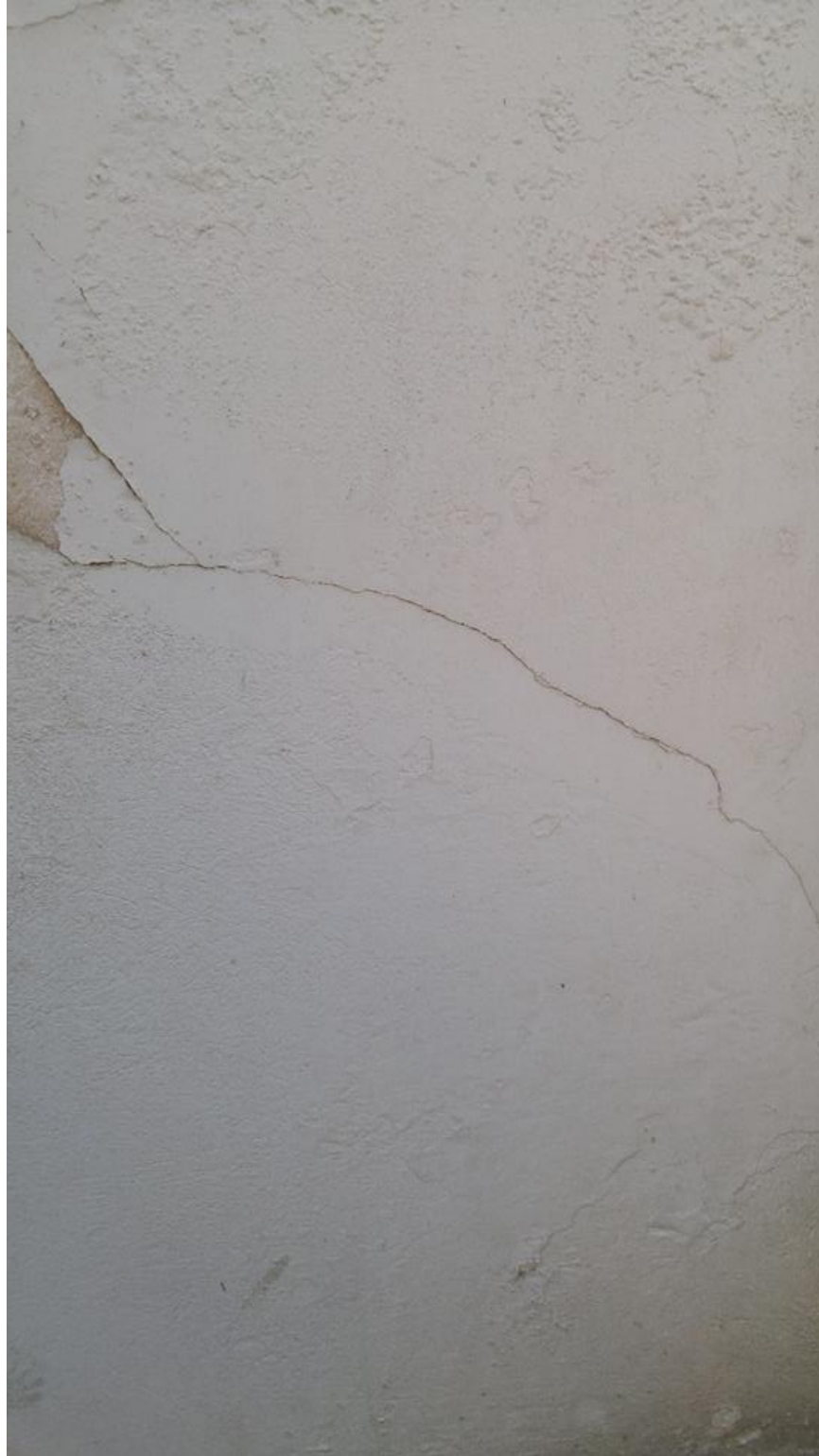
Εικόνα 4.4.79 Αριθμός 71: Ρωγμή γωνίας 45° στο επίχρισμα δεξιά του κουφώματος πλάγιας όψης στην οδό Αγίου Σωστή. Η ρωγμή παρατηρείται ότι βρίσκεται εντός της τοιχοποιίας του κτιρίου
