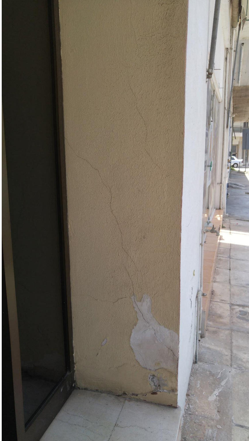
Εικόνα 4.4.31 Αριθμός 29: Ρωγμή 45° κολώνας κτιρίου με επέκταση στο πεζοδρόμιο στην οδό Αθηνογένους
