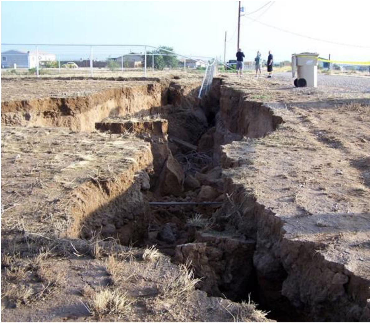
Εικόνα 1.3.2 Υποχώρηση εδάφους στην πόλη Queen Creek της Αριζόνα.
