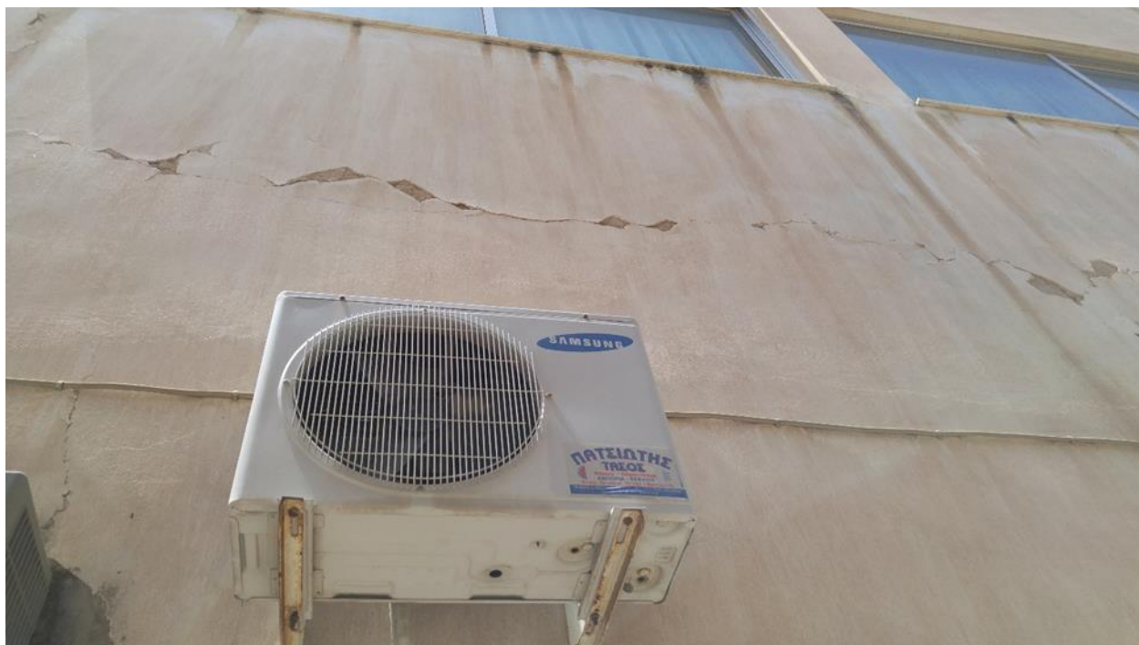
Εικόνα 4.4.36 Αριθμός 33: Εκτεταμένη οριζόντια ρωγμή κατά μήκος όλης της πλάγιας όψης κτιρίου στην οδό Αθηνογένους
