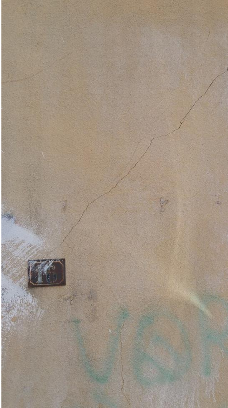
Εικόνα 4.4.4 Αριθμός 3: Ρωγή 45 μοιρών με διακλάδωση σε τοιχοποιία πολυκατοικίας στη διασταύρωση οδών Αντιπάρου και Δωδεκανήσου
