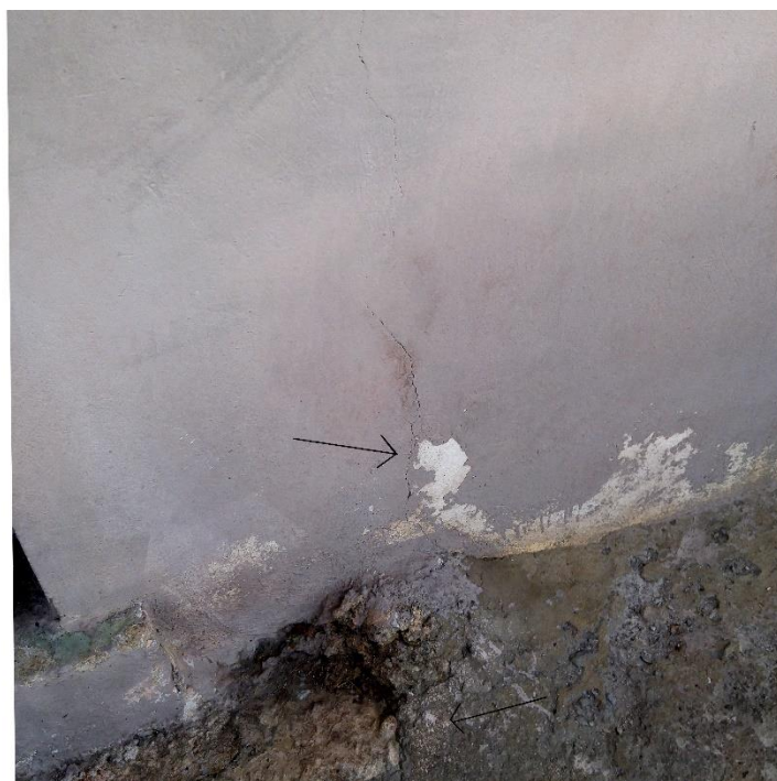
Εικόνα 4.4.20 Αριθμός 19: Ρωγή στη βάση πλάγιας όψης που επεκτείνεται σε αστοχία πεζοδρομίου στην οδό Αγίου Κηρύκου
