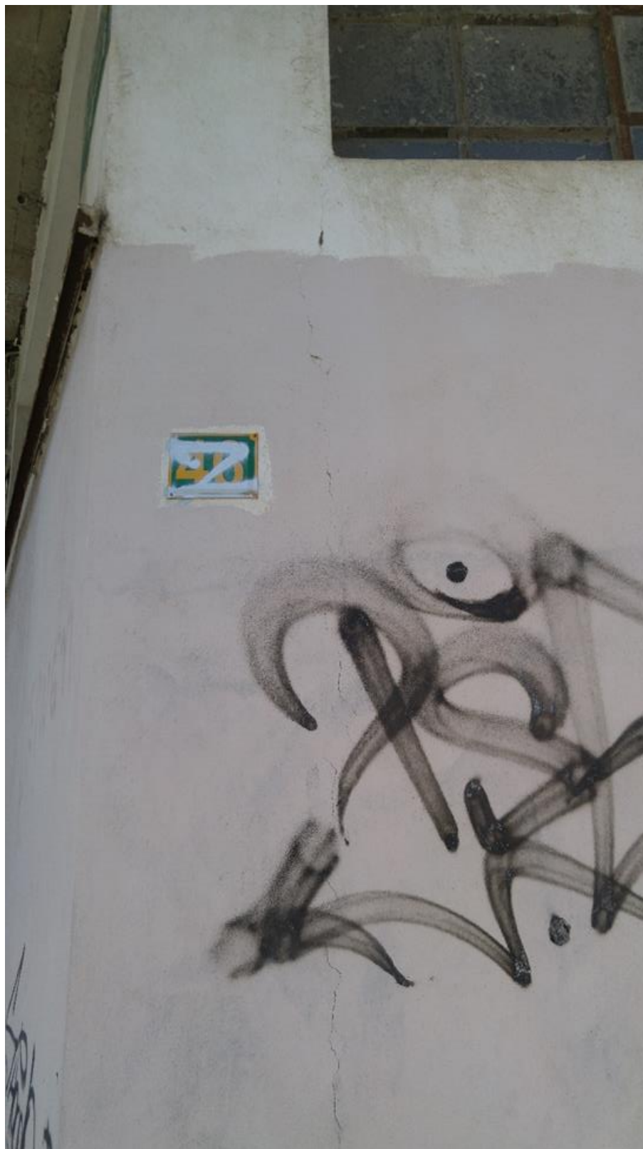
Εικόνα 4.4.30 Αριθμός 28: Ρωγμή 45° με κατακόρυφη επέκταση σε τοιχοποιία πλάγιας όψης στην οδό Αγίου Ιεροθέου
