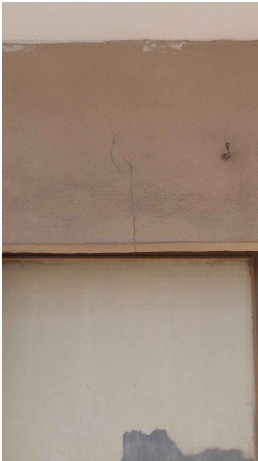
Εικόνα 4.4.81 : Αριθμός 73: Κατακόρυφη ρωγμή σε δοκό κύριας όψης κατοικίας στην οδό Ανδριταίνης
