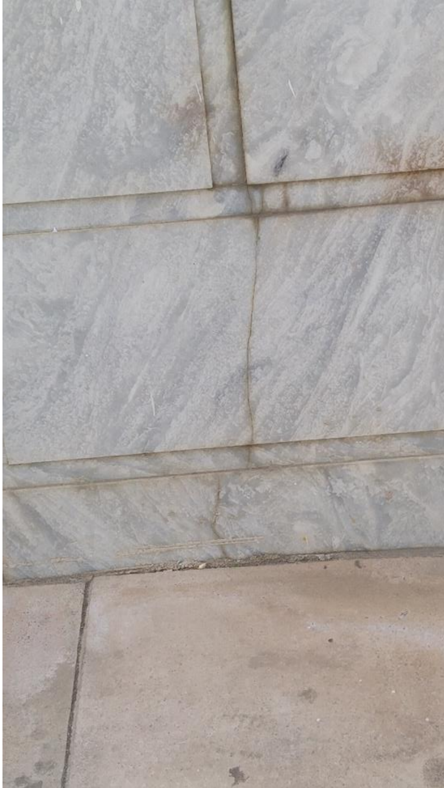
Εικόνα 4.4.83 Αριθμός 75: Διαγώνια ρωγή σε ορθομαρμάρωση κύριας όψης διώροφου κτιρίου της οδού Αστακού
