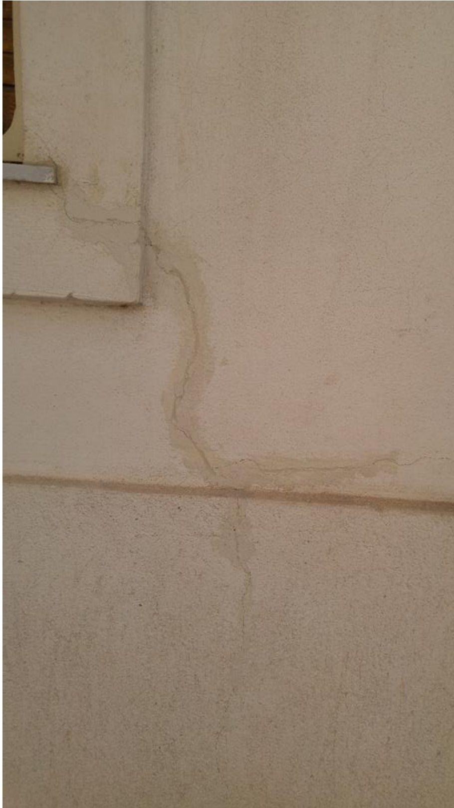
Εικόνα 4.4.68 Αριθμός 61: Ρωγμή στο κάτω δεξιό τμήμα κουφώματος σε τοιχοποιία δυτικής όψης κατοικίας της οδού Αθηνογένους, με επέκταση στην επένδυση άοπλου σκυροδέματος
