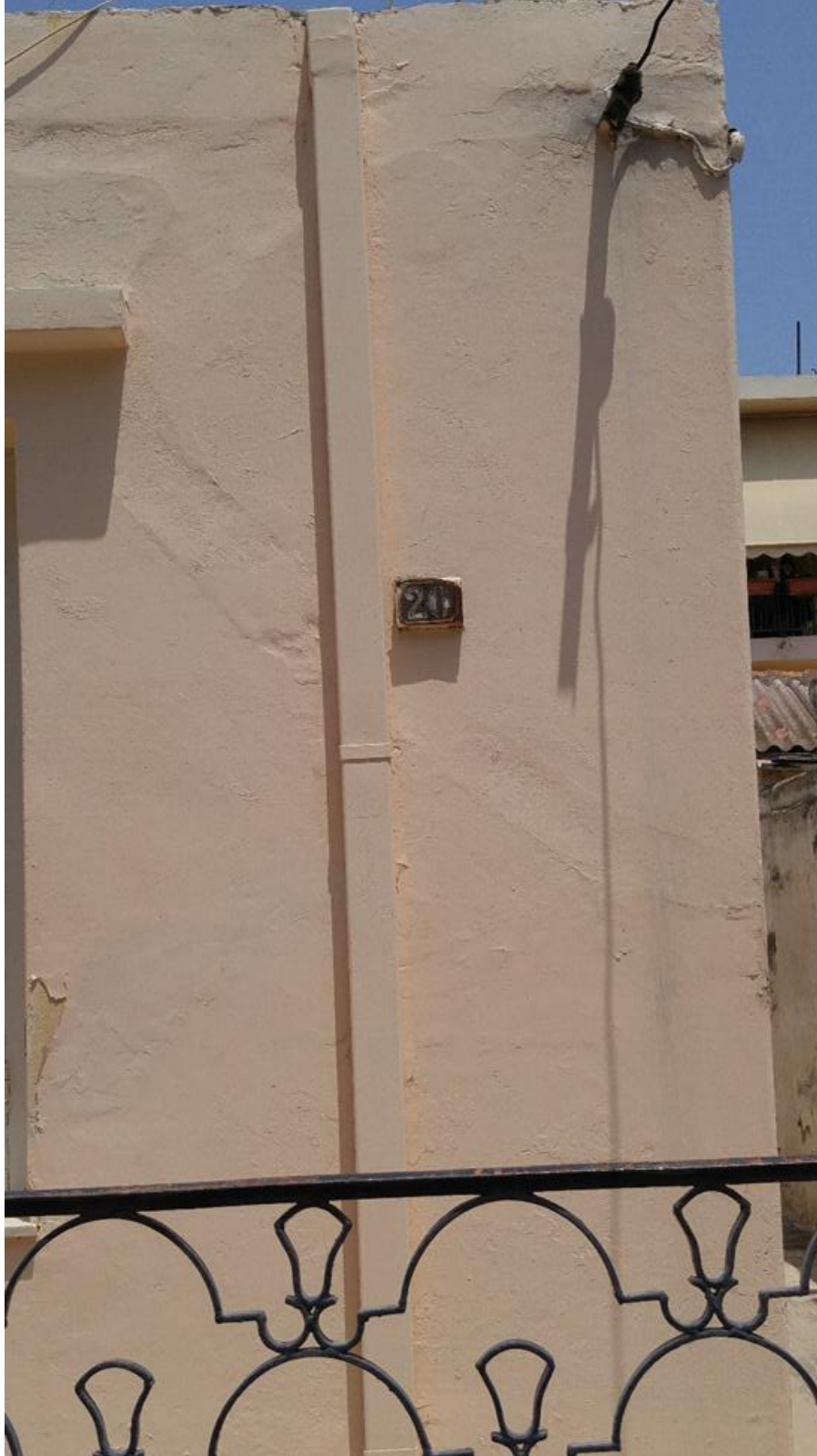
Εικόνα 4.4.85 Αριθμός 77: Επισκευασμένη ραγισμένη γωνιάς 45° στο δεξιό τμήμα φέρουσας τοιχοποιίας κύριας όψης μονοκατοικίας στην οδό Αζανίας
