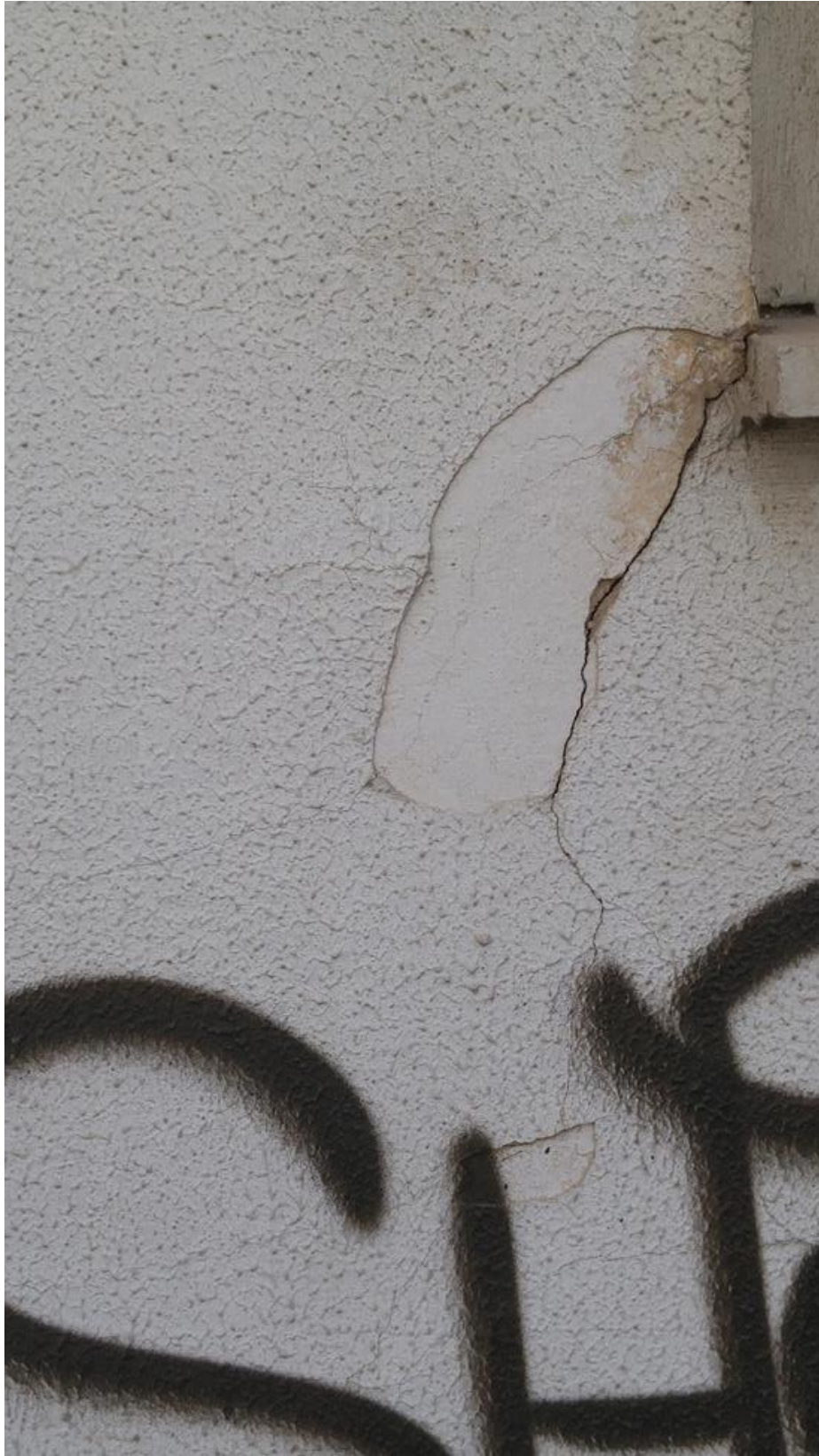
Εικόνα 4.4.13 Αριθμός 11: Τριχοειδής ρωγή στα αριστερά κουφώματος πολυκατοικίας στην οδό Καρκαβίτσα
