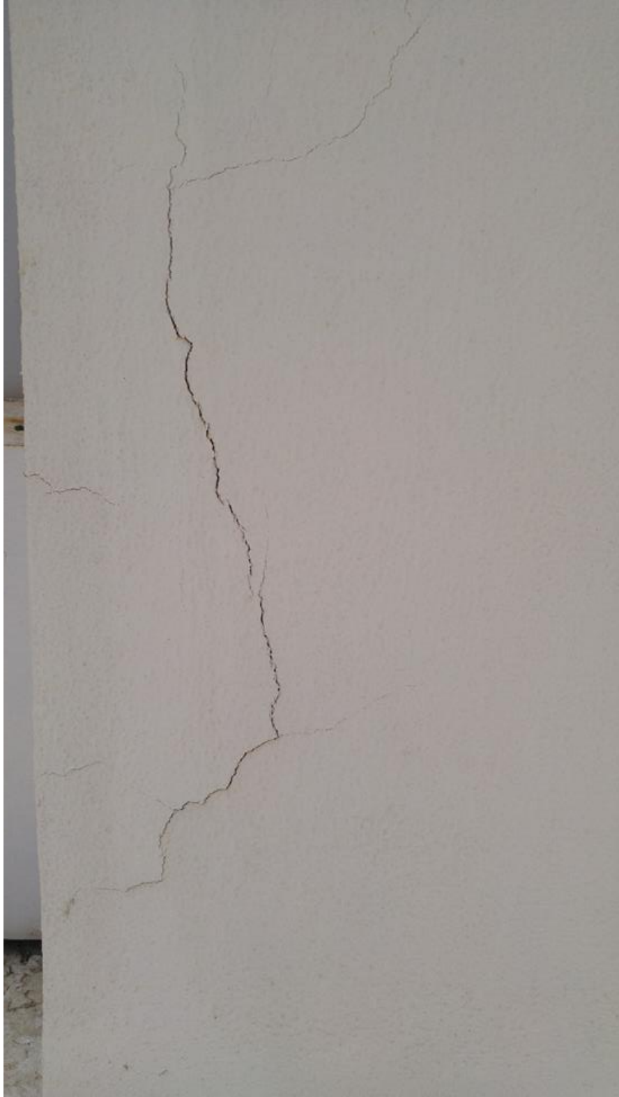
Εικόνα 4.4.35 Αριθμός 32: Διευρυνόμενη τριχωειδής ρωγμή κολώνας σε διώροφη πολυκατοικία στην οδό Αθηνογένους
