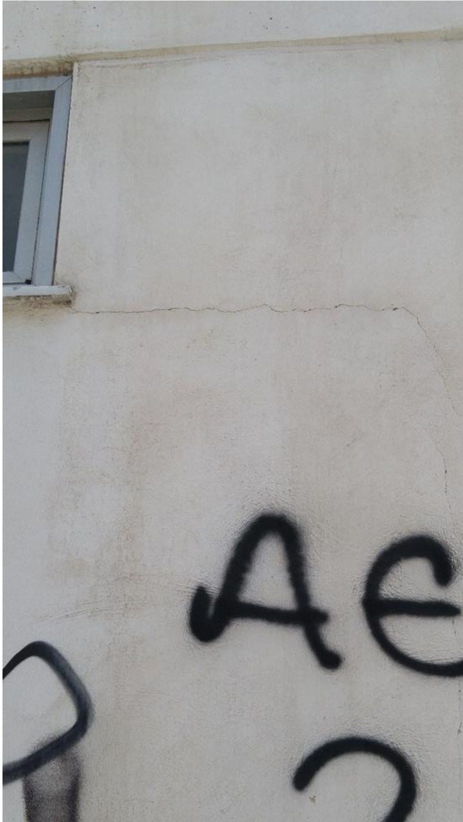
Εικόνα 4.4.82 : Αριθμός 74: Ρωγμή στο κάτω μέρος κονφάματος σε τοιχοποιία πλάγιας όψης κατοικίας στην οδό Αμφιπόλεως
