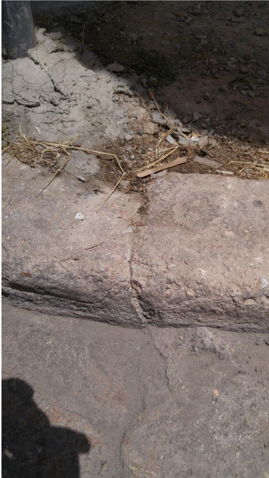
Εικόνα 4.4.29 Αριθμός 27: Αστοχία κρασπέδου στην οδό Αγίου Κηρύκου με επέκταση στο οδόστρωμα
