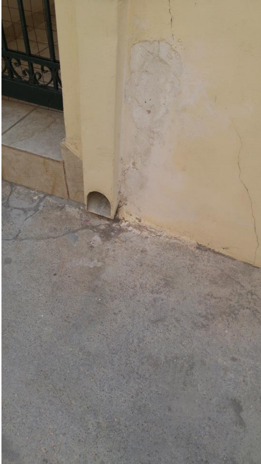
Εικόνα 4.4.46 Αριθμός 42: Ρωγμή γωνίας 45° στην τοιχοποιία κύριας όψης πολυκατοικίας με επέκταση στο πεζοδρόμιο της οδού Αγρινίου
