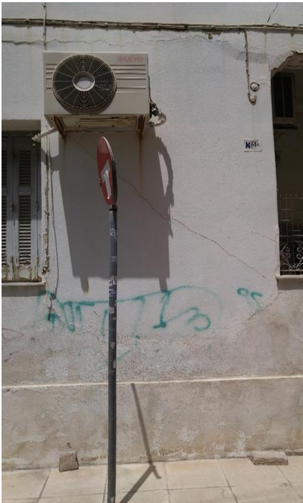
Εικόνα 4.4.41 Αριθμός 38:Εκτεταμένη ρωγμή γωνίας 45° στην νότια όψη μονοκατοικίας στην οδό Αγρινίου
