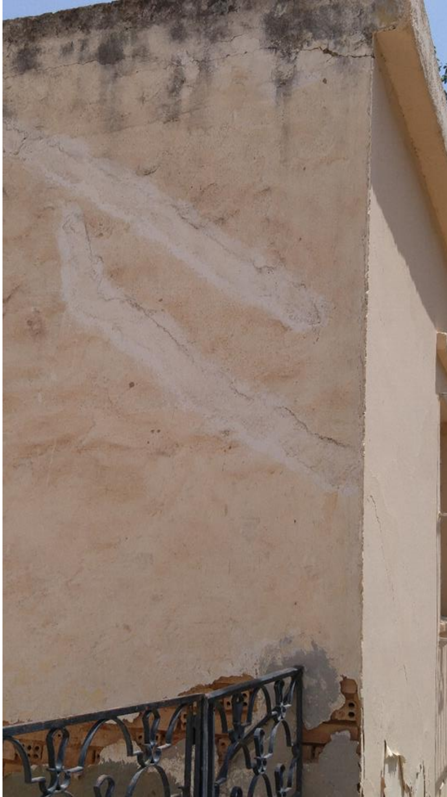
Εικόνα 4.4.86 Αριθμός 78: Επισκευές ρωγμών γωνίας 45° σε φέρουσα τοιχοποιία πλάγιας όψης μονοκατοικίας στην οδό Αμφιπόλεως (Ίδια οικία με την εικόνα 4.3.84)
