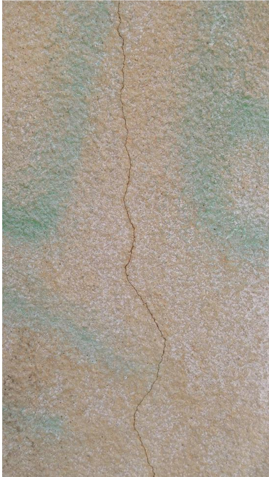
Εικόνα 4.4.5 Αριθμός 4: Λεπτομέρεια κάτω μέρους ρωγμής τοιχοποιίας (Ίδια οικία με αριθμό 3)
