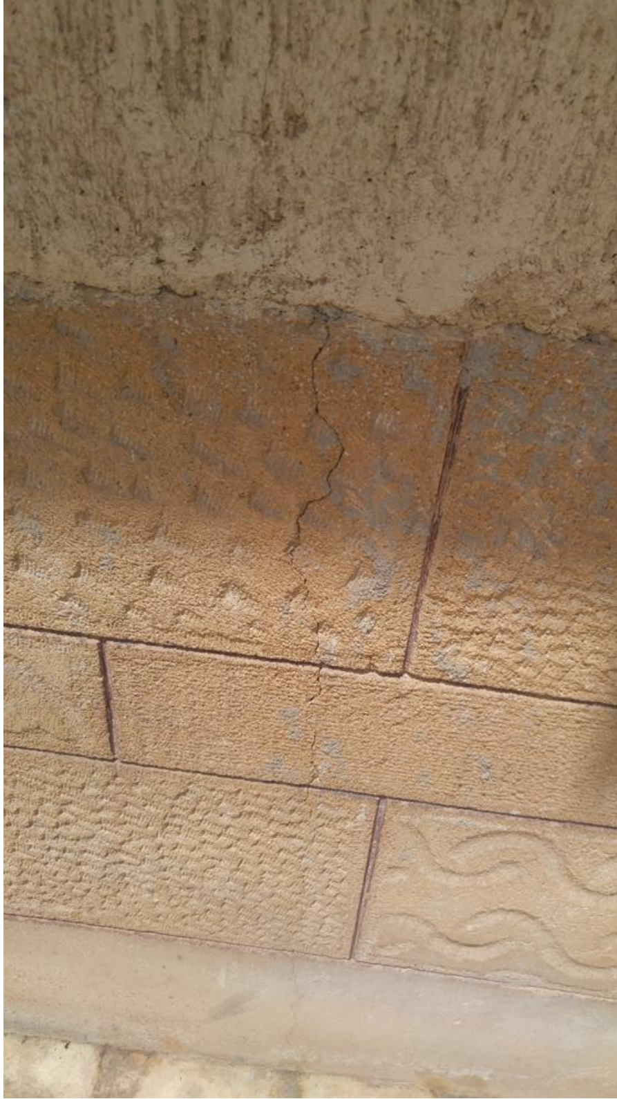
Εικόνα 4.4.56 Αριθμός 51: Αστοχία πέτρινης επένδυσης στη βόρεια όψη πολυκατοικίας στην οδό Αροανίας με παρουσία κατακόρυφης ρωγμής
