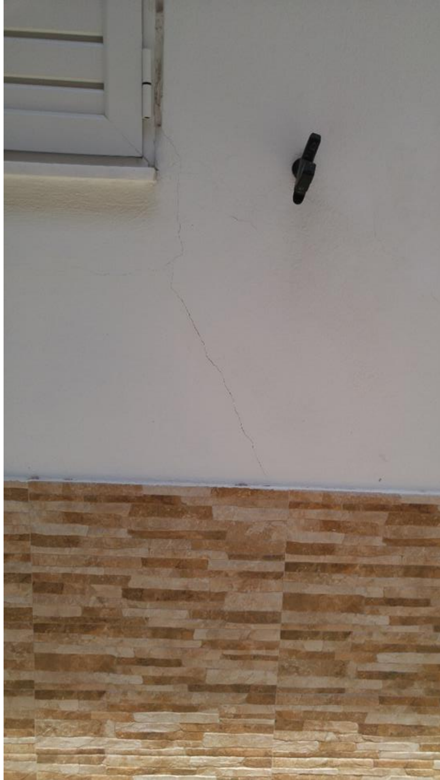
Εικόνα 4.4.101 Αριθμός 91: Ρωγμή γωνίας 45° σε τοιχοποιία δεξιά του κουφώματος κύριας όψης στην οδό Αγρινίου
