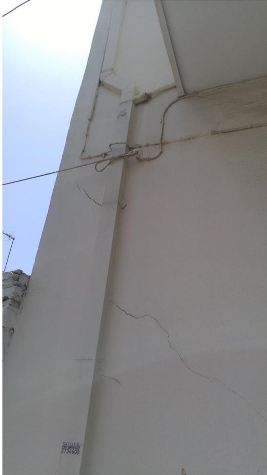
Εικόνα 4.4.50 Αριθμός 46: Ρωγμές γωνίας 45° εκατέρωθεν και κατά μήκος της υδρορροής στο αριστερό τμήμα δυτικής πλευράς διώροφης πολυκατοικίας στην οδό Αγίας Μαρίνας
