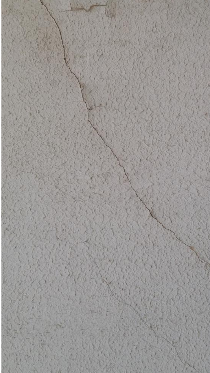
Εικόνα 4.4.14 Αριθμός 12, οδός Καρκαβίτσα: Ρωγμή 45° σε τοιχοποιία κύριας όψης μονοκατοικίας στην οδό Καρκαβίτσα
