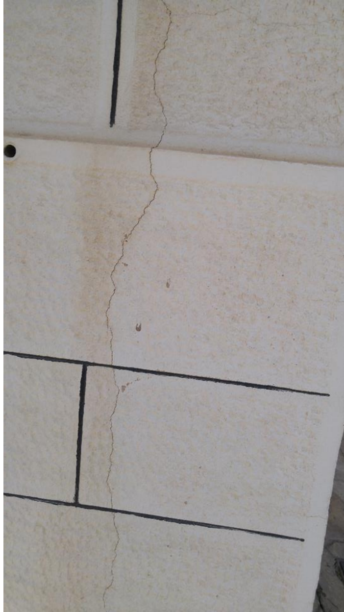
Εικόνα 4.4.28 Αριθμός 26: Εκτεταμένες ρωγμές στο δεξιό τμήμα της κατασκευής των εικόνων 4.4.26 - 27 με επέκταση στην επικάλυψη της τοιχοποιίας στην οδό Αγίου Κηρύκου
