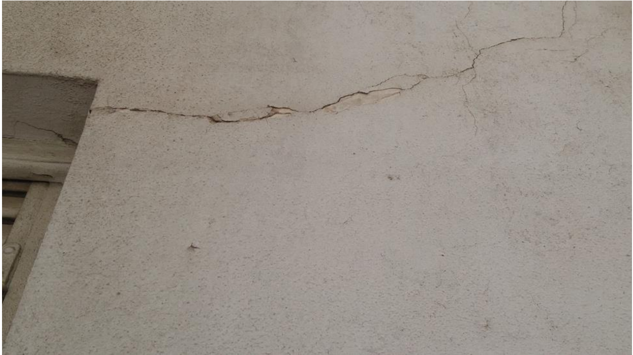
Εικόνα 4.4.15 Αριθμός 13: Ρωγμή στο άνω μέρος κουφώματος σε μονοκατοικία στην οδό Καρκαβίτσα
