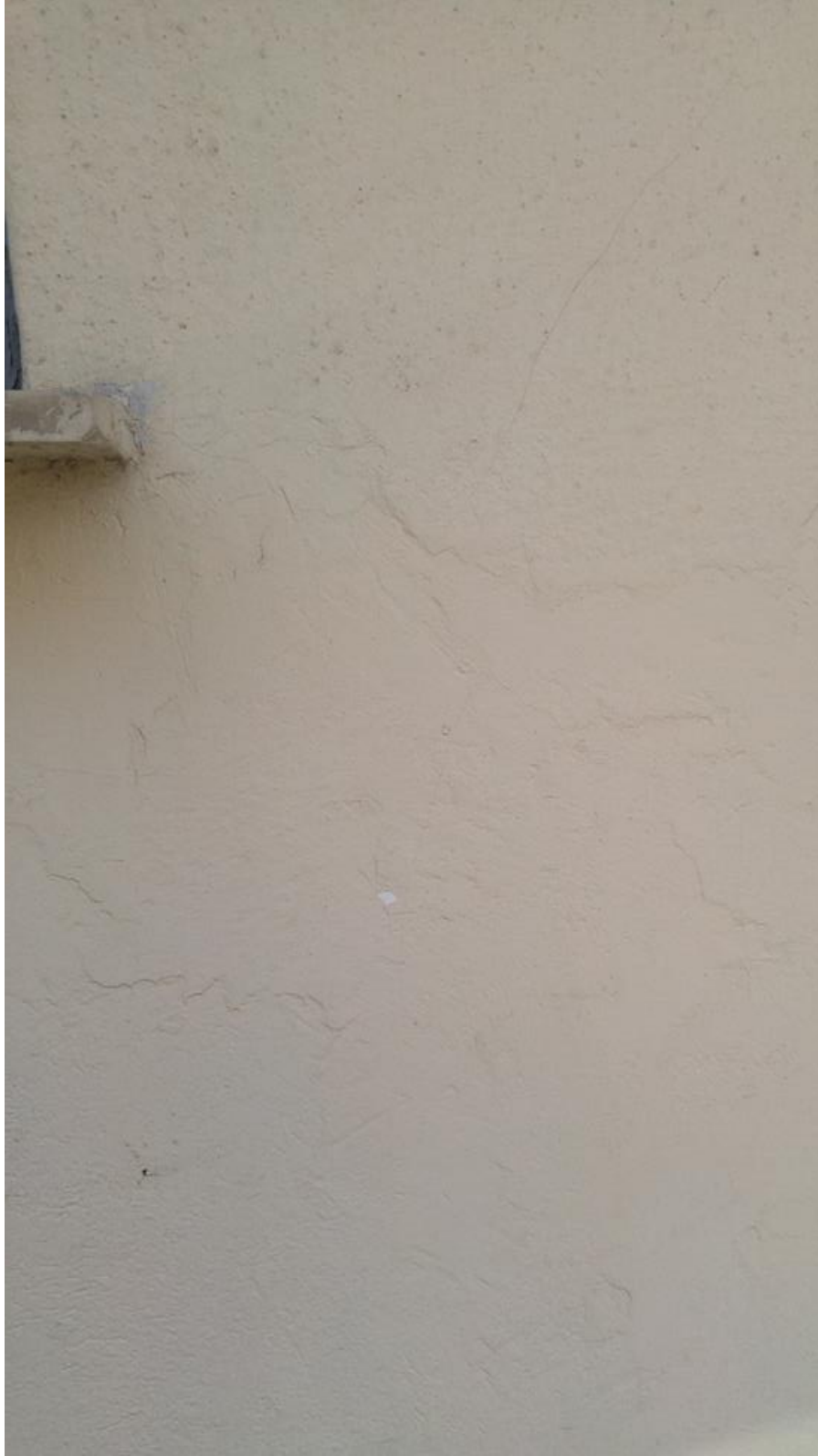
Εικόνα 4.4.92 Αριθμός 83: Επισκευασμένη ρωγμή γωνίας 45° σε τοιχοποιία κύριας όψης διάρροφης κατοικίας στην οδό Θηβών
