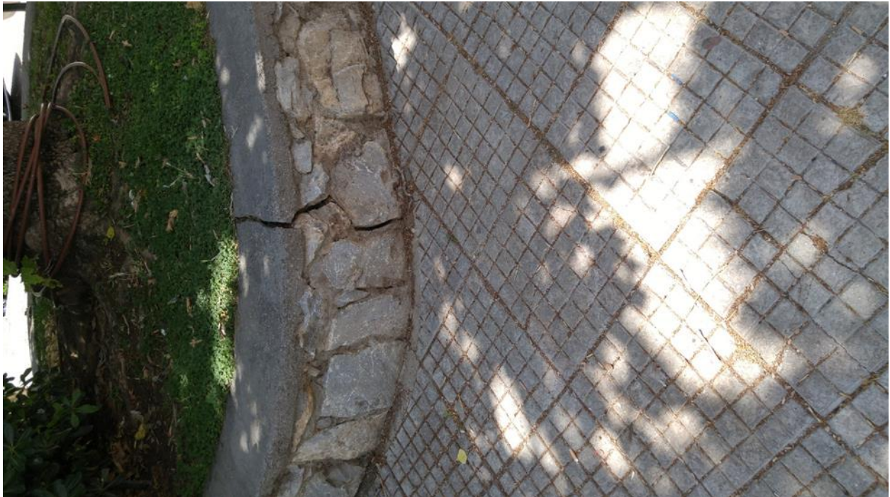
Εικόνα 4.4.96 : Αριθμός 87: Ρωγμή του πέτρινου τοιχίου των παραπάνω εικόνων στην οδό Αορανίας
