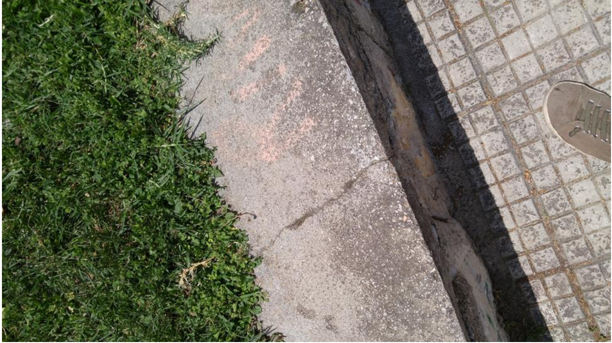
Εικόνα 4.4.95 Αριθμός 85: Αστοχία του τοιχίου της εικόνας 4.3.93 σε διαφορετικό σημείο
