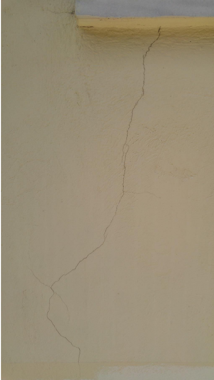
Εικόνα 4.4.53 Αριθμός 49: Κατακόρυφη τριχοειδής ρωγμή στο αριστερό κάτω τμήμα κουφώματος δυτικής όψης τριώροφης πολυκατοικίας στην οδό Αμαλιάδος
