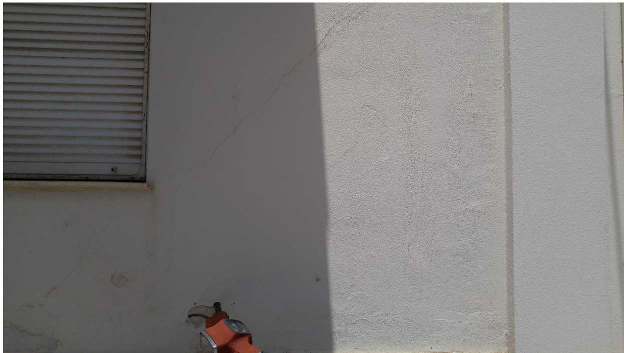
Εικόνα 4.4.32 Αριθμός 30: Ρωγμή σε γωνία 45° σε τοιχοποιία κατά μήκος όλης της κύριας όψης της κατασκευής στην οδό Αθηνογένους
