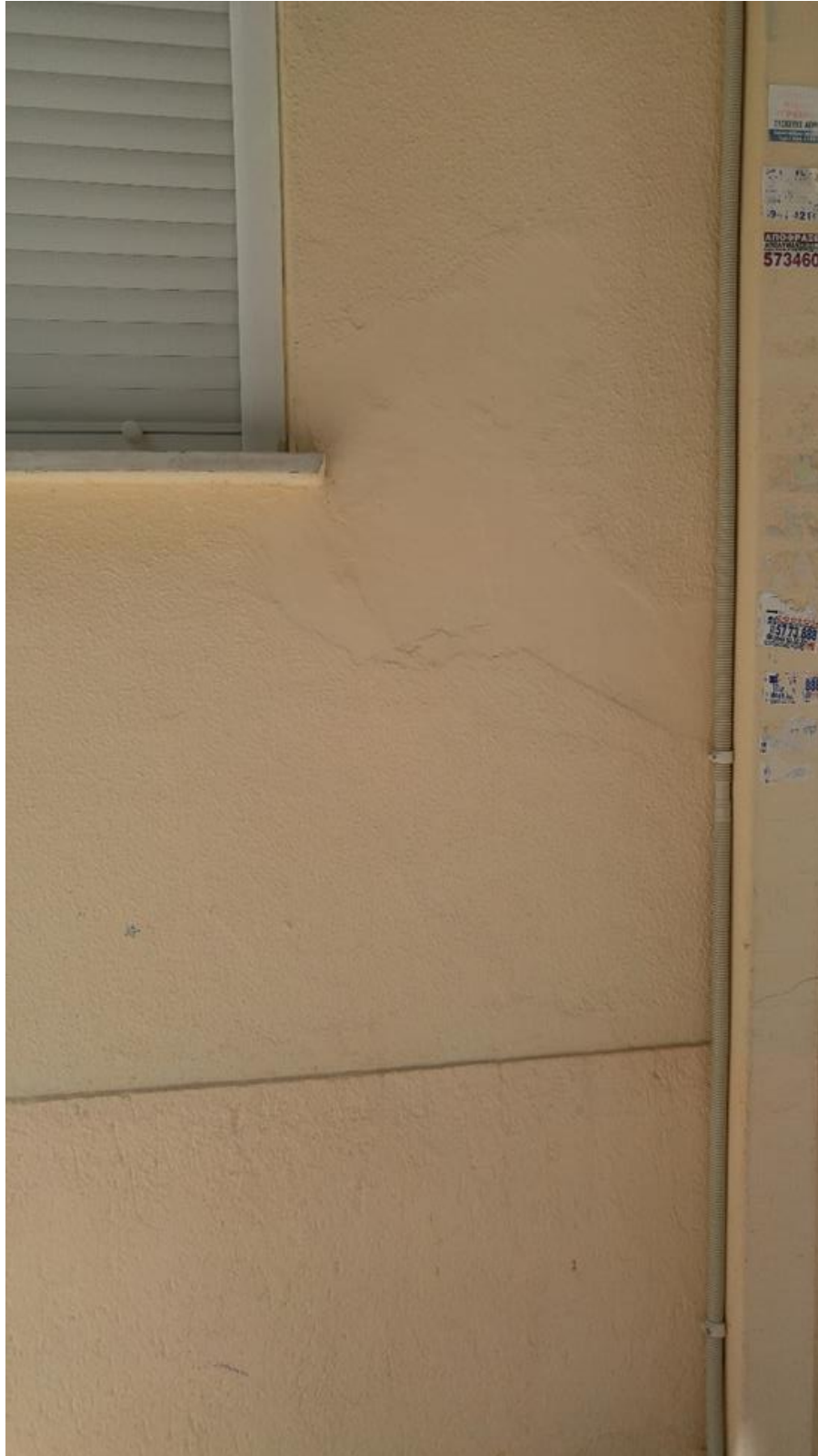
Εικόνα 4.4.71 Αριθμός 64: Ρωγμή γωνίας 45° τοιχοποιίας, στο κάτω δεξιό τμήμα κουφώματος της νότιας όψης κατοικίας της οδού Αγίας Μαρίνας
