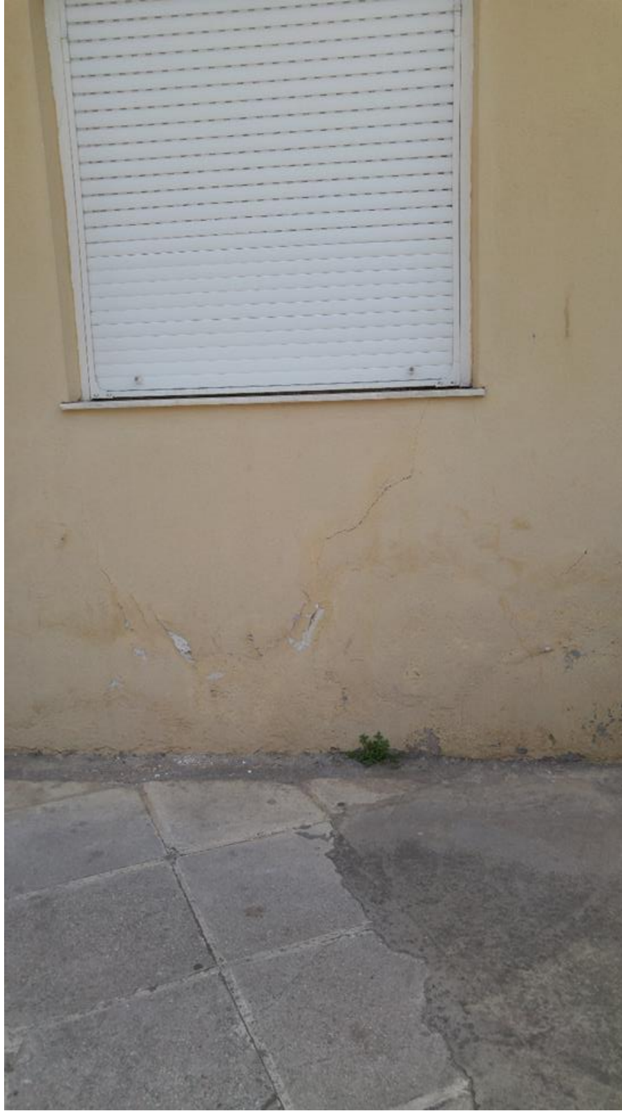
Εικόνα 4.4.52 Αριθμός 48: Εκτεταμένες ρωγμές σε τοιχοποιία κτιριακής κατασκευής με αφετηρία το κούφωμα της νότιας όψης και επέκταση του φαινομένου στο πεζοδρόμιο της οδού Πάριδος
