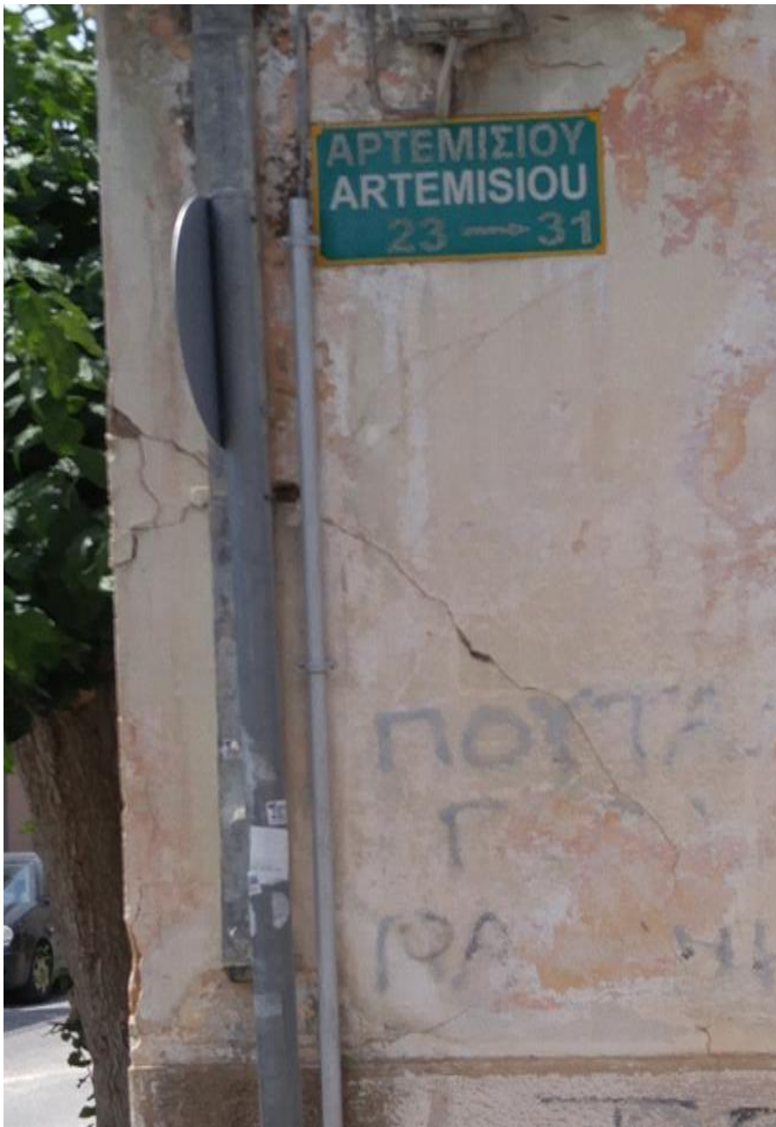
Εικόνα 4.4.103 Αριθμός 93: Λεπτομέρεια τριχοειδούς ρωγμής στη γωνία φέρουσας τοιχοποιίας της εικόνας 4.3.102
