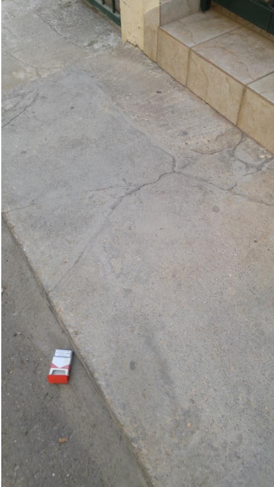
Εικόνα 4.4.45 Αριθμός 41: Εκτεταμένες αστοχίες σε πλάκα πεζοδρομίου στην οδό Αγρινίου
