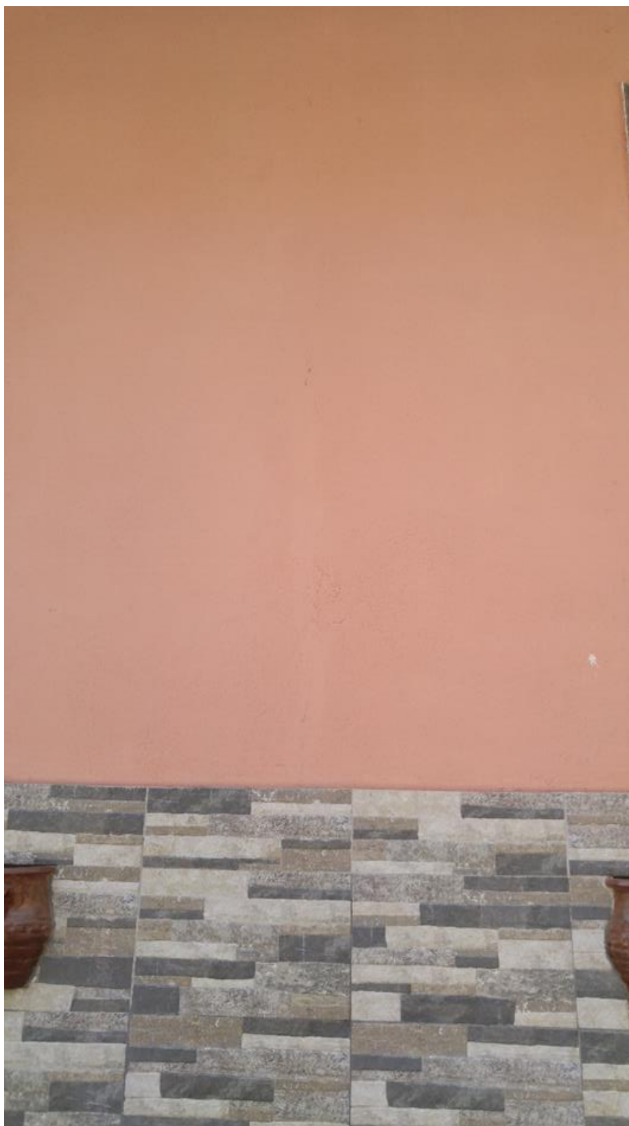
Εικόνα 4.4.40 Αριθμός 37: Κατακόρυφη ρωγμή σε τοιχοποιία πλάγιας όψης κατασκευής στην οδό Αορανίας
