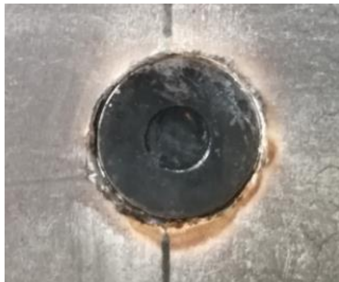
Σχήμα 4.10 Ο μετρητής ροής θερμότητας τοποθετημένος πάνω στην πρόσοψη
