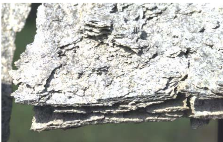
Εικόνα 1.15 διάβρωση εξάνθησης αλουμινίου
