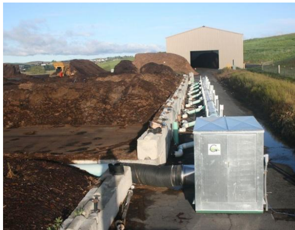
Εικόνα 2.2.3 Σύστημα αεριζόμενων στατικών σωρών
