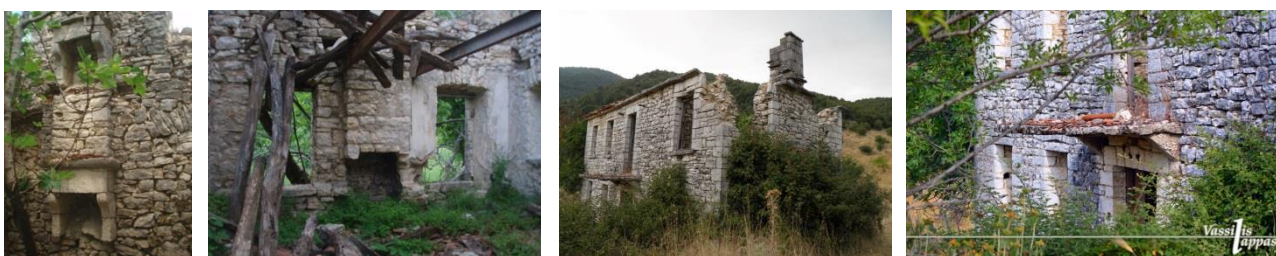
Εικόνα 4.87 - 4.90. Διπλή εστία, εσοχές στην τοιχοποιία που μαρτυρούν την πάκτωση ξύλινων δοκαριών για διαμόρφωση πατώματος και μεταλλικά δοκάρια (Ιδία λήψη) — ο βορειοανατολικός τοίχος με προεξοχή στην εξωτερική παρειά του στο σημείο των εστιών και στέγαστρο (Πηγή: http://www.facebook.com - Φωτογραφική λήψη του Πουλίζου Χριστόφορου) — εξώστης (Πηγή: http://klgallery.gr - Φωτογραφική λήψη του Λάππα Βασίλη)
