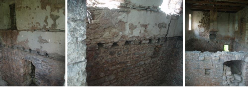
Εικόνα 4.70 - 4.72. Εσοχές στην τοιχοποιία που υποδηλώνουν την ύπαρξη ξύλινου πατώματος (Ιδία λήψη)
