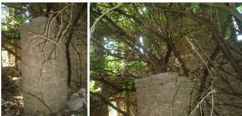
Εικόνα 4.162 - 4.163. Εσωτερικό λίθινο υποστύλωμα και εσοχές στην τοιχοποιία μαρτυρούν το σύστημα διαμόρφωσης του πατώματος (Ιδία λήψη)
