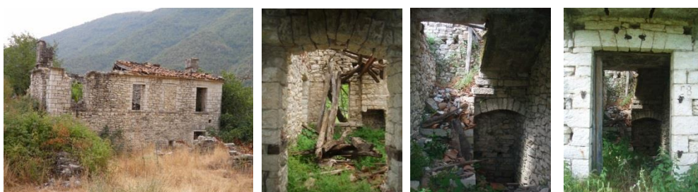
Εικόνα 4.83 - 4.86. Ξύλινο σύστημα στέγης και μπαγδατί εσωτερικά του κτηρίου στο ανώι (Πηγή: http://www.facebook.com - Φωτογραφική λήψη του Πουλίζου Χριστόφορου) — εσωτερικός λίθινος τοίχος στο κατώι (Ιδία λήψη) — εσωτερική κλίμακα (Ιδία λήψη) — τζινέτια (Ιδία λήψη)
