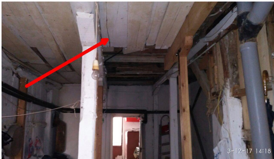
Εικόνα 2.14 Ένα από τα σοβαρότερα προβλήματα της κατοικίας είναι η φθορά και η διάβρωση των δοκίδων στήριξης του ορόφου
