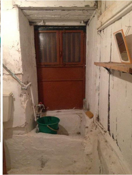
Εικόνα 2.16 Άναρχη διάταξη των χώρων στο ισόγειο (το παράθυρο του WC του ισόγειου καταλήγει στην κύρια όψη του κτιρίου)
