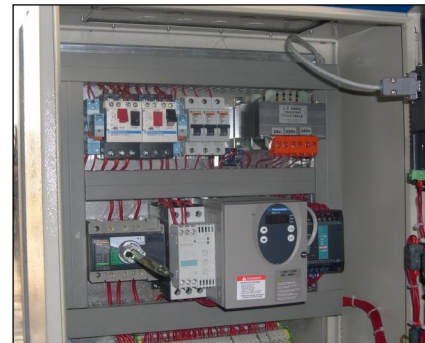
Εικόνα 5.8: Ηλεκτρολογικός πίνακας συστήματος αυτομάτου ελέγχου και παρακολούθησης
