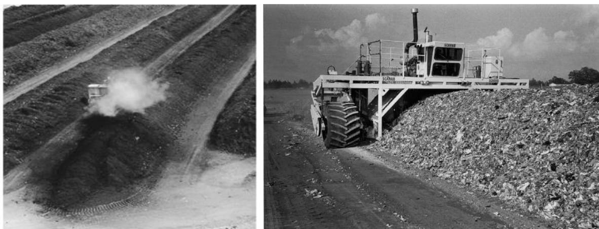
Εικόνα 3.13: Τυπική διάταξη οριζόντιου ανοικτού συστήματος κομποστοποίησης, τύπου αναστρεφόμενων σειραδιών (Diaz et al., 2002)
