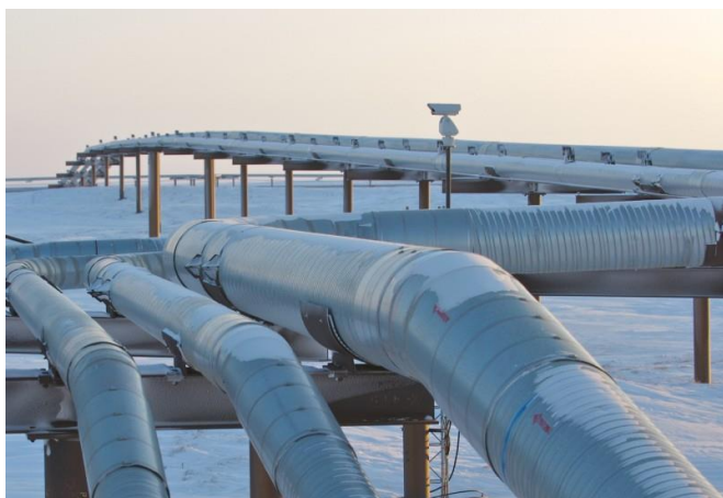
Εικόνα 7 Αγωγοί Φυσικού Αερίου
