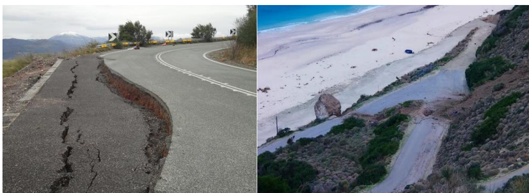
Εικόνα 2 Καθίζηση λόγω Βροχόπτωσης στο δήμο Μεγαλόπολης (πηγή: iefimerida.gr )
