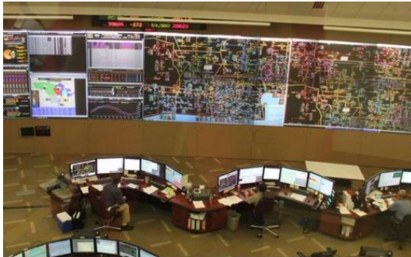
Εικόνα 5.4 Σύγχρονη αίθουσα ελέγχου με Ψηφιακές Οθόνες Τοίχου (πηγή: www.usatoday.com )
