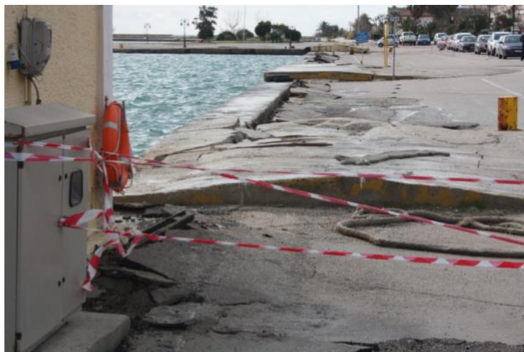
Σχήμα Β.4: Αστοχίες δυτικού κρηπιδώματος χερσαίας ζώνης (τμήμα ΒΔ) και 1 η ράμπα (τμήμα Ι – Κ).
