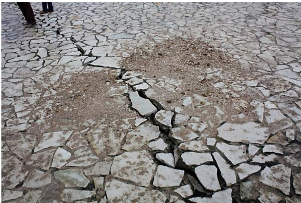
Σχήμα 3.8 (ε) : Ενδείξεις πιθανής ρευστοποίησης σε διάφορα σημεία εντός της λιμενικής ζώνης.
