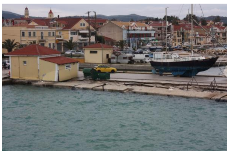
Σχήμα Β.3: Αστοχίες στο βόρειο υπήνεμο μόλο – νότιο εσωτερικό κρηπίδωμα (τμήμα Θ – Ι).
