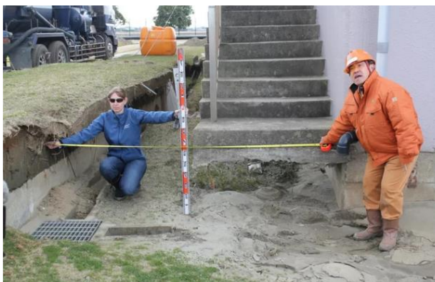
Σχήμα 1.15: Εμφάνιση καθιζήσεων μετά από ρευστοποίηση του εδάφους στην Ιαπωνία.
