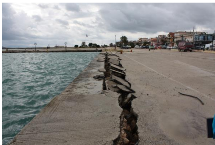
Σχήμα Β.5: Αστοχίες δυτικού κρηπιδώματος χερσαίας ζώνης (τμήμα ΒΔ) και 3 η ράμπα (τμήμα Λ – Μ).
