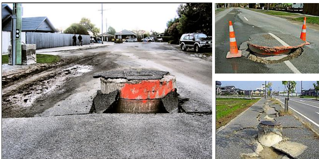
Σχήμα 1.19: Οι υπόγειες κατασκευές με φαινόμενο ειδικό βάρος μικρότερο από την άνωση παρουσιάζουν σημαντικές μετακινήσεις ίσως ακόμη και να «ξεθαφτούν» εξαιτίας της ρευστοποίησης στον σεισμό στο Canterbury (2010).
