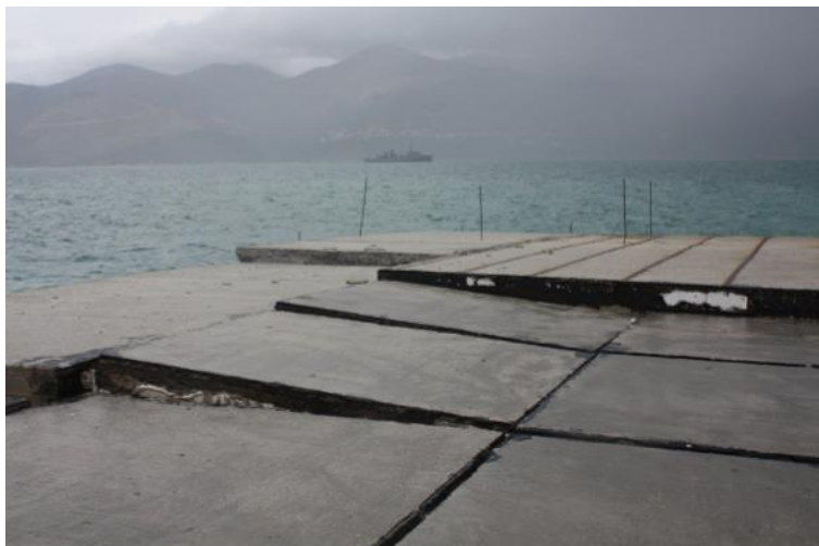
Σχήμα Β.1: Αστοχίες στο βόρειο υπήνεμο μόλο – ακρομώλιο (τμήμα Β – Γ – Δ ).
