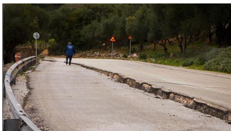
Σχήμα 3.4 (συνέχεια): Ενδεικτικές αστοχίες λόγω κατολισθήσεων στο οδικό δίκτυο της Κεφαλονιάς εξαιτίας των σεισμών στις 26 Ιανουαρίου και στις 3 Φεβρουαρίου του 2014.
