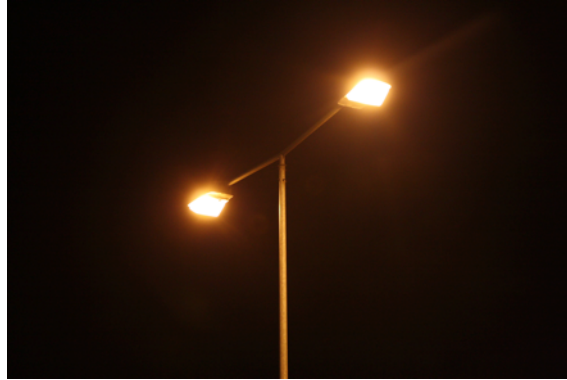
Εικόνα 5.2: Ιστός 12 μέτρων με δύο φωτιστικά σώματα HPS των 400 W.
