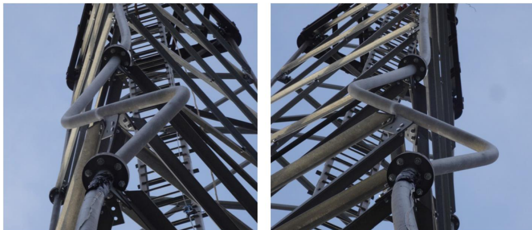
Σχήμα 4.3: Παραμορφωμένο υποστυλωμα κυκλικής διατομής [Szafran, 2015]
