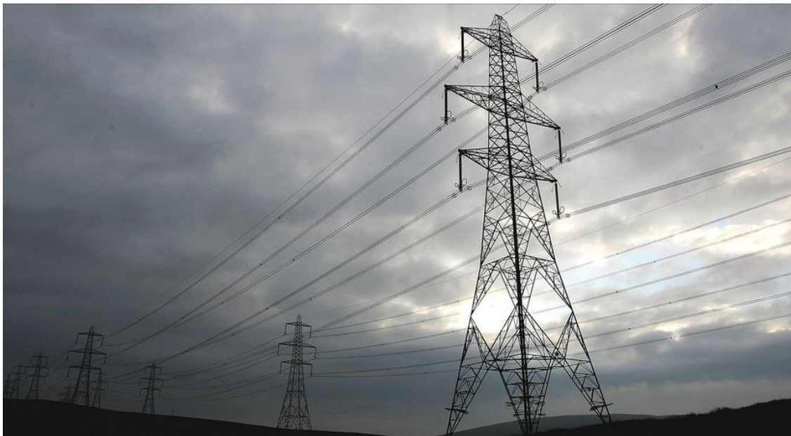
Σχήμα 1.1: Δικτυωτοί πυλώνες μεταφοράς ηλεκτρικής ενέργειας
