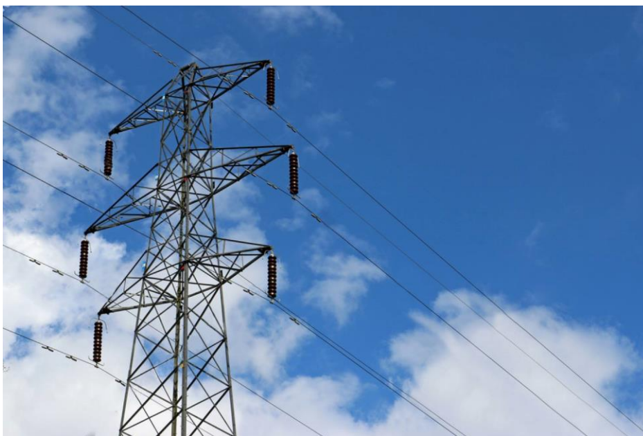
Σχήμα 6.1: Πυλώνας μεταφοράς ηλεκτρικής ενέργειας
