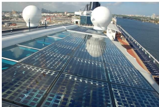
Εικόνα 3.24::Φωτοβολταϊκή εγκατάσταση σε κρουαζιερόπλοιο
