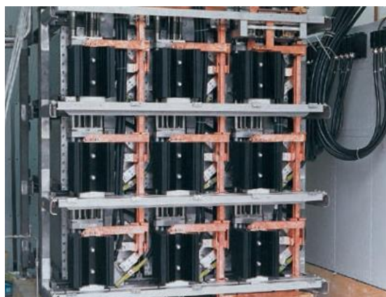
Εικόνα4.10: Εγκατάσταση FCM34, Siemens 2015
