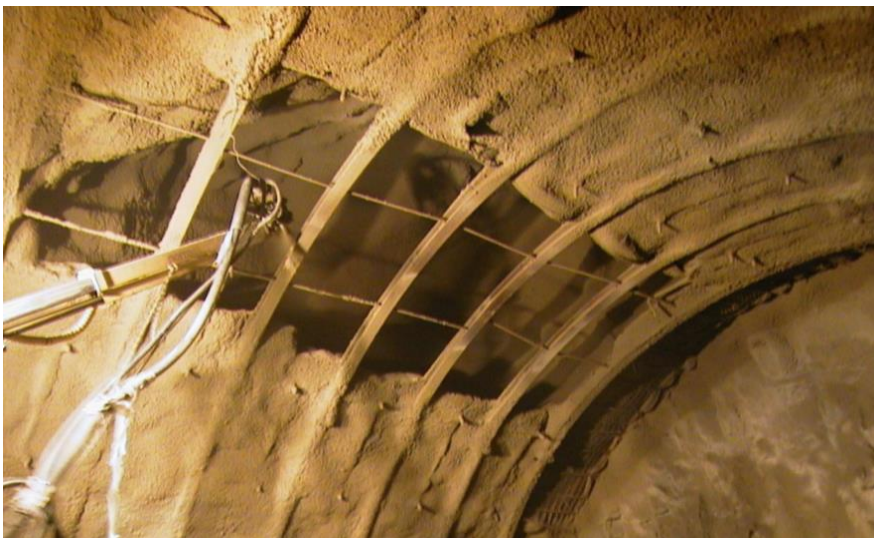
Εικόνα 2.3: Κατάπτωση τύπου καμινάδας στη σήραγγα Σ10 της Εγνατίας Οδού
