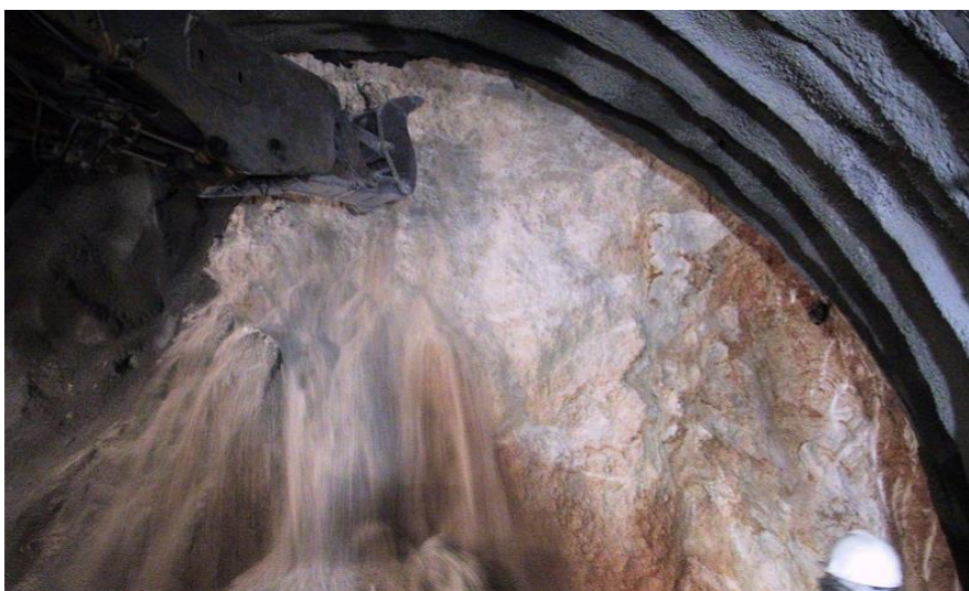
Εικόνα 2.4: Καταρροή βραχώμαζας στη σήραγγα Σ1 στην περιοχή Παραμυθίας
